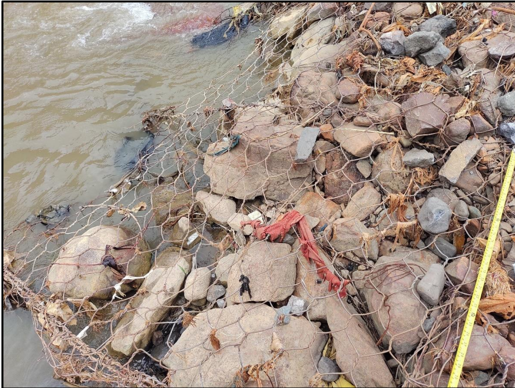
Fotografía 8: Rotura de malla del colchón de reno.
