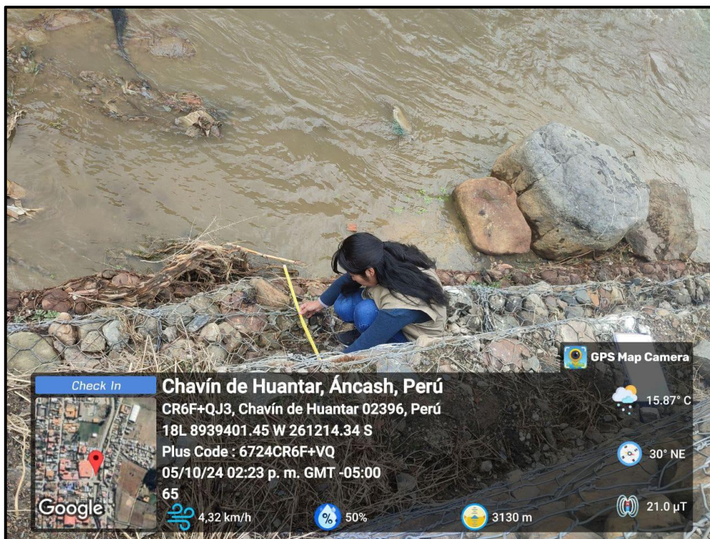
Fotografía 6: Deformación del ancho del primer nivel del muro de gavión en la margen izquierda del río Mosna.
