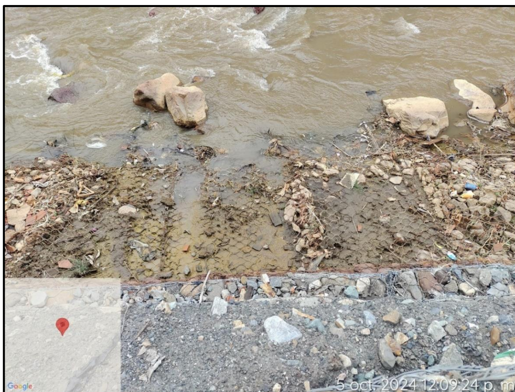
Fotografía 7: El Colchón de reno de la margen izquierda del Río Mosna.
