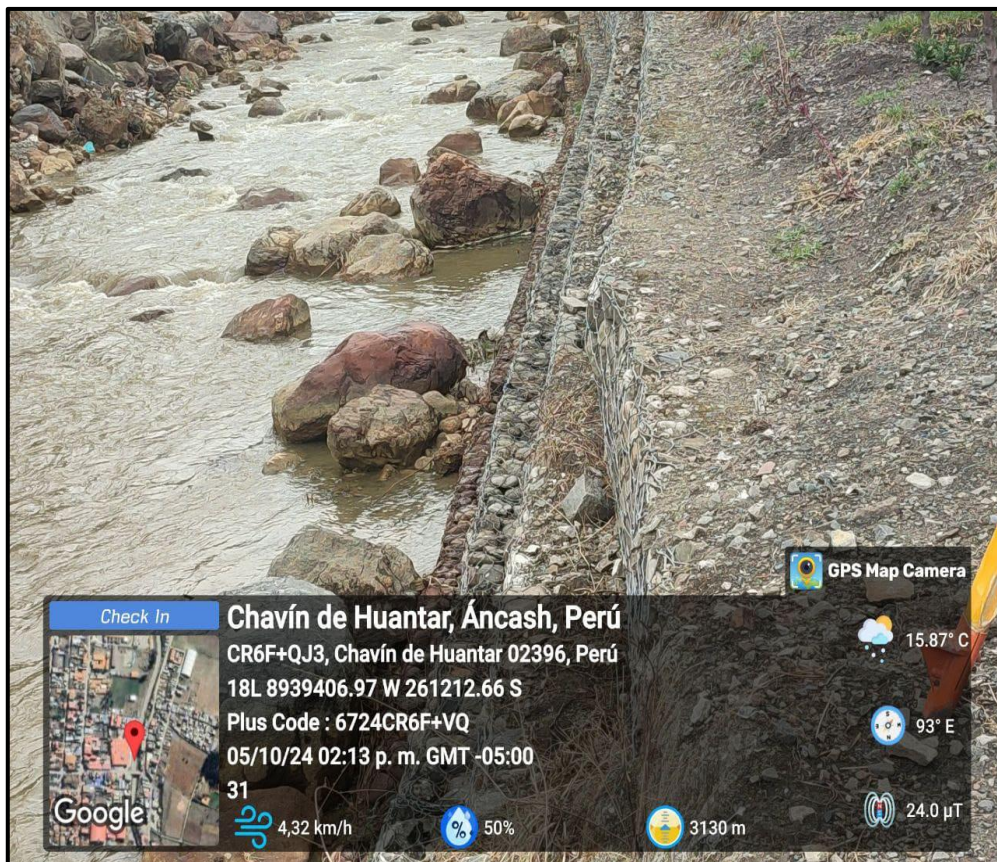
Fotografía 5: Deformación del ancho del muro de gavión en la margen izquierda del río Mosna.
