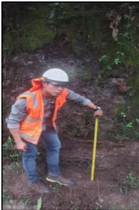
Figura 26: Progresiva 0+1100 a 0+1200 la base del muro ha sufrido deformaciones, además de ruptura de malla.
