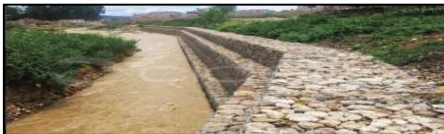
Figura 7: Muro de gaviones Fuente: Pagina de Cidelsa (31)
