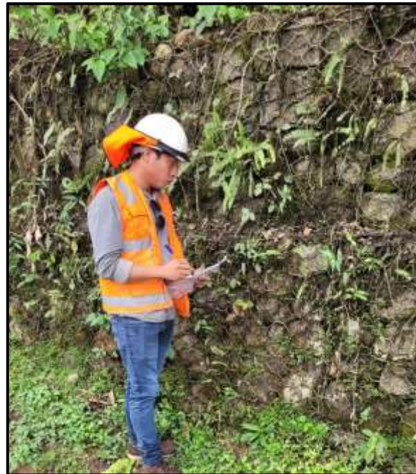
Figura 32: Progresiva 0+1500 a 0+1600 El material de relleno en este tramo es canto rodado con piedra chancada en diversas cantidades
