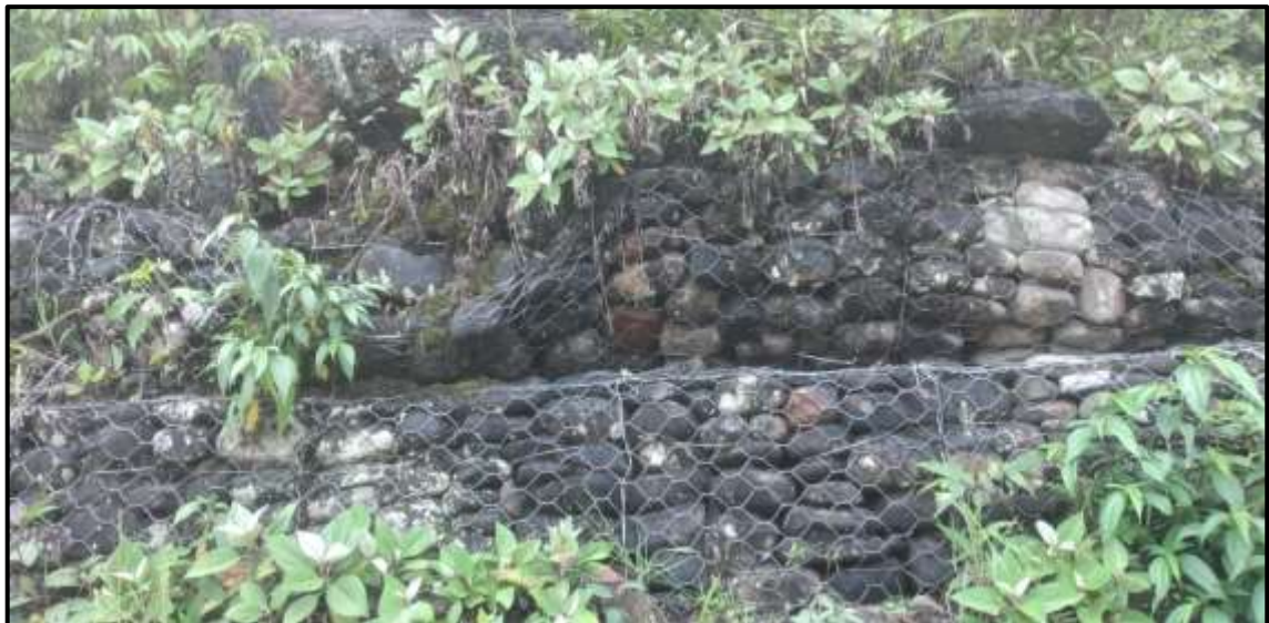
Figura 30: Progresiva 0+1400 a 0+1500 se puede observar la deformación del muro en algunos puntos del tramo, esto, a causa del desprendimiento y caída de rocas de parte del cerro colindante sobre el muro
