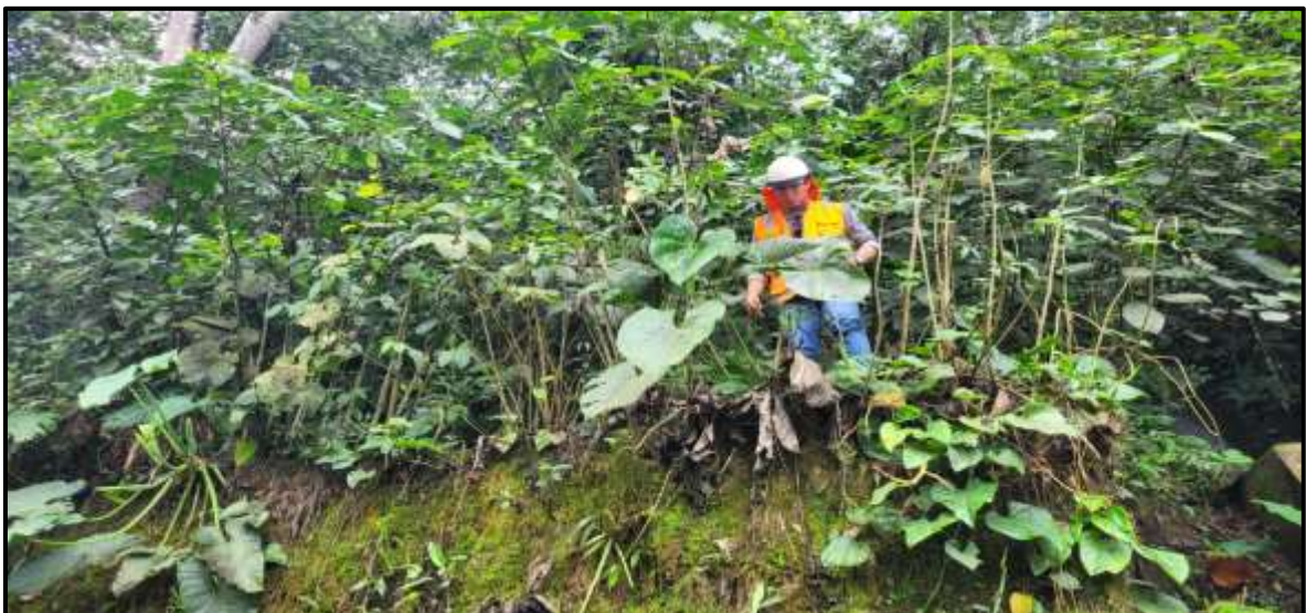
Figura 34: Progresiva 0+1500 a 0+1600 a lo largo de esta progresiva, se observó abundante vegetación en el 60% del tramo.
