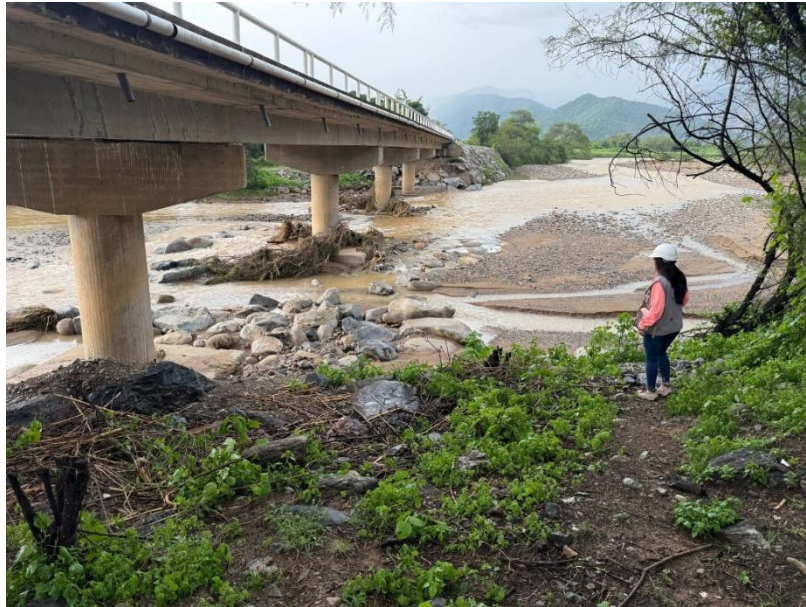
Figura 13: Se aprecia el mal estado de la defensa ribereña del rio Pusmalca.
