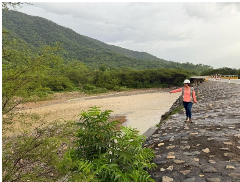
Figura 14: Señalando el estado de la defensa ribereña de Rio Pusmalca
