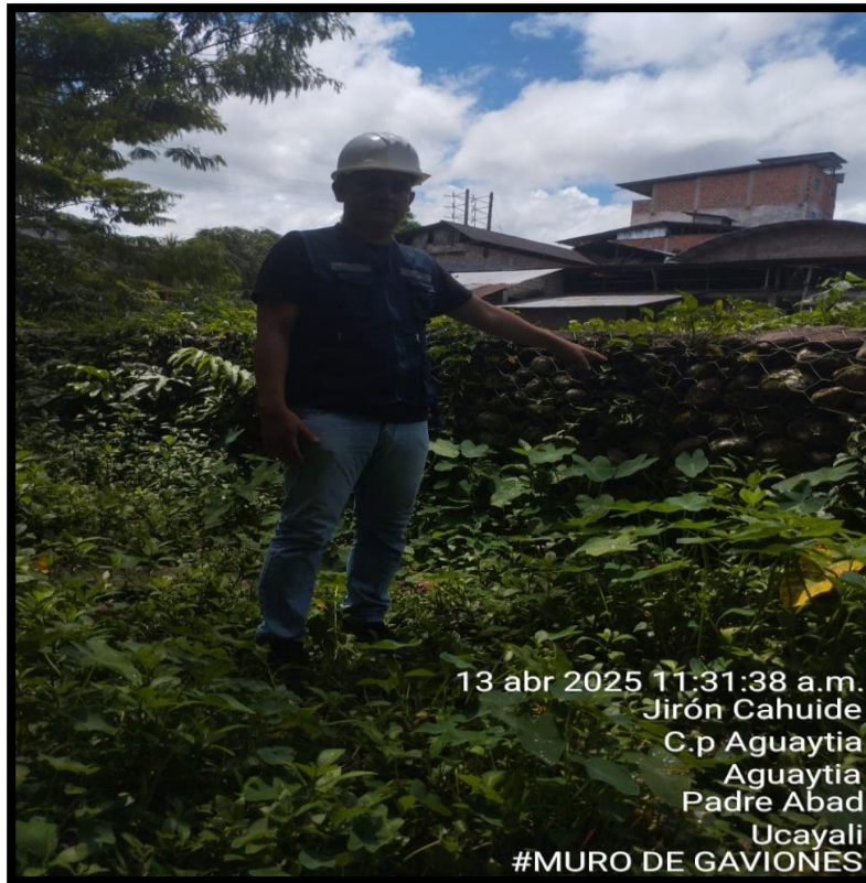
Figura 47: Vista de mi persona en los muros de gaviones y falta de relleno para su estabilidad
