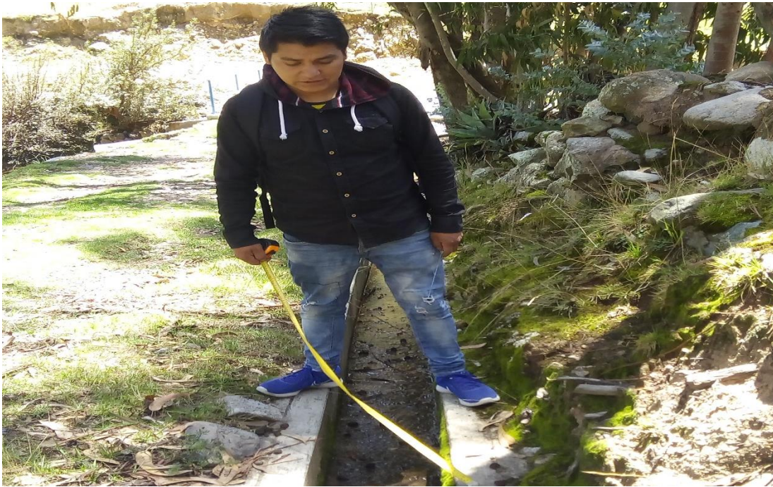
Imagen 07: fotografía del canal de Chuyan mi persona indicando patología.
