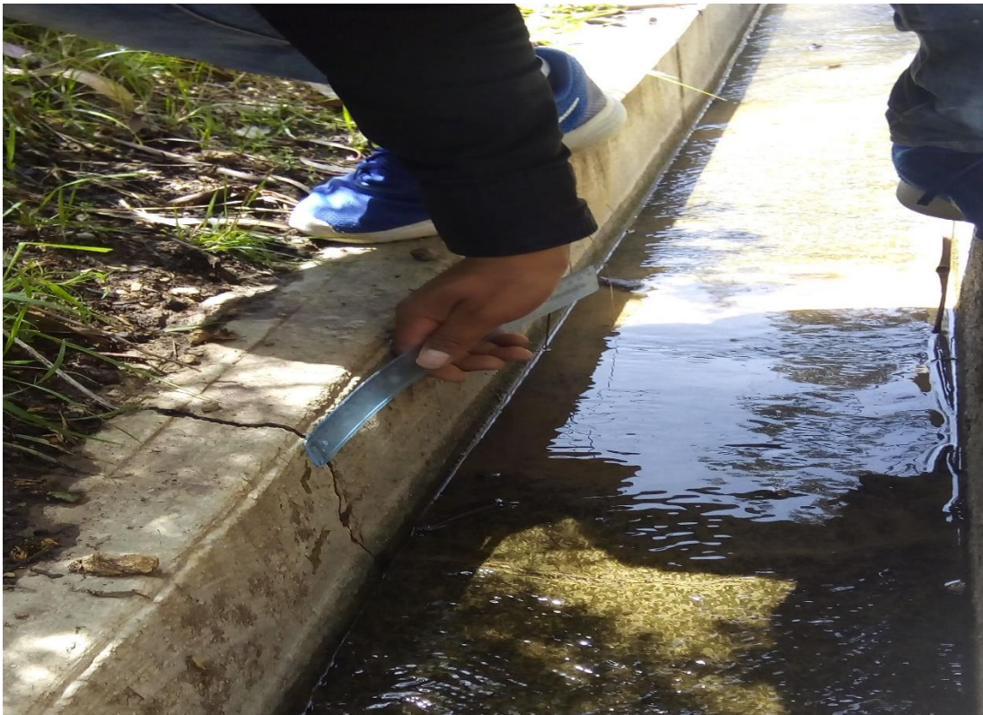
Imagen 10: Muro derecho realizando la medición de patología grieta.
