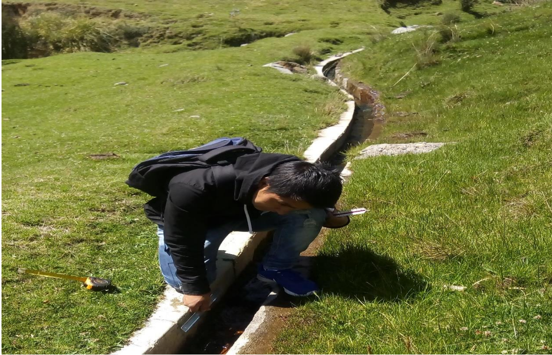
Imagen 09: panel fotográfico de canal de Chuyan realizando medición de grieta.
