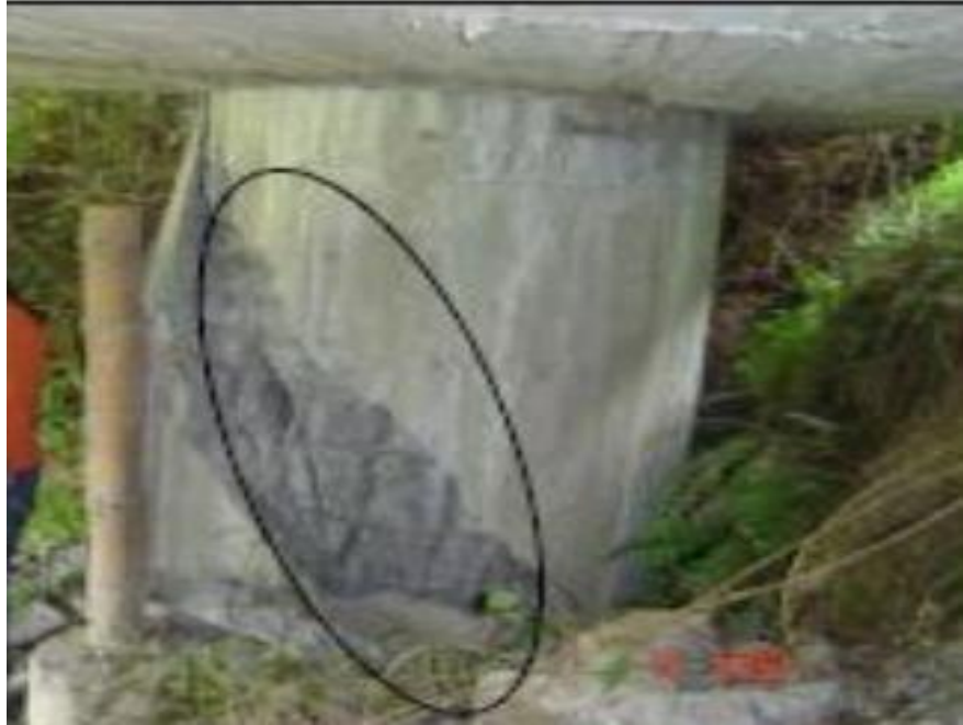
GRAFICO 30: FISURAS POR DOBLEZ DEL PILAR. PUENTE SOBRE LA QUEBRADA MARMATO, CALDAS. FUENTE: (INVIAS, 2006)
