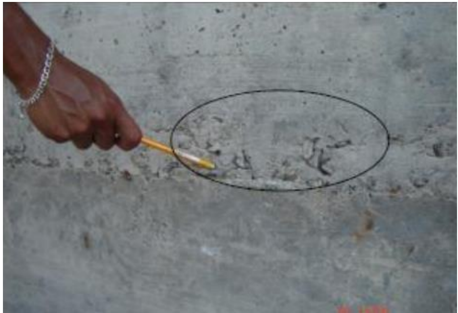
GRAFICO 35: SEGREGACIÓN EN UN MURO. VÍA SIMITÍ- CENTRO DE BURGOS, BOLÍVAR. FUENTE: (INVIAS, 2006)
