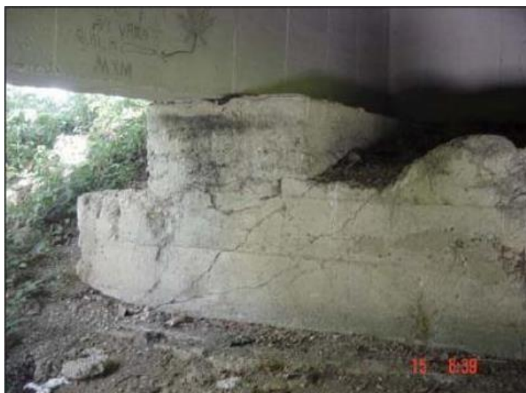
GRAFICO 32: ROTURAS POR HUNDIMIENTO EN LA BASE DEL CIMIENTO.
