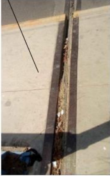
SE OBSERVA LAS PLANCHAS DESLIZANTES EN MAL ESTADO DE CONSERVACIÓN Y OXIDACIÓN
