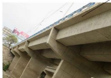
SE OBSERVA LA EFLORESCENCIA
