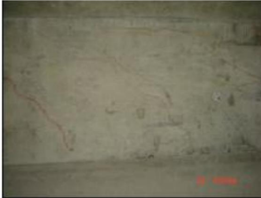
GRAFICO 27: FISURAS POR CORTANTE EN VIGAS.
