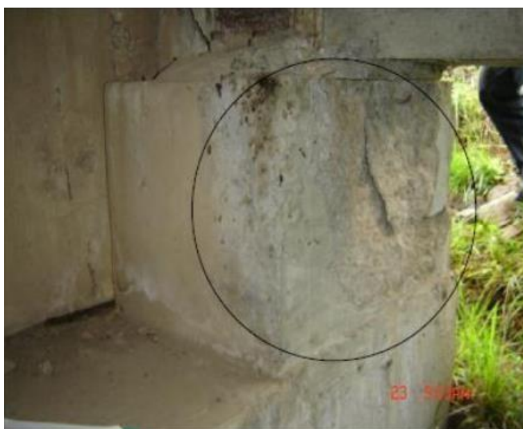
GRAFICO 31: FRACTURA POR APLASTAMIENTO EN EL PEDESTAL.
