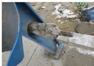
SE OBSERVA RAJADURAS EN LAS BARANDAS
