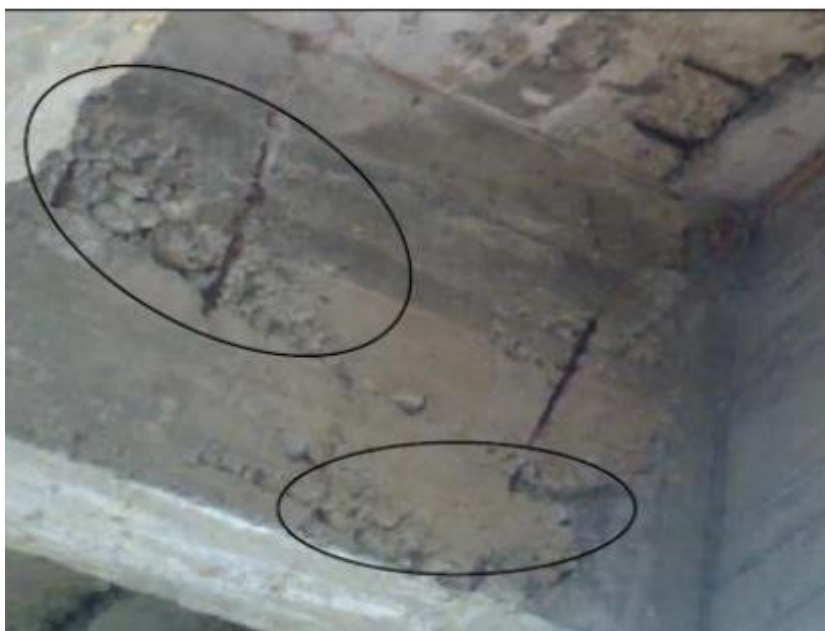
GRAFICO 34: PRESENCIA DE HORMIGUEROS EN LA VIGA CABEZAL. PUENTE RÍO MELDAR, TOLIMA. FUENTE: (INVIAS, 2006)
