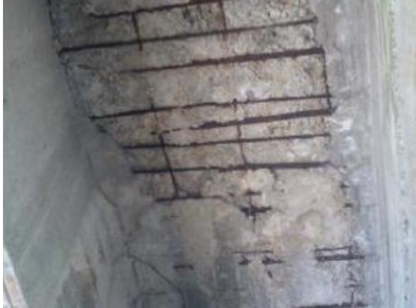
GRAFICO 38; RECUBRIMIENTO INADECUADO EN LA LOSA. PUENTE Q. LAS ÁNIMAS, CHOCÓ. FUENTE: (INVIAS, 2006)
