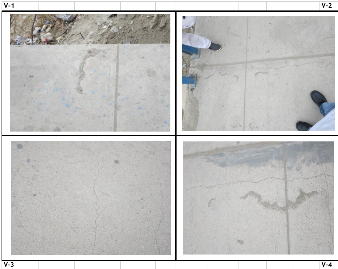
IMAGEN DE VEREDAS CON PATOLOGÍAS.
