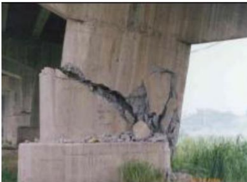
GRAFICO 28: FRACTURA POR CORTANTE EN LA PILA.
