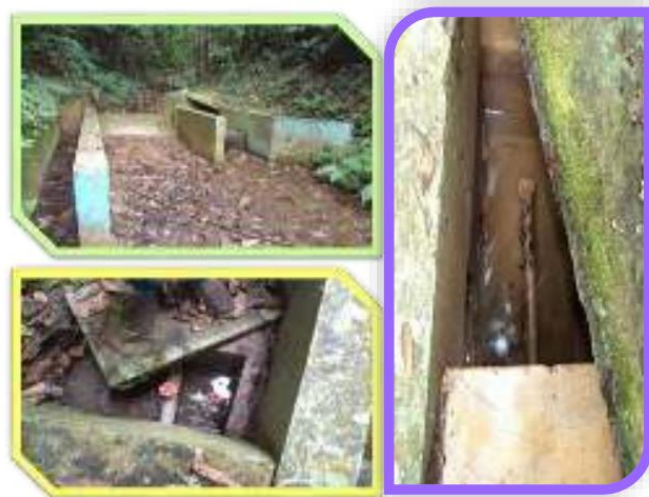
Figura. 13: Captación de la comunidad de Pichari Alta deteriorado.
