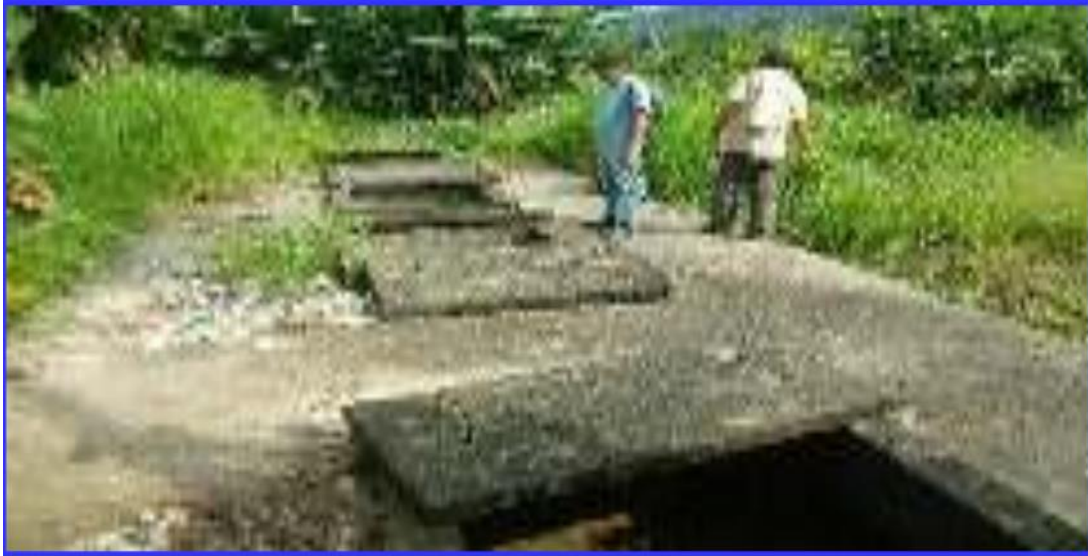
Figura. 30: Infraestructura de planta de tratamiento de aguas residuales actual de la comunidad de Otari San Martin.
