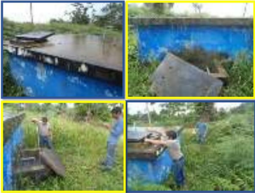
Figura. 16: Infraestructura en condiciones inadecuadas del reservorio de la comunidad de Pichari Alta.
