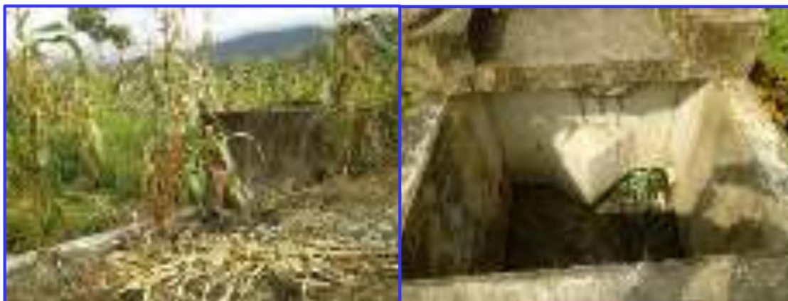
Figura. 29: cámara de rejas actual existente como parte del sistema de agua en la comunidad de Pichari Alta.
