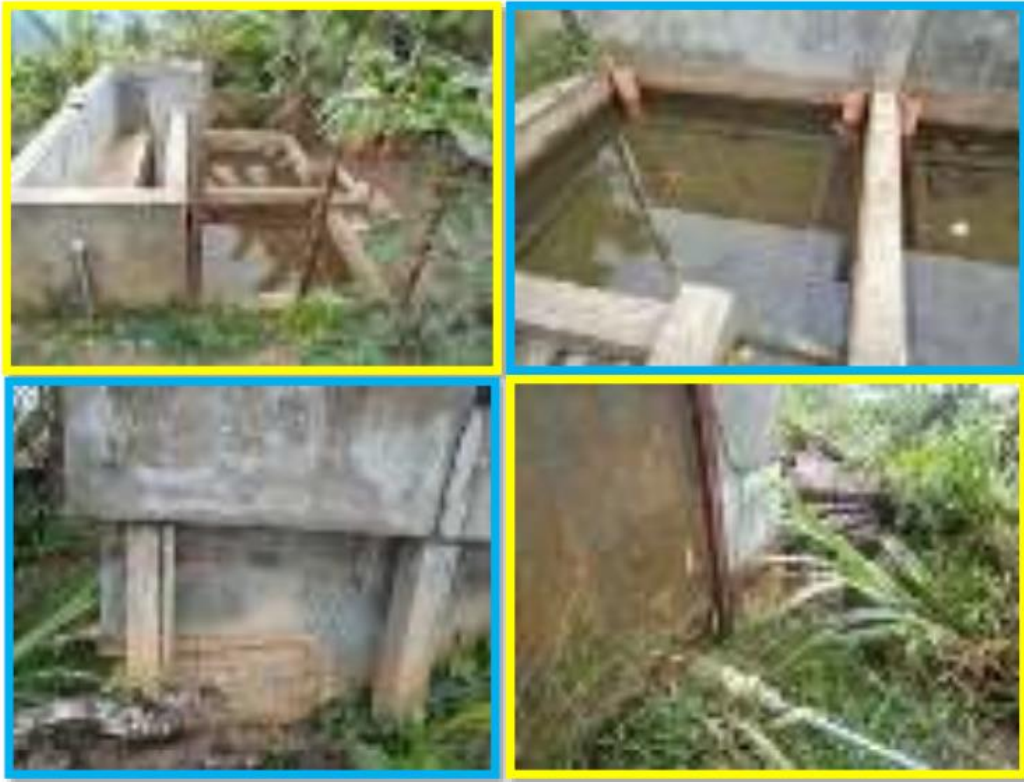
Figura. 15: Infraestructura en condiciones inadecuadas para el tratamiento de agua potable de la Comunidad de Pichari Alta.
