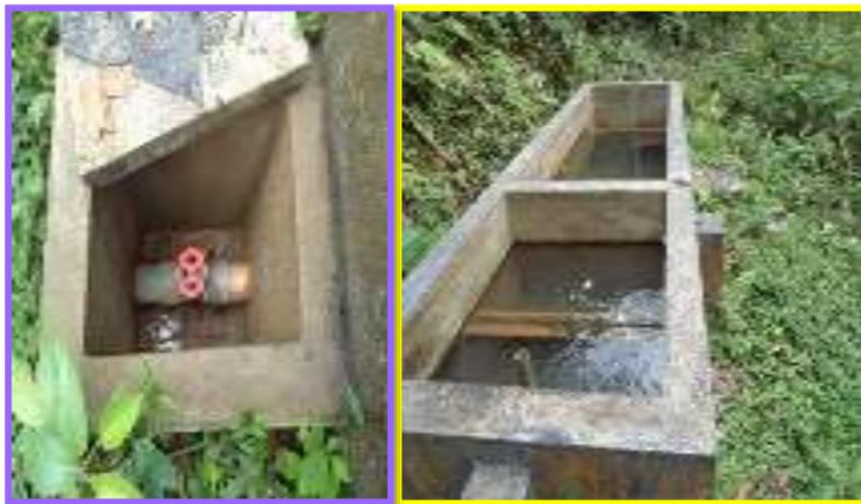
Figura. 14: Desarenadores y válvulas de limpieza como parte del sistema.
