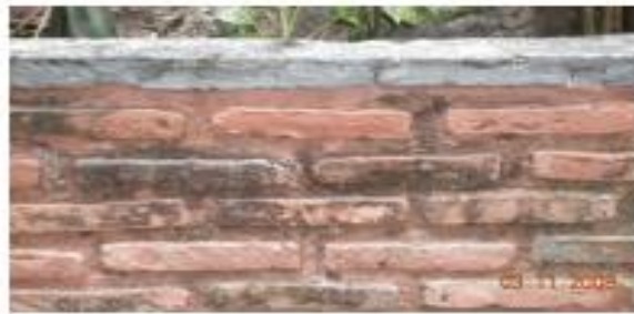
Figura 3: Presencia de disgregamiento Fuente: Patologías Constructivas en los Edificios Prevenciones y Soluciones– Paraguay
