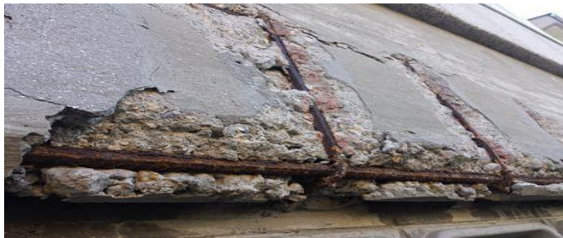
Figura 27: Patología de corrosión en viga.
