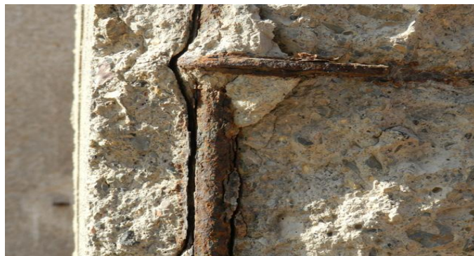
Figura 5: Carbonatación en columna
