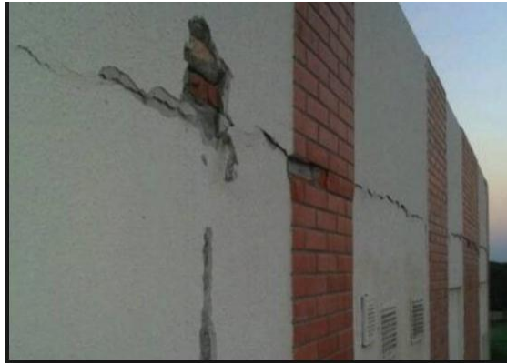
Figura 1: Vista de fisura en cerco perimétrico Fuente: Patologías Constructivas en los Edificios Prevenciones y Soluciones– Paraguay
