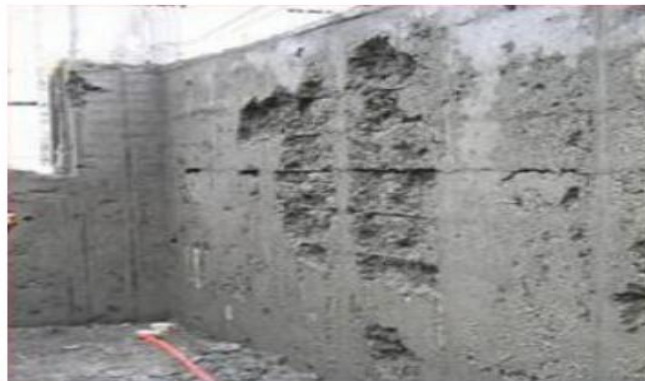
Figura 4: Patología superficial por causa del clima frío.
