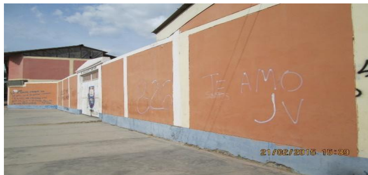
Figura 9: Picaduras en cerco perimétrico de la I.E Enrique López Albuja.
