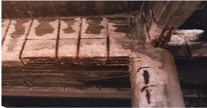
Figura 26: Corrosión en vigas y losa aligerada Fuente: Civilgeeks.com
