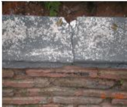
Figura 6: Eflorescencia y fisuras en muro
