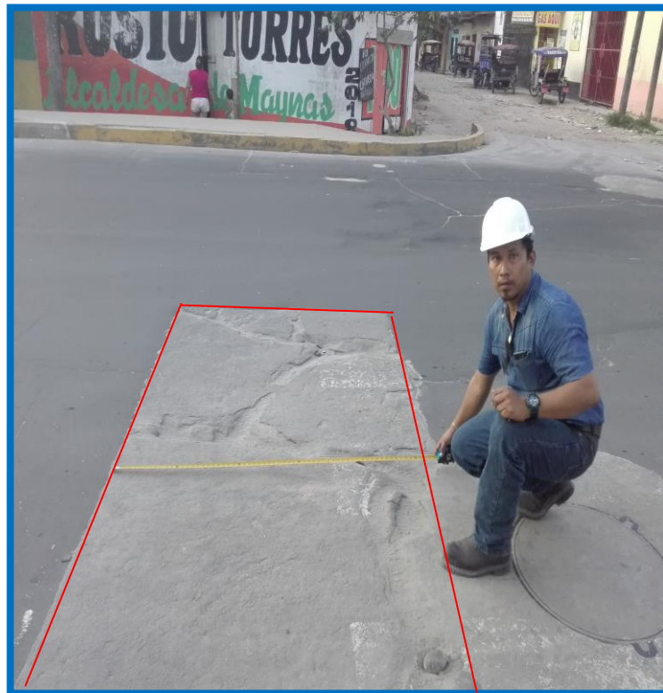
Foto N° 6: Vista de la patología 11 (Parcheo) en la UM4 de la Calle Túpac Amaru
