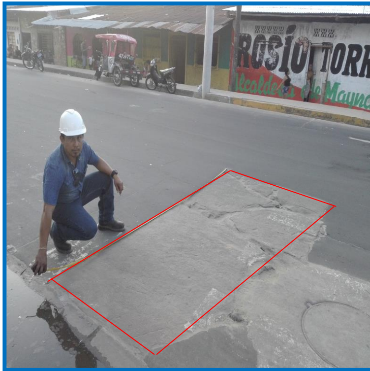
Foto N° 5: Vista de la patología 11 (Parcheo) en la UM4 de la Calle Túpac Amaru
