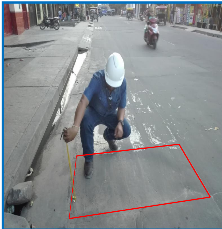
Foto N° 7: Vista de la patología 4 (hundimiento) en la UM9 de la Calle Túpac Amaru.
