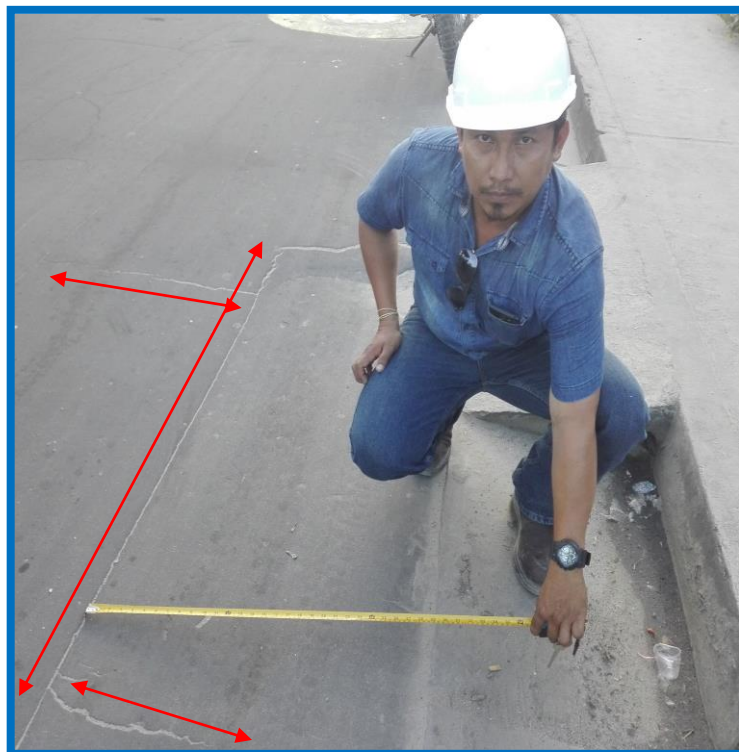
Foto N° 4: Vista de la patología 10 (grieta long. y transv.) en la UM2 de la Calle Túpac Amaru
