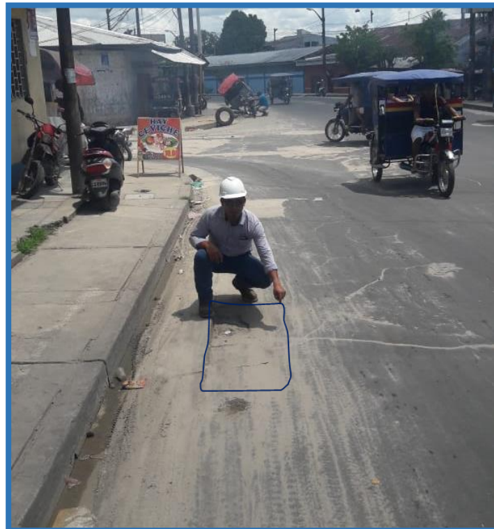
Foto N° 2: Vista panorámica de la patología 13 (Huecos) en la UM1 de la Calle Túpac Amaru
