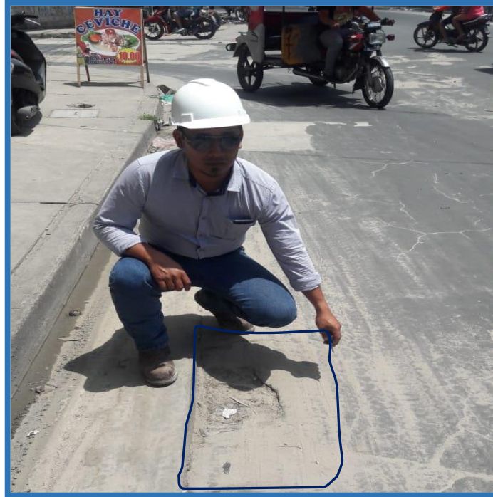
Foto N° 1: Vista de la patología 13 (Huecos) en la UM1 de la Calle Túpac Amaru
