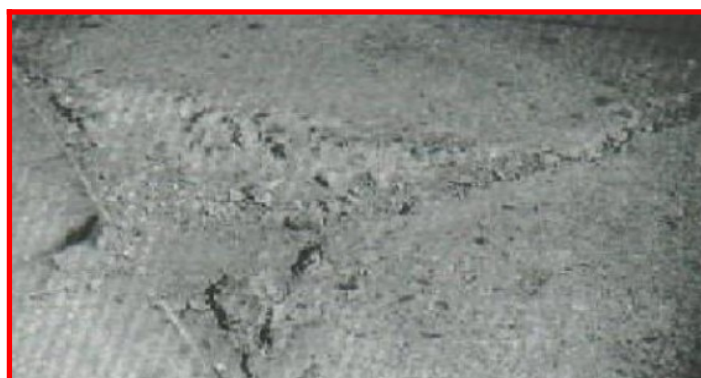
Figura N° 21: Descascaramiento de Esquina
