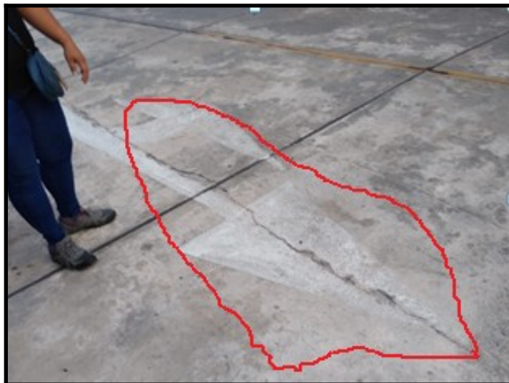
Figura N° 47: Se observa el daño de Grieta lineal con severidad media de la UM - 01
