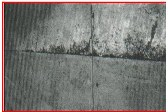
Figura N° 22: Descascaramiento de Junta
