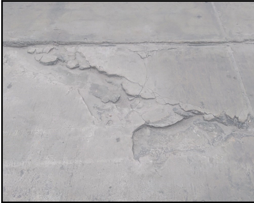
Figura N° 50: Se observa el daño de grieta de esquina con severidad alta de la UM - 02
