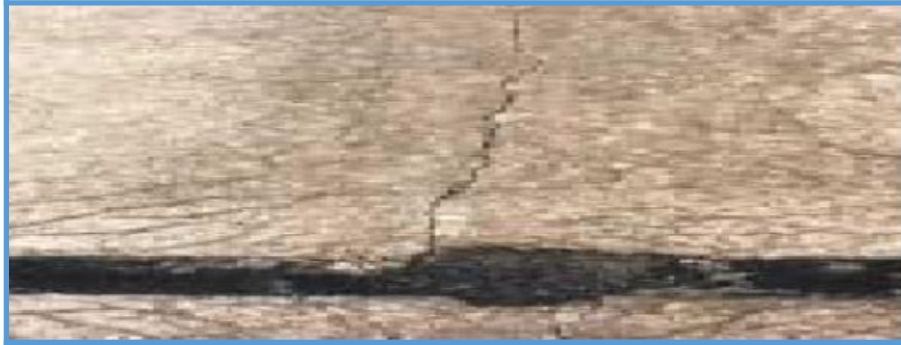
Figura N° 14: Grieta de Durabilidad “D”
