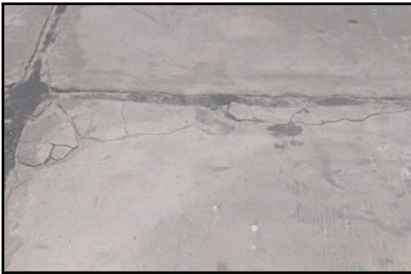
Figura N° 62: Se observa el daño de Grieta de esquina con severidad media de la UM – 04
