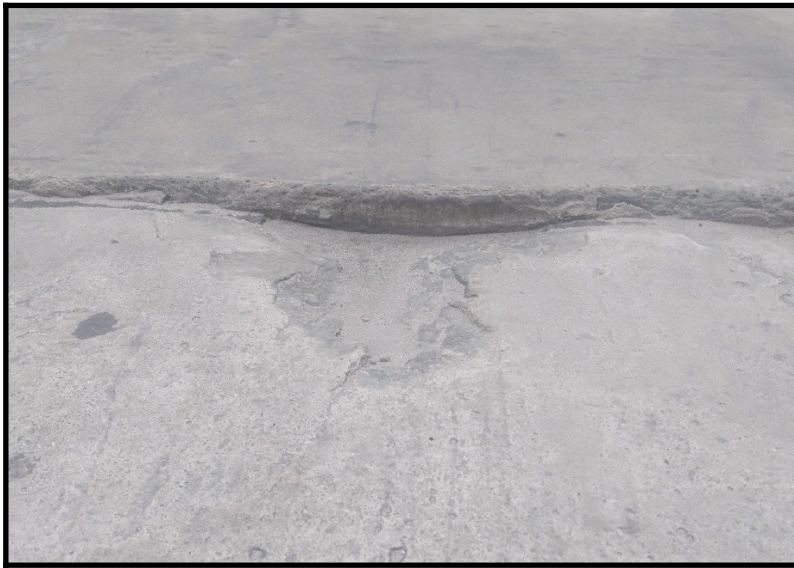
N° 45: Se observa el daño de Escala con severidad alta de la UM - 01
