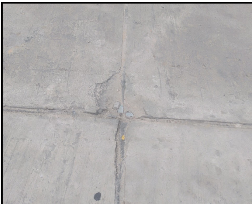
Figura N° 65: Se observa el daño de descascaramiento de esquina con severidad baja de la UM - 04
