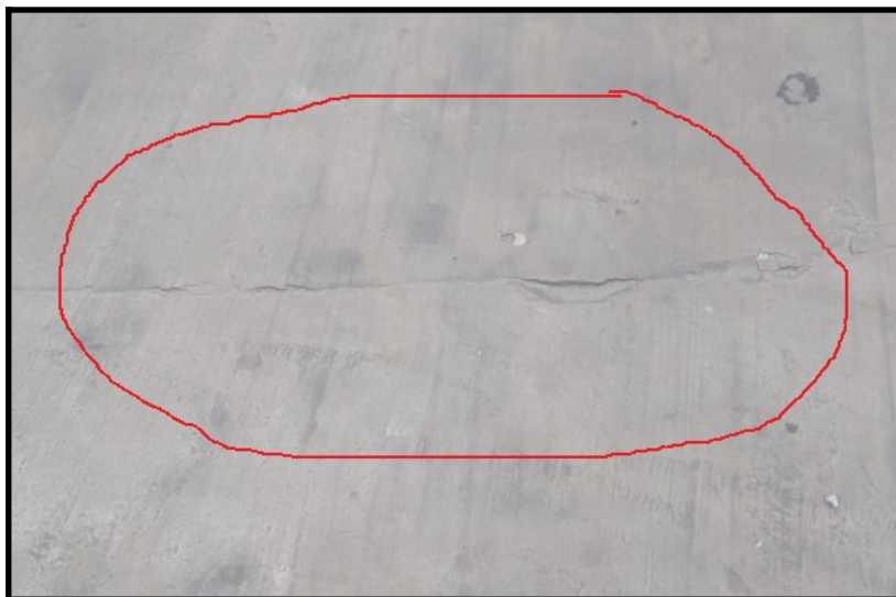
Figura N° 67: Se observa el daño de Grieta lineal con severidad media de la UM - 05
