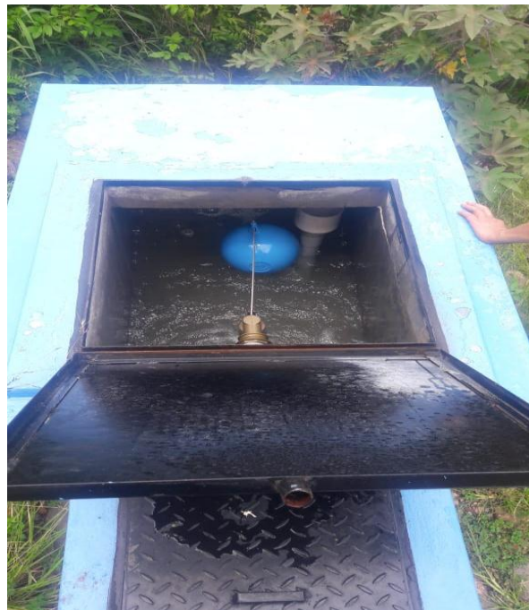
Foto 06: En esta toma fotográfica se muestra la cámara de rompe presión instalado en la localidad de Pichiurara.
