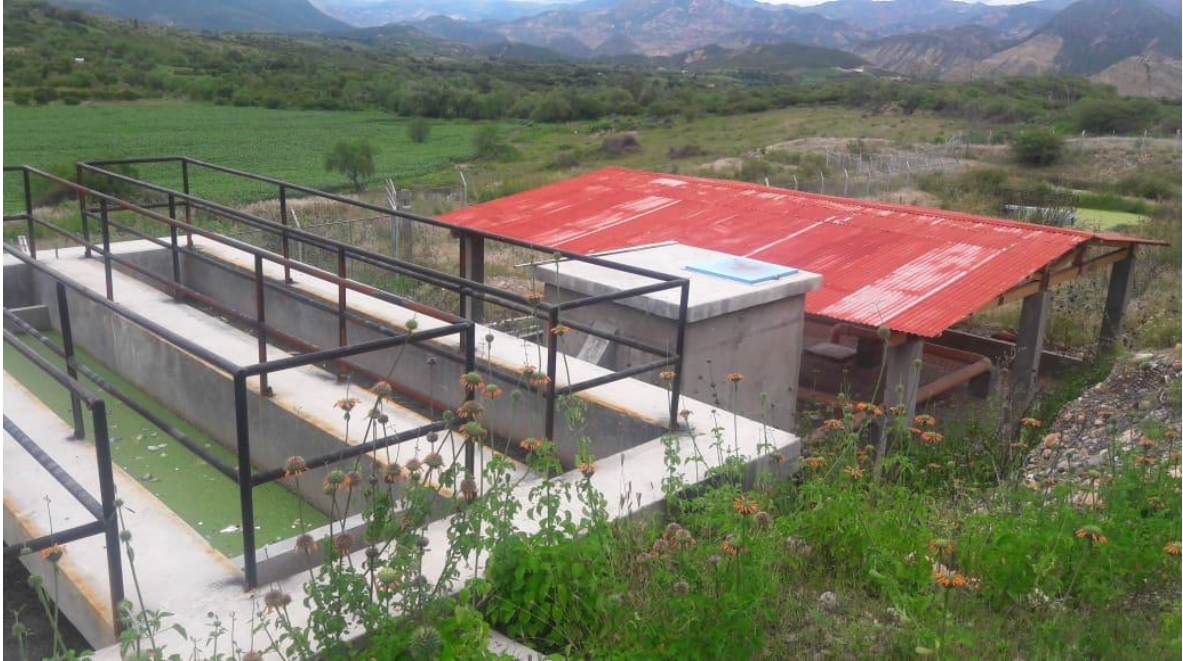
Foto 03: Planta de tratamiento de aguas residuales en la localidad de Pichiurara.
