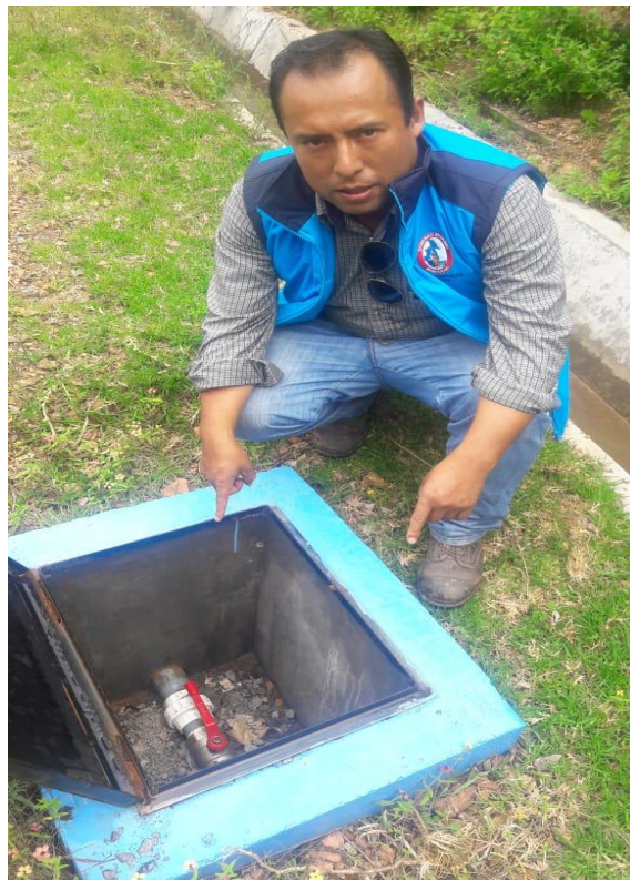
Foto 08: En esta toma fotográfica se muestra las llaves de paso instalado en la localidad de Pichiurara.
