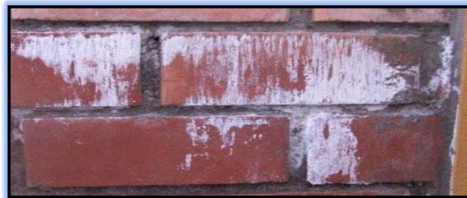
Figura: 10. Eflorescencia en muro
