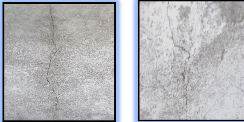
Figura: 11. Imagen de fisura en sobrecimiento
