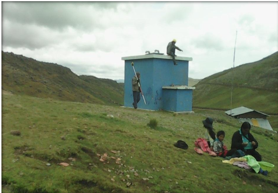
Foto 04: En esta fotografía podemos observar los trabajos topográficos y el reservorio de 17.2 m 3 de la comunidad de Palca.
