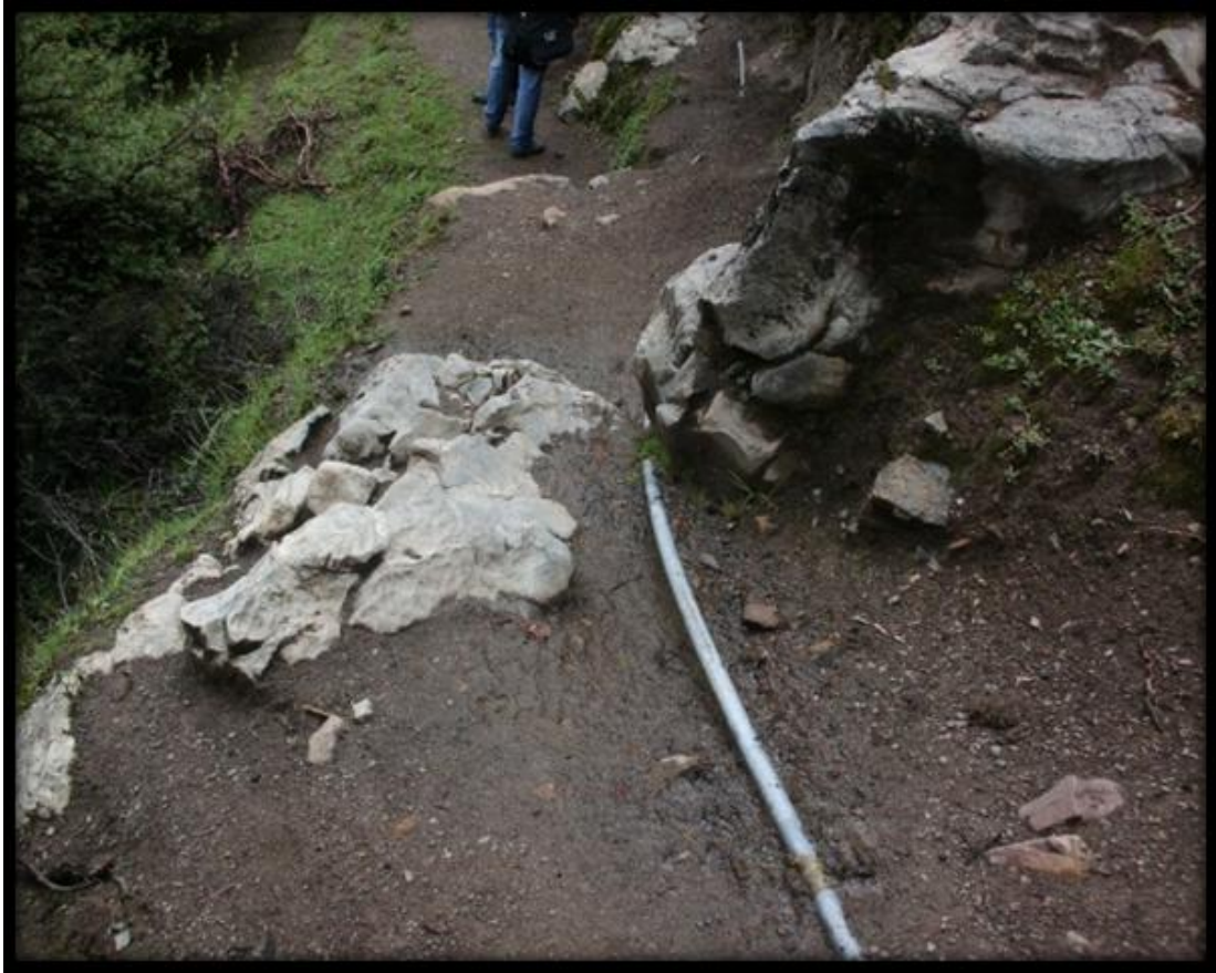
Figura 4.5: Tubería Descubierta en todo el tramo y evidente fuga de agua
