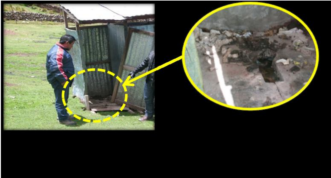
Figura 4.18: vista de la letrina artesanal en estado deplorable e inadecuado
