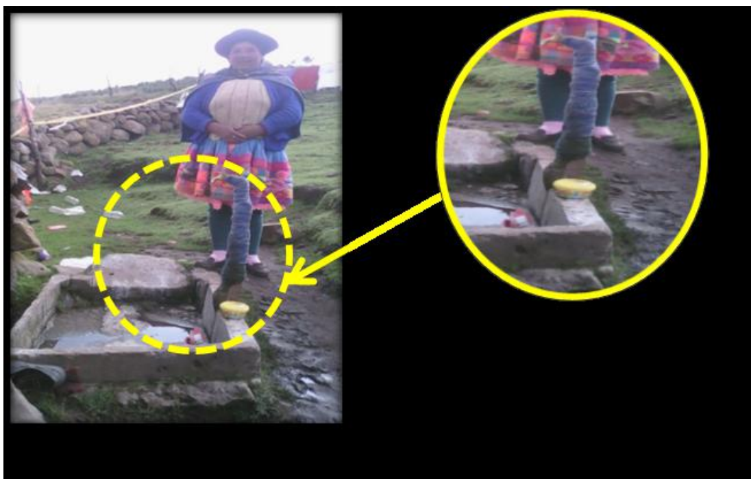
Figura 4.12: Piletas Públicas en mal estado
