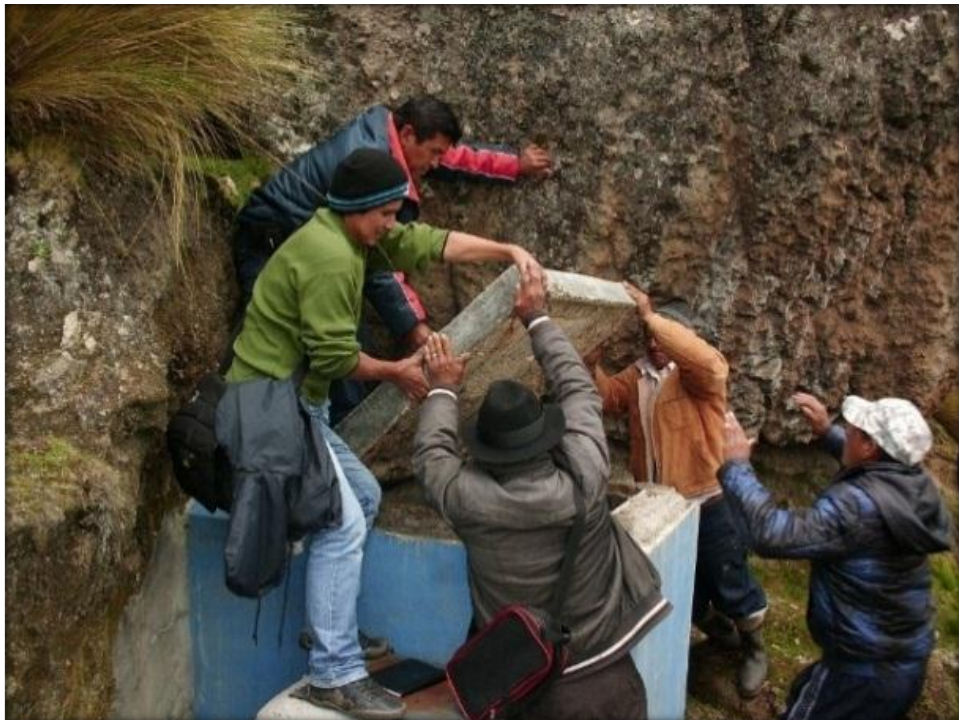
Foto 02: En esta fotografía podemos observar la caja de captación de comunidad de Palca.
