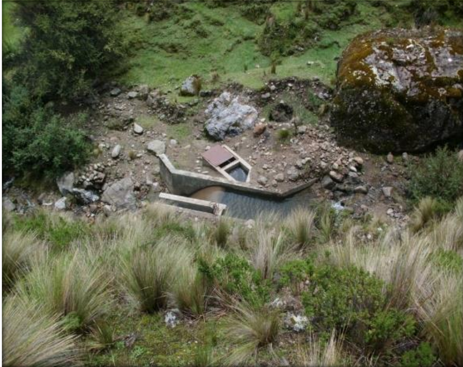
Foto 03: En esta fotografía podemos observar la captación de concreto armado de la comunidad de Palca.
