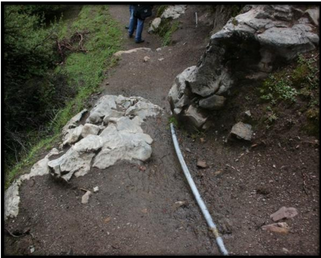
Figura 4.4: Tubería Descubierta en todo el tramo y evidente fuga de agua
