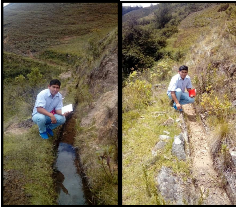
Fotografía 1.- vista panorámica del canal de regadío entre las progresivas 2+000 al 3+00 en el caserío de Querobamba provincia de Sihuas.
