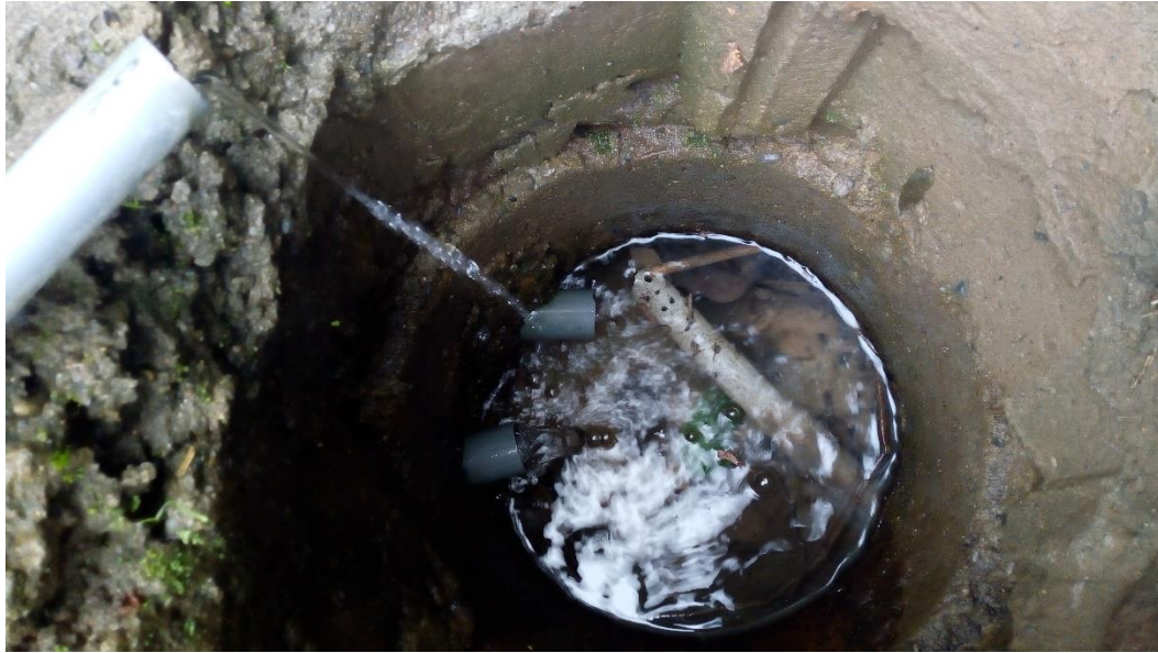
Ilustración 14: Captación Manantial CALANGLA BAJO.
