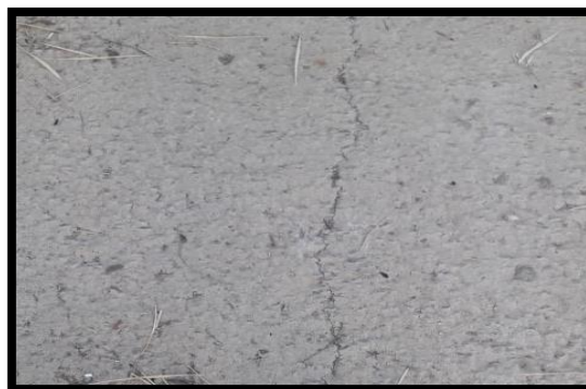
Grafico 07: grietas en el canal de regadío
