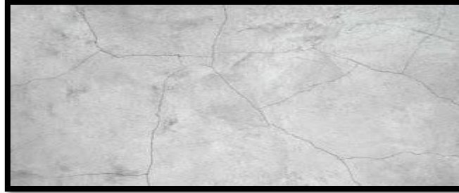
Grafico 06: fisuras en el canal de regadío
