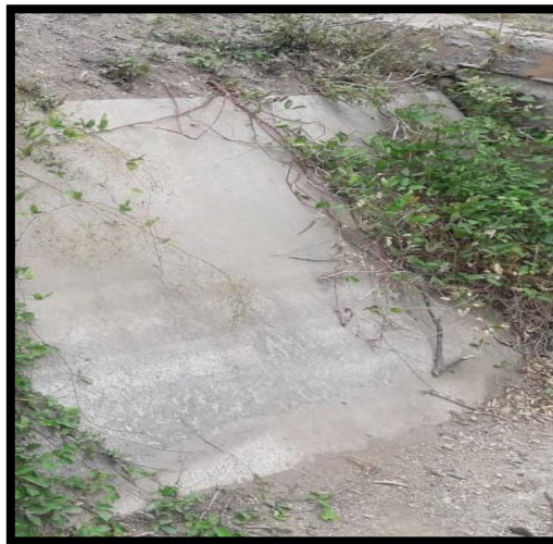
Grafico 09: eflorescencia en el canal de regadío
