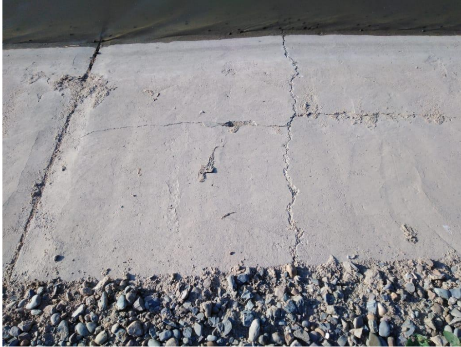
Figura 9. Fisuras en el concreto. Fuente: Elaboración propia.
