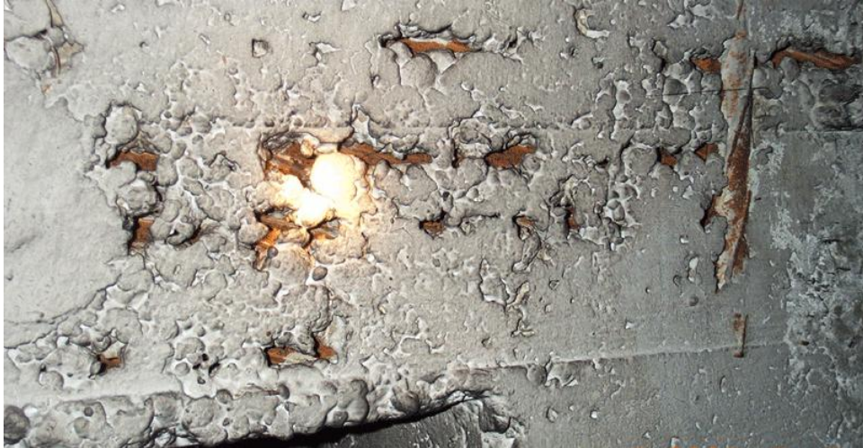
Figura 1. Estructura de concreto afectada por múltiples patologías Fuente: (E-STRUCT) 5
