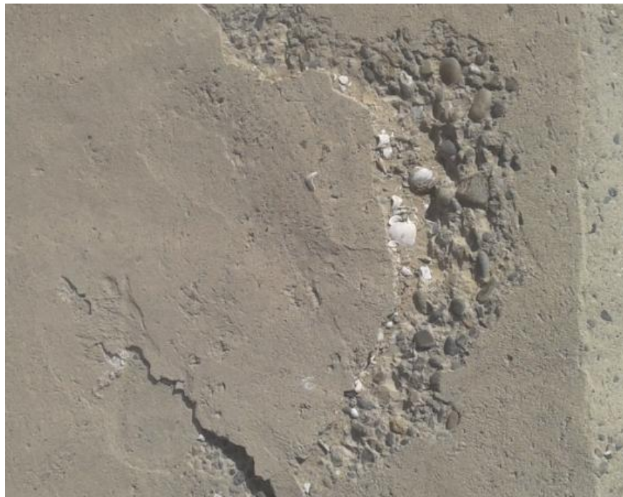
Figura 8. Desintegración del concreto. Fuente: Elaboración propia.
