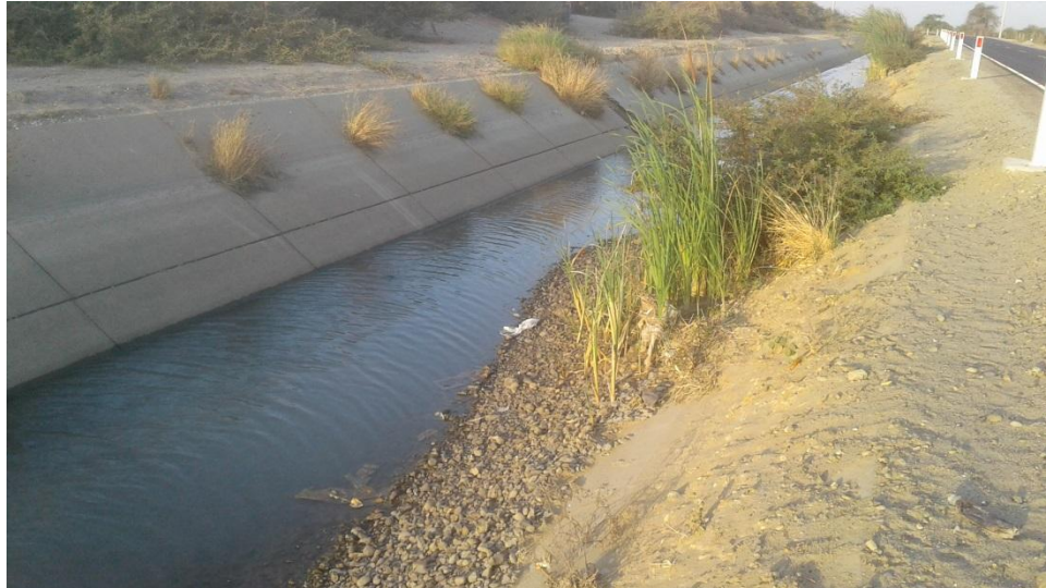
Figura 13. Vegetación creciendo en el concreto. Fuente: Elaboración propia.
