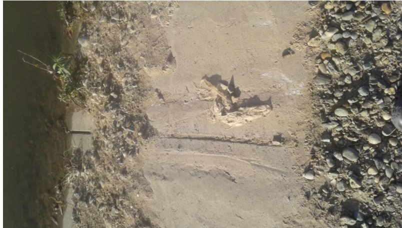
Figura 10. Erosión y aparición de los agregados. Fuente: Elaboración propia.
