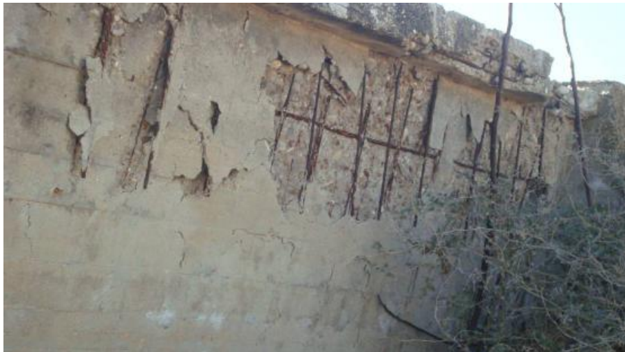
Figura 7. Corrosión del acero y desprendimientos. Fuente: (Higuera y otros) 17
