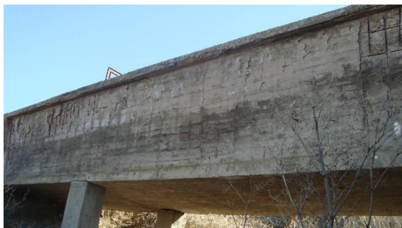
Figura 11. Descascaramiento y pérdida del recubrimiento. Fuente: (Higuera y otros) 17 .
