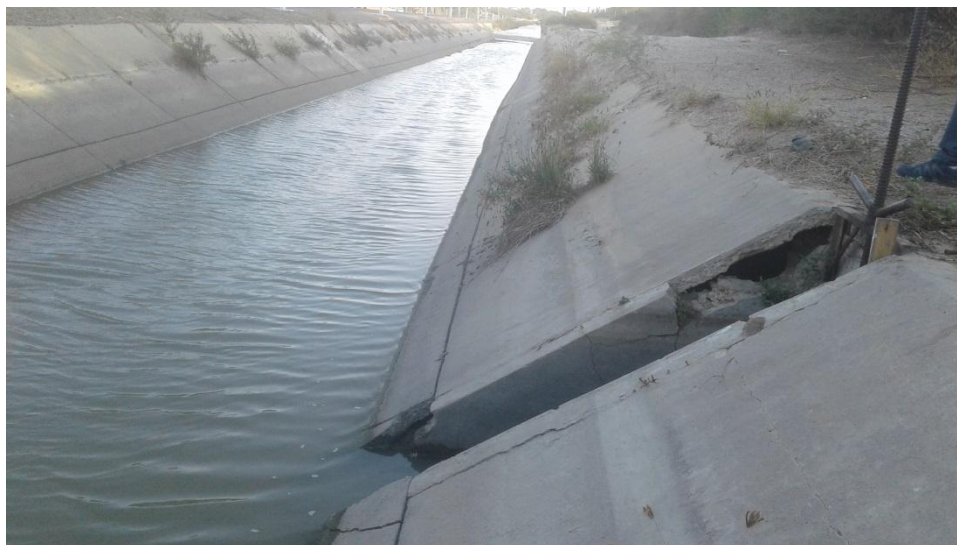
Figura 12. Desprendimiento y rotura del concreto. Fuente: Elaboración propia.
