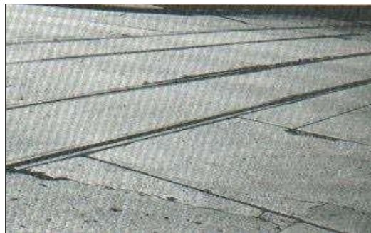
Figura10. Falla por el Cruce de Vía Férrea.
