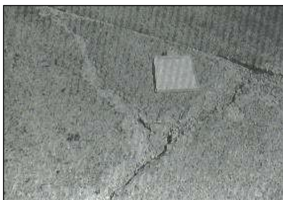
Figura 17. Grietas de Esquina.
