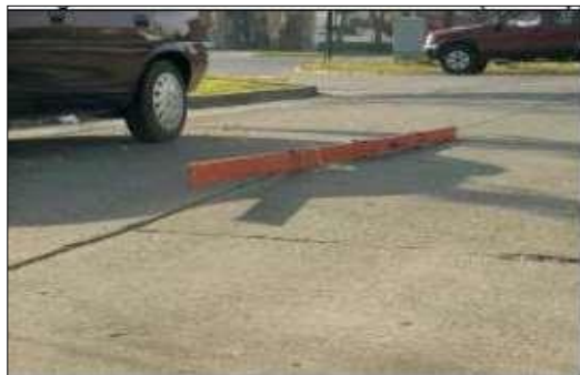
Figura 8. Falla por Bombeo.
