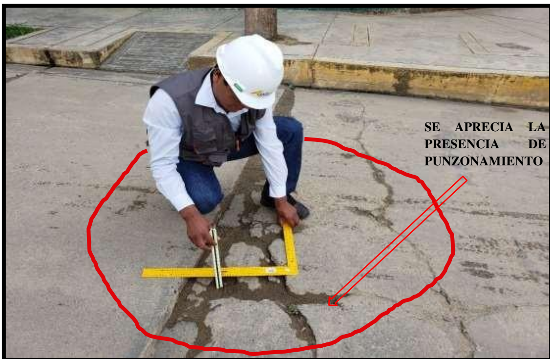
Figura 106. Fotografía de la vista de la existencia del daño de punzonamiento (34H).
