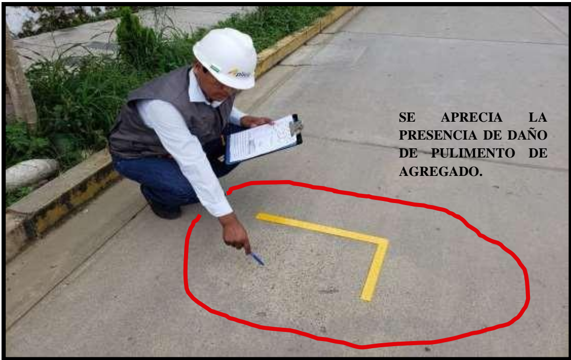
Figura 100. Fotografía de la vista de la existencia del daño de Pulimento de Agregado (31).
