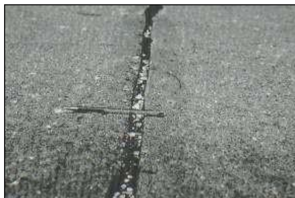
Figura 15. Daño de Sello de Junta.
