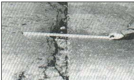
Figura 13. Descascaramiento de Junta.
