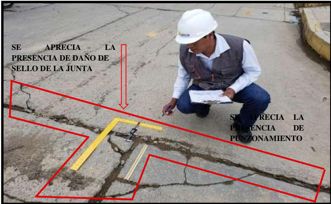
Figura 105. Fotografía de la vista de la existencia del daño de sello de la junta (26H).
