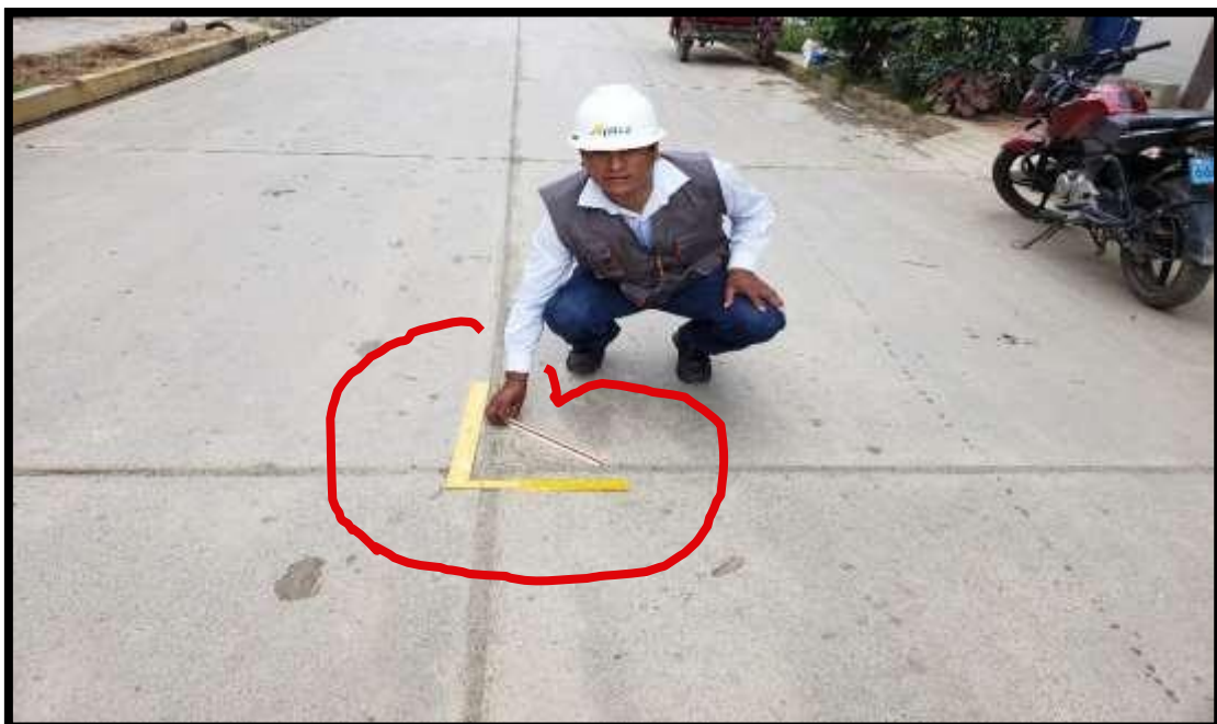
Figura 96. Fotografía de la vista cercana de la existencia de desconchamiento de severidad media (36M).
