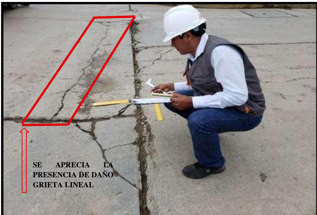
Figura 102. Fotografía de la vista de la existencia del daño de grieta lineal (Transversal) (28M).
