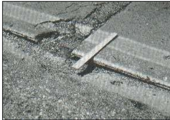
Figura 14. Desnivel de Carril / Berma.
