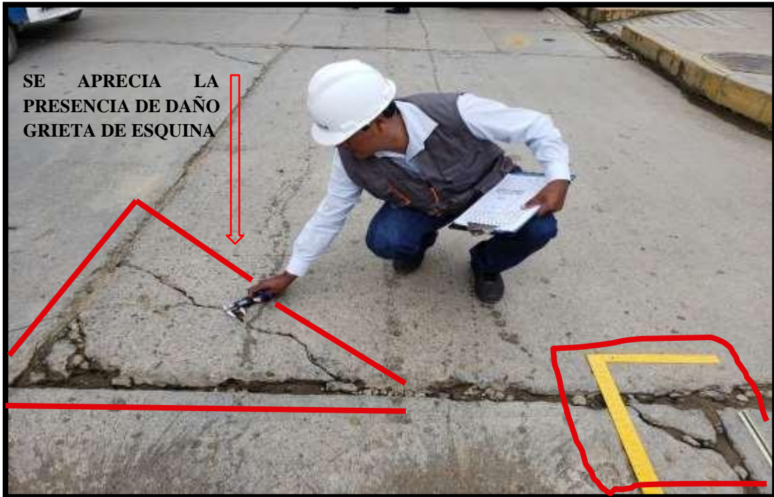
Figura 103. Fotografía de la vista de la existencia del daño de grieta de esquina (22M).
