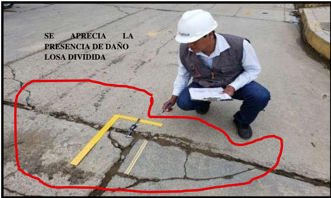
Figura 113. Fotografía de la vista de la existencia de daño losa dividida (23L).
