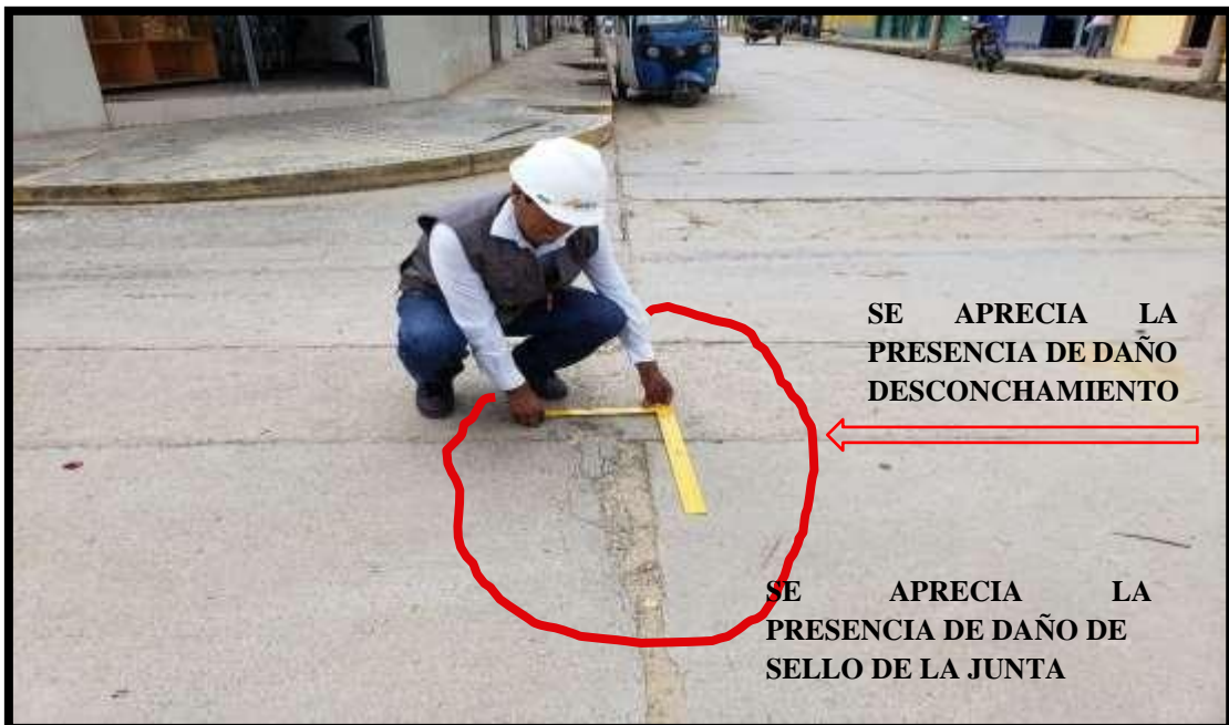
Figura 104. Fotografía de la vista de la existencia del daño de desconchamiento (36L).
