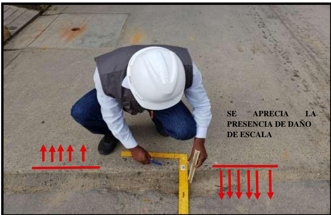
Figura 112. Fotografía de la vista de la toma de datos del daño de escala (25L).
