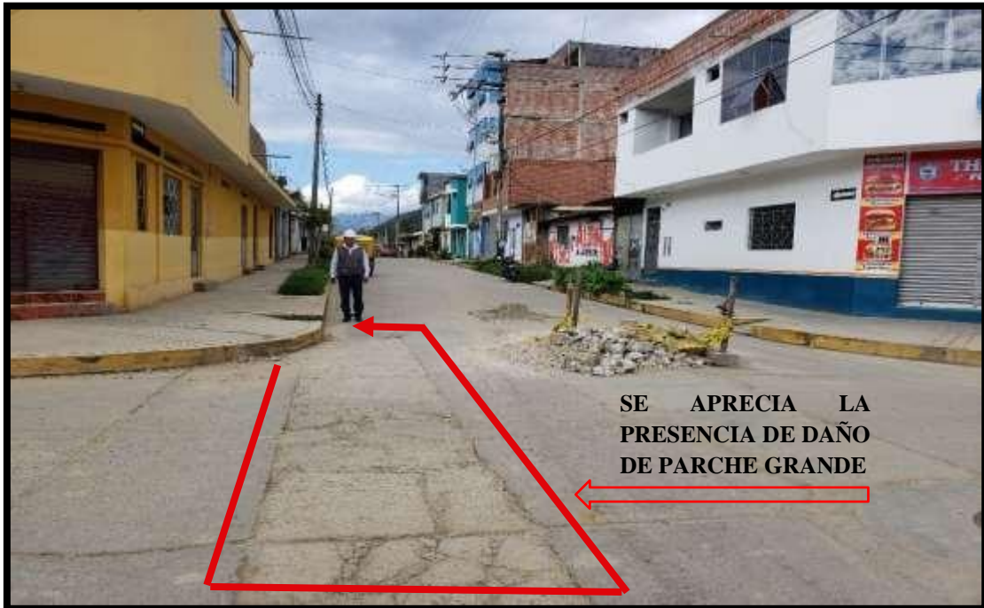
Figura 101 Fotografía de la vista de la existencia del daño de parche grande (29M).
