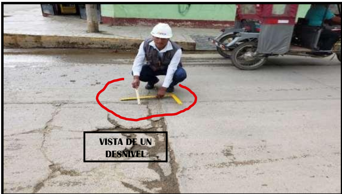
Figura 98. Fotografía de la vista cercana de la existencia de escala de severidad Media (25M).
