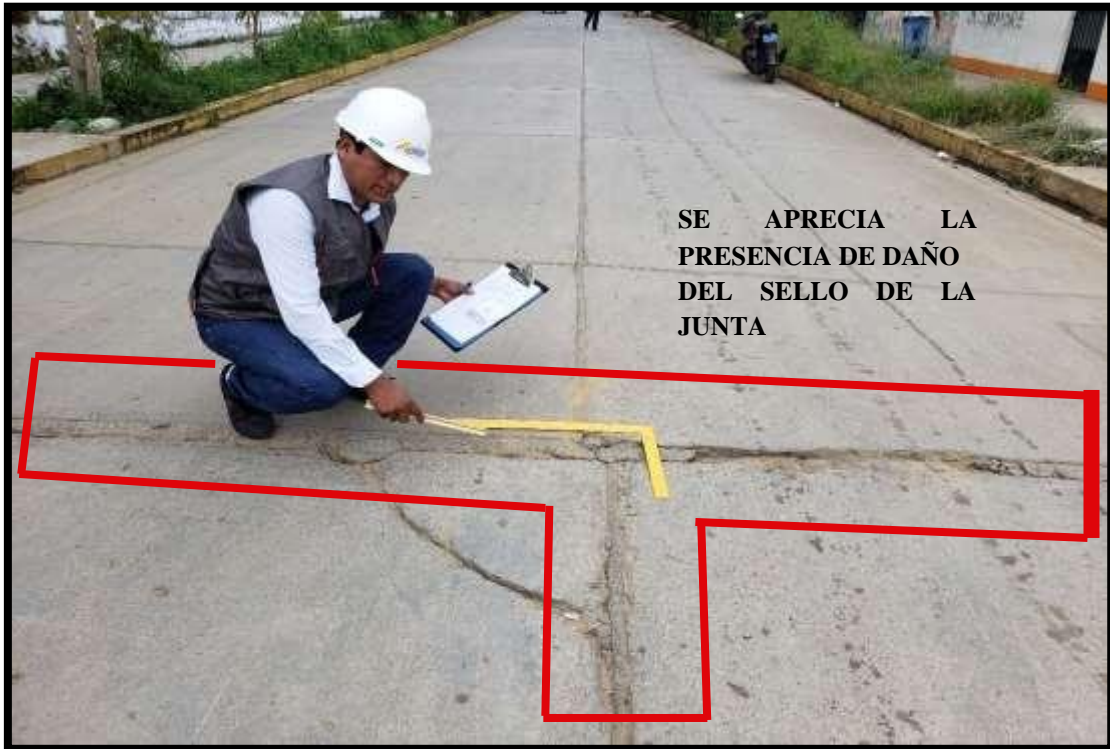
Figura 111. Fotografía de la vista de la existencia del daño del sello de la junta (26L).
