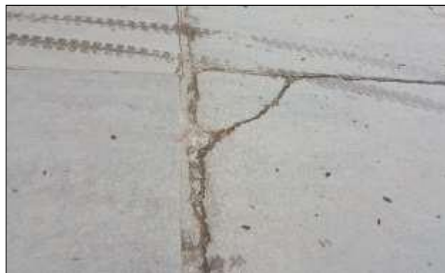
Figura 12. Descascaramiento de esquina.
