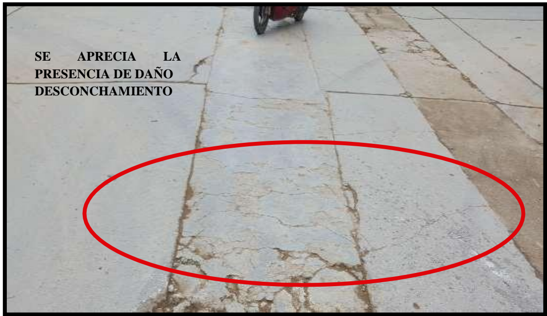
Figura 114. Fotografía de la vista de la existencia del daño de Desconchamiento (36L).
