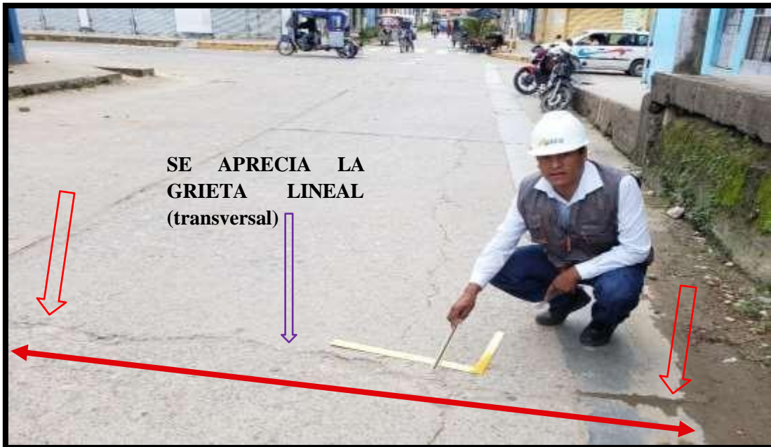
Figura 87. Fotografía de la vista cercana de la existencia de una grieta lineal (transversal) de severidad alta (28H).
