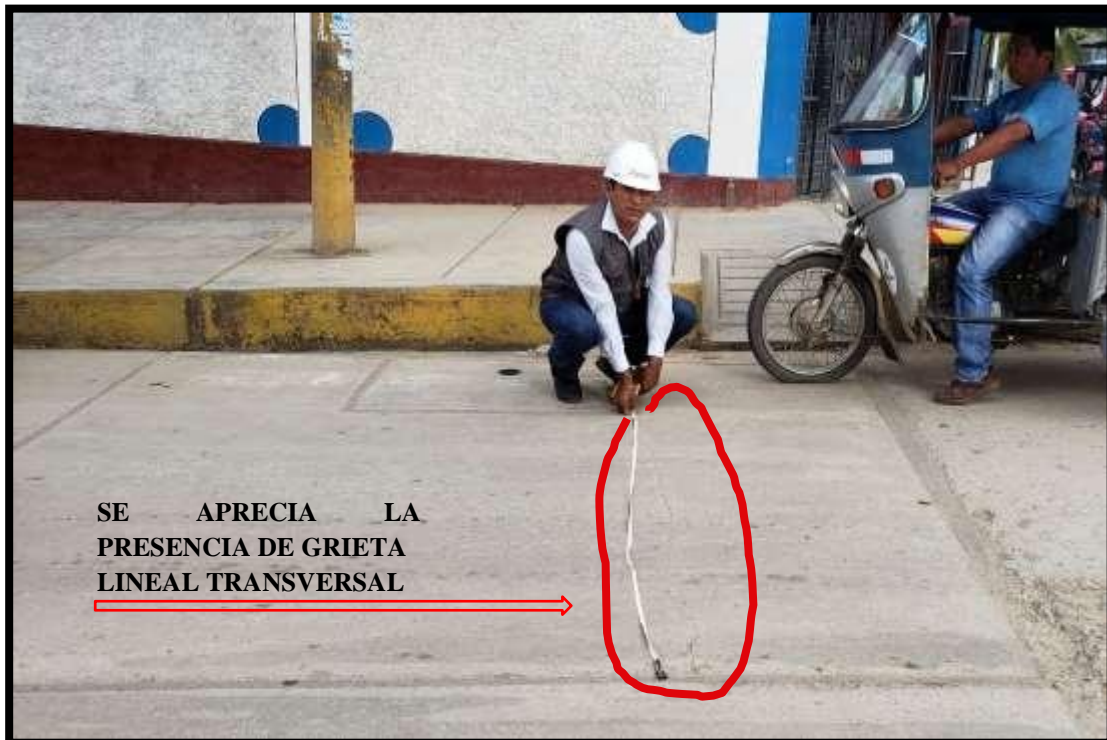
Figura 94. Fotografía de la vista cercana de la existencia de una grieta lineal (transversal) de severidad Baja (28L).
