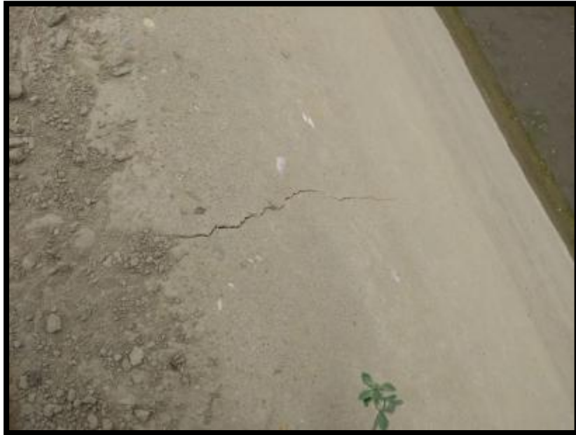
Gráfico 50: Agrietamiento del concreto en el canal
