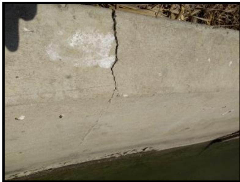
Gráfico 10: Grieta en estructura de concreto.
