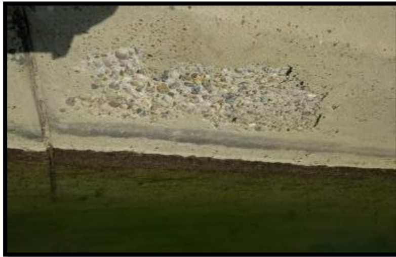
Gráfico 8: Erosión en losa lateral del canal de concreto.
