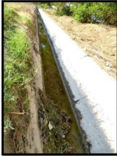
Gráfico 48: Presencia de vegetación en las losas laterales del canal.
