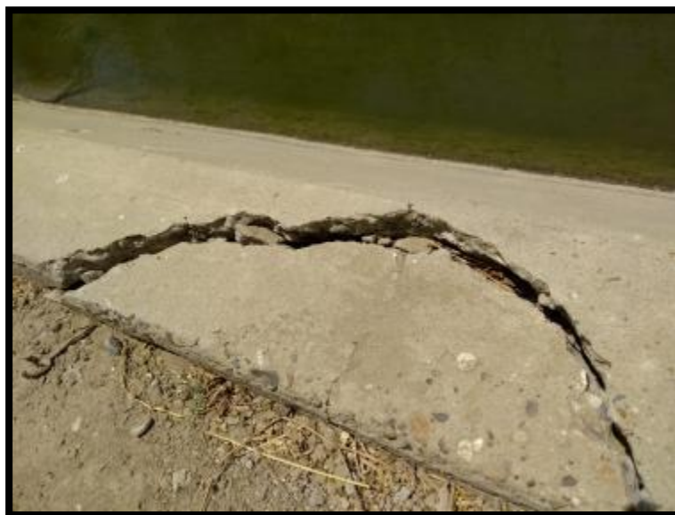
Gráfico 9: Desprendimiento en concreto.
