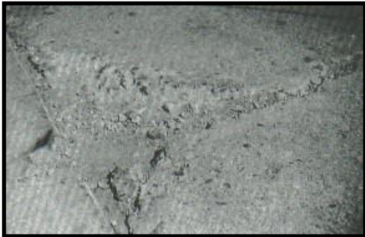
Figura 54. “Descascaramiento de esquina de alta severidad” (20) .
