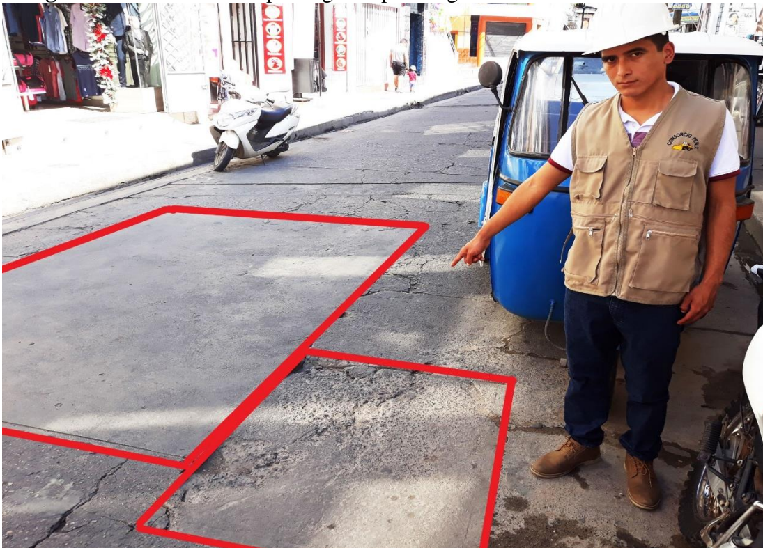
Fotografía 13. Se observa la patología de parche grande en la UM – 03.
