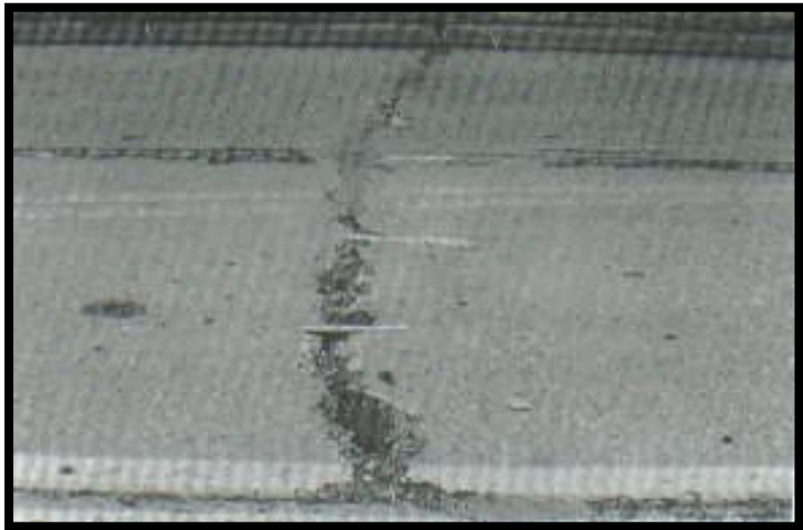
Figura 31. “Grietas lineales de alta severidad” (20) .
