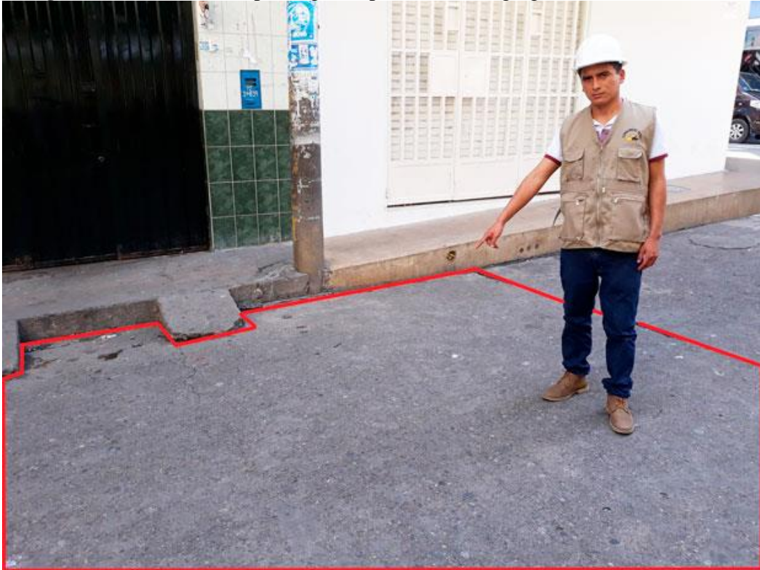
Fotografía 5. Se observa la patología de pulimento de agregados en la UM – 01.
