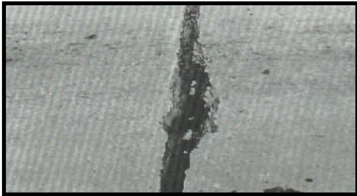
Figura 24. “Daño del sello de la junta de severidad media” (20) .
