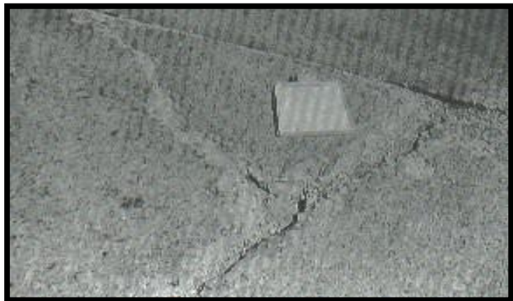
Figura 13. “Grieta de esquina de alta severidad” (20) .
