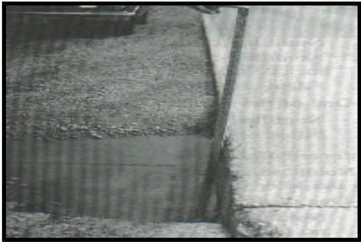
Figura 28. “Desnivel carril / berma de alta severidad” (20) .
