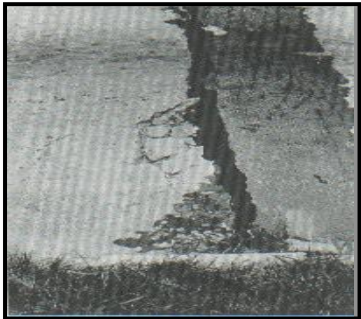
Figura 8. “Blowup – Buckling de baja severidad” (20) .
