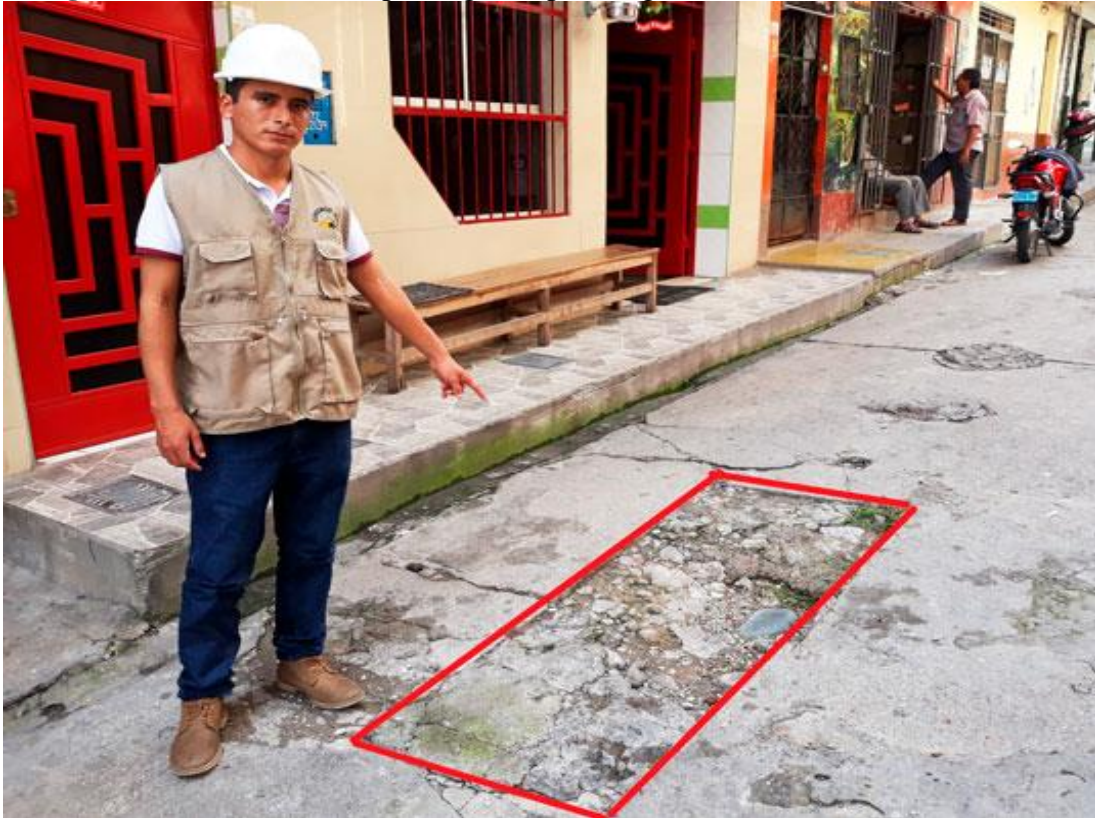
Fotografía 13. Se observa la patología de parche grande en la UM – 01.
