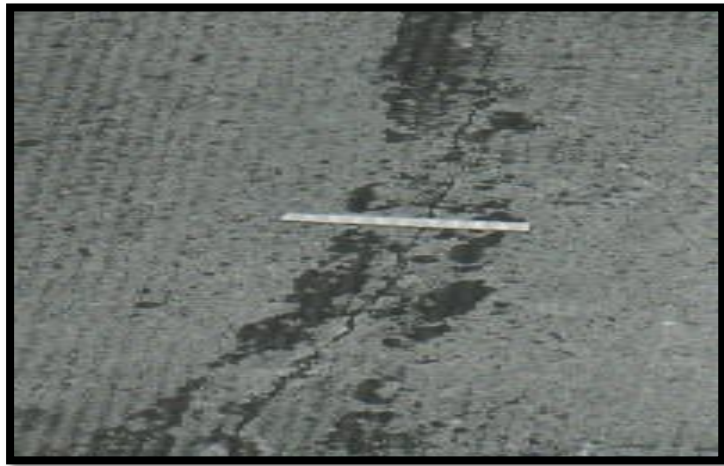
Figura 29. “Grietas lineales de baja severidad” (20) .
