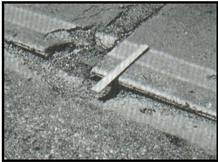
Figura 26. “Desnivel carril / berma de baja severidad” (20) .
