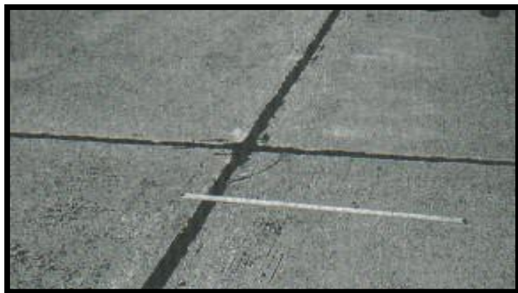
Figura 52. “Descascaramiento de esquina de baja severidad” (20) .
