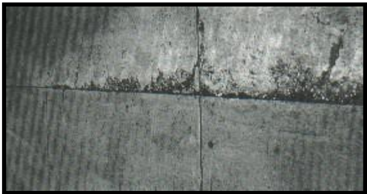
Figura 56. “Descascamiento de junta de severidad media” (20) .
