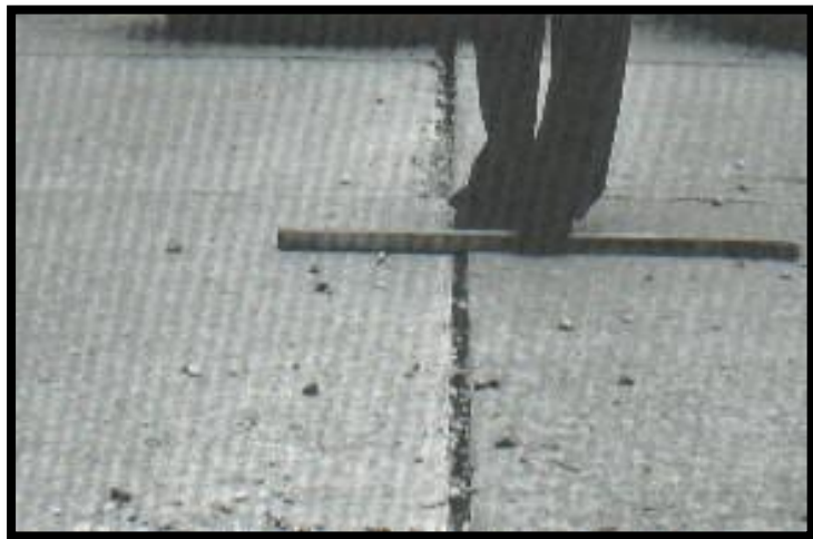
Figura 20. “Escala de baja severidad” (20) .
