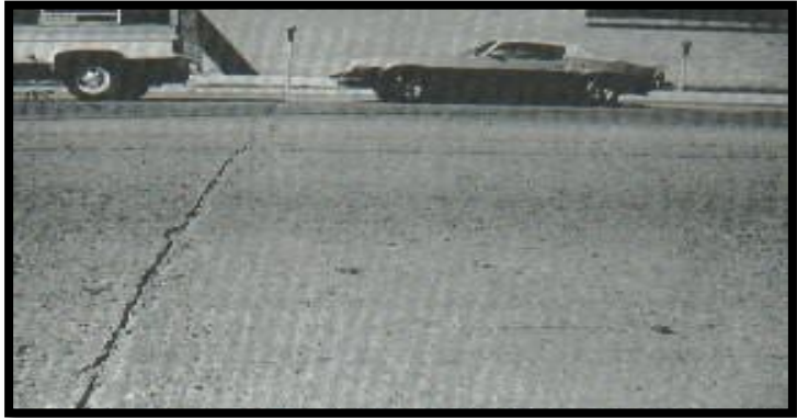
Figura 55. “Descascamiento de junta de baja severidad” (20) .
