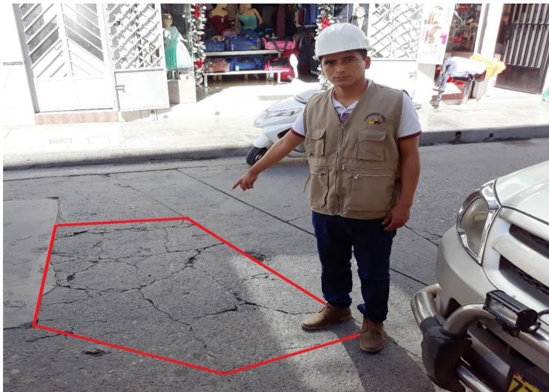
Fotografía 14. Se observa la patología de punzonamiento de severidad media en la UM – 03.
