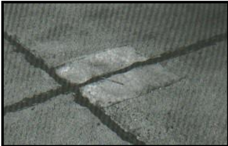
Figura 35. "Parche pequeño de baja severidad" (20) .
