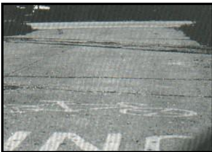
Figura 46. “Cruce de vía férrea de severidad media” (20) .
