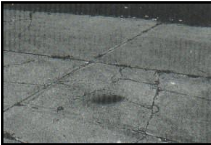
Figura 16. "Losa dividida de alta severidad" (20) .
