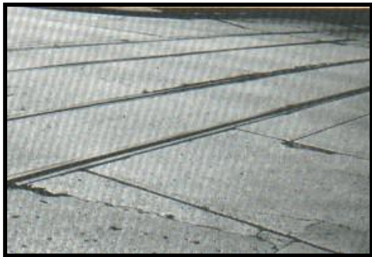
Figura 45. “Cruce de vía férrea de baja severidad” (20) .
