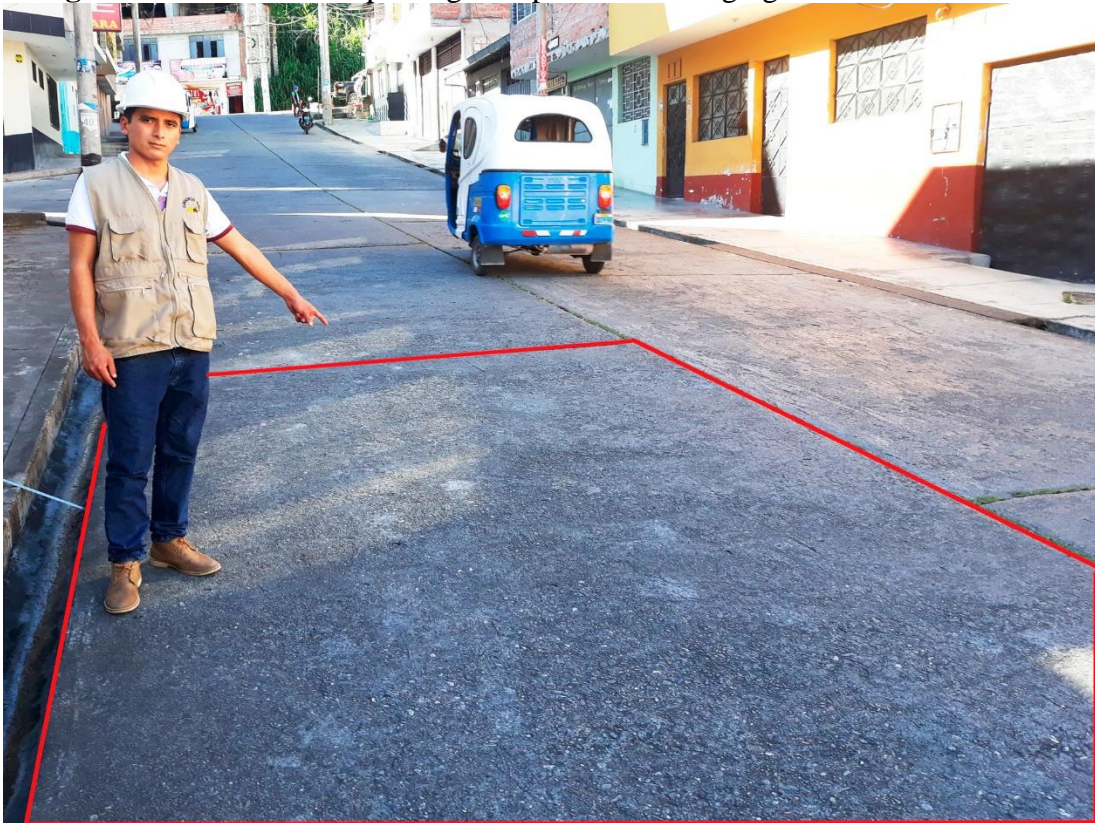
Fotografía 6. Se observa la patología de pulimento de agregados en la UM – 05.
