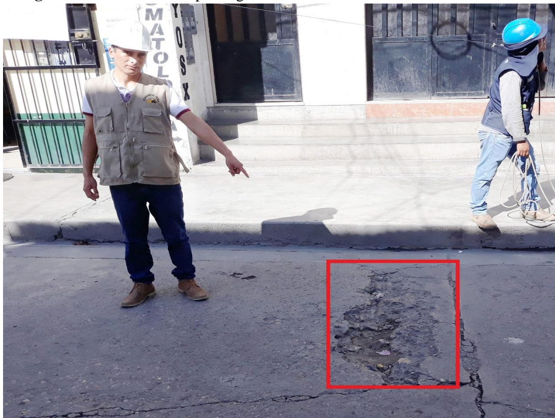
Fotografía 15. Se observa la patología de desconchamiento en la UM – 03.
