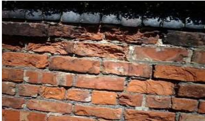
Imagen 15: Erosión en muros.
