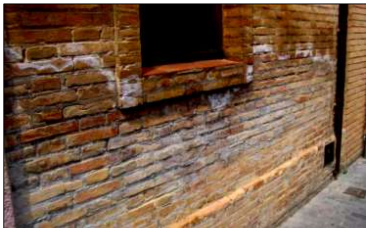
Imagen 14: Humedad en estructura.
