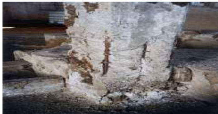
Imagen 6: Carbonatación del Hormigón
