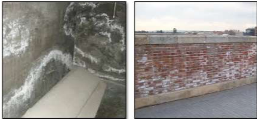
Imagen 19: Eflorescencia en estructuras
