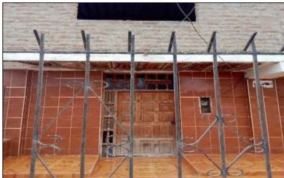
Imagen 4: Patologías en la losa aligerada
