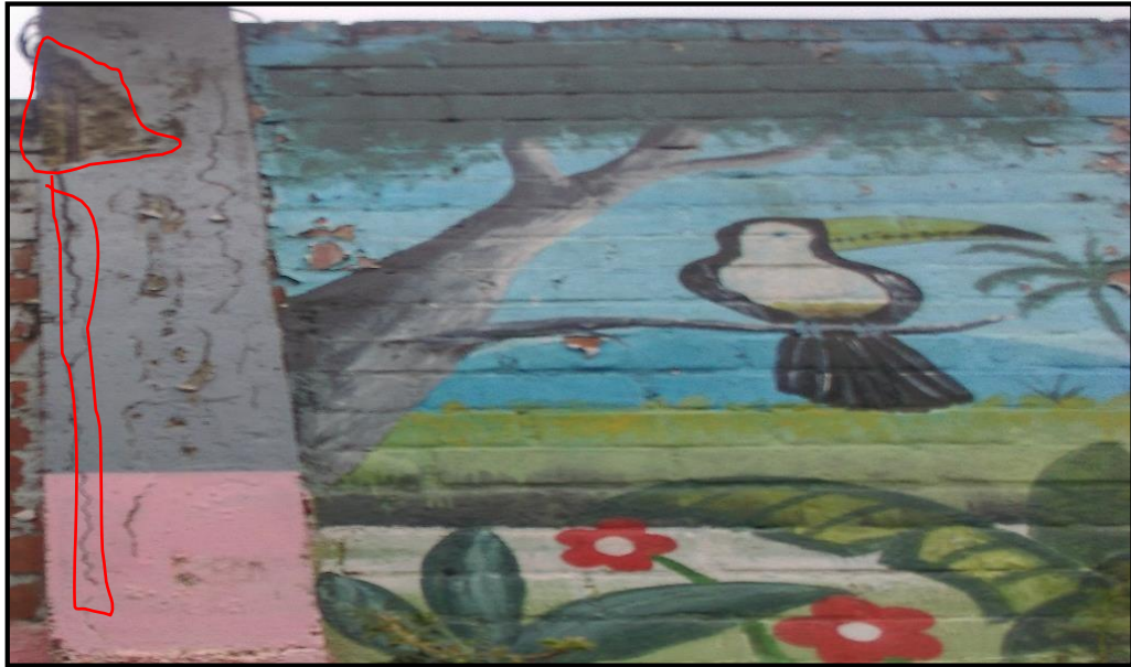
figura 68. Evidencia de la muestra 02, paño 09- interno se observa las patologías corrosión, fisura vertical y descascaramiento.
