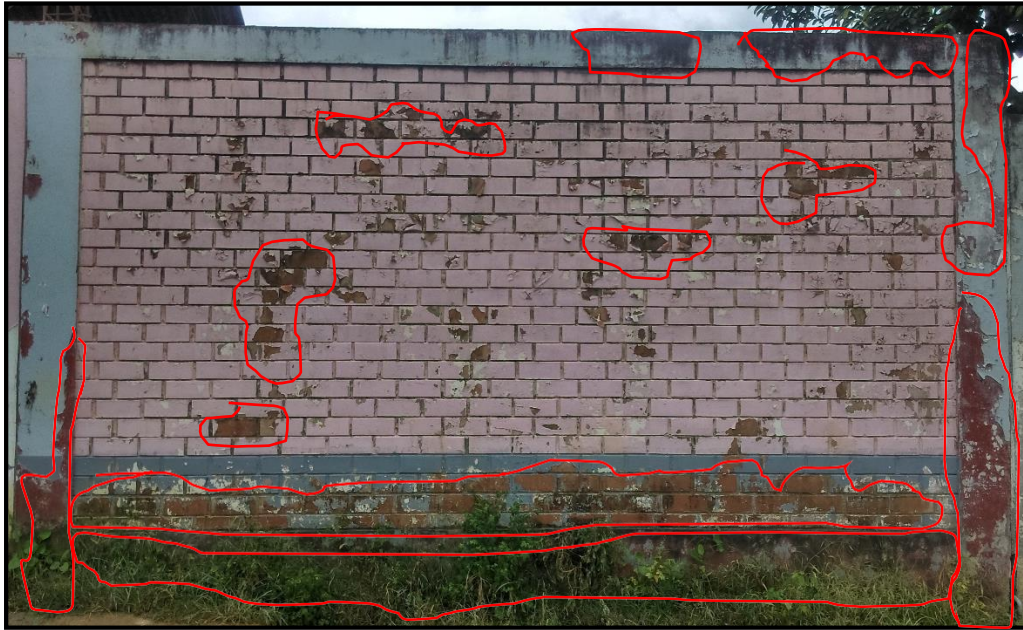
figura 58. Evidencia de la muestra 02, paño 02 - externo se observa las patologías humedad de indescascamiento y descascamiento.
