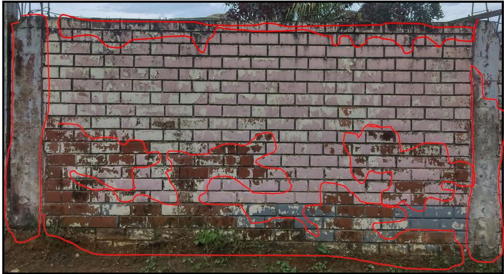
figura 60. Evidencia de la muestra 02, paño 05 – externo se observa las patologías de eflorescencia y descascaramiento.
