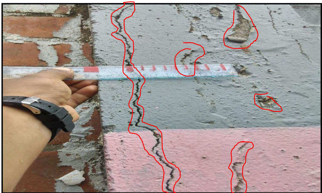
figura 69. Evidencia de la muestra 02, paño 11- interno se observa las patologías fisura vertical y descascaramiento.
