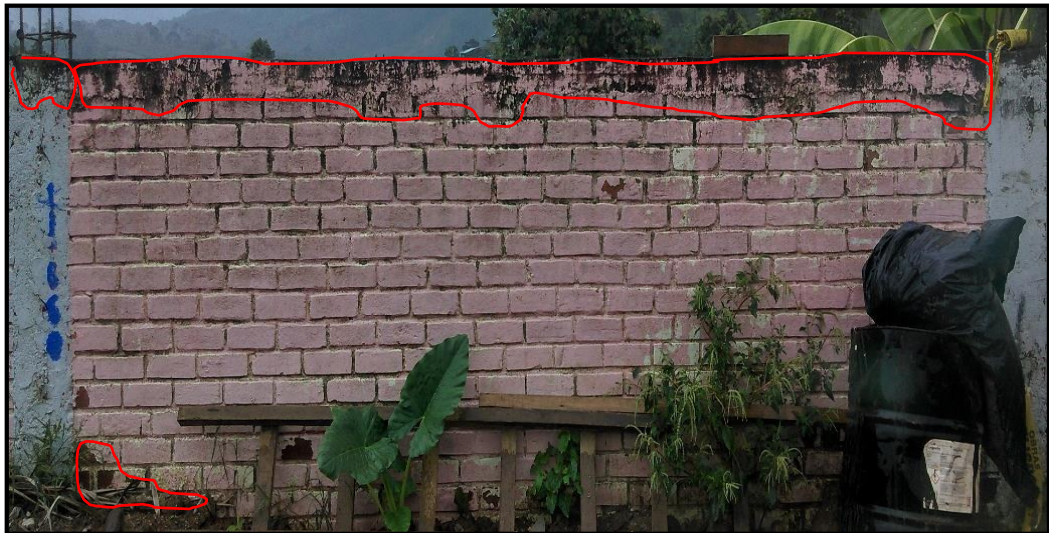
figura 56. Evidencia de la muestra 01, paño 05 - externo se observa las patologías de eflorescencia y desintegración.
