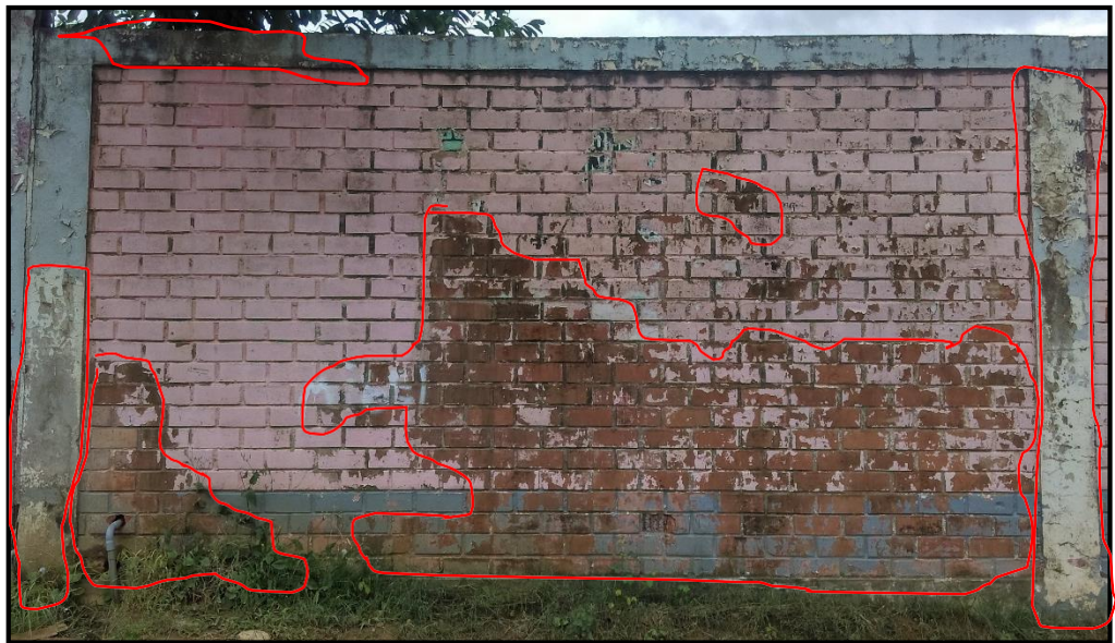
figura 59. Evidencia de la muestra 02, paño 03 - externo se observa las patologías descascamiento y eflorescencia.
