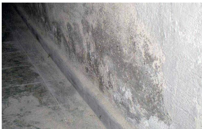
figura 8. Descaramiento en muro.
