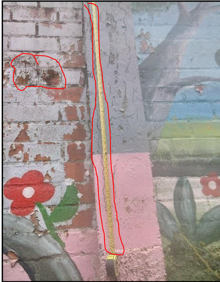
figura 66. Evidencia de la muestra 02, paño 02- interno se observa las patologías descascamiento y fisura.
