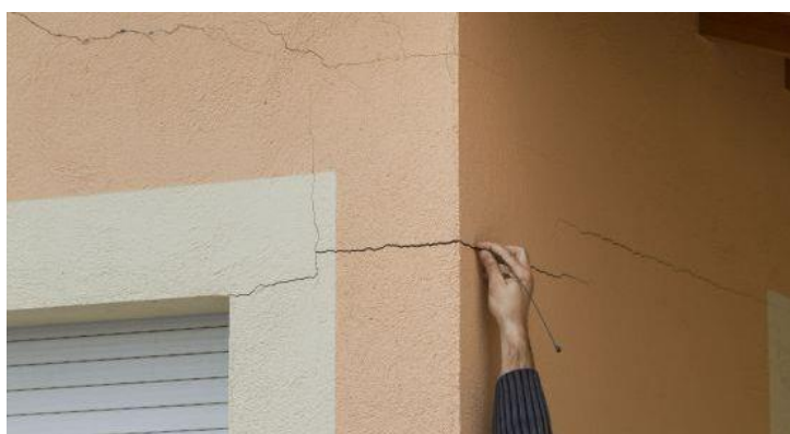
figura 7. Fisuras en muros.
