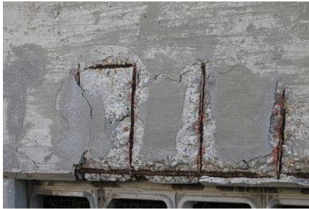
figura 9. Oxidación y corrosión. Fuente: Broto C. (1985).
