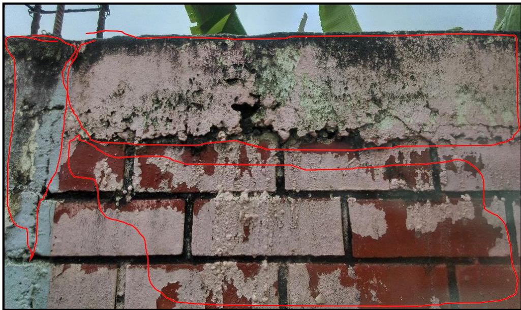
figura 65. Evidencia de la muestra 02, paño 03- interno se observa las patologías de desintegración, descascamiento y eflorescencia.
