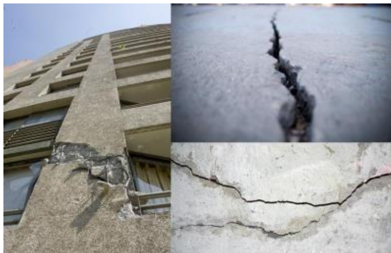
figura 4. Fisuras patológicas. Fuente: Chile C. (2010).
