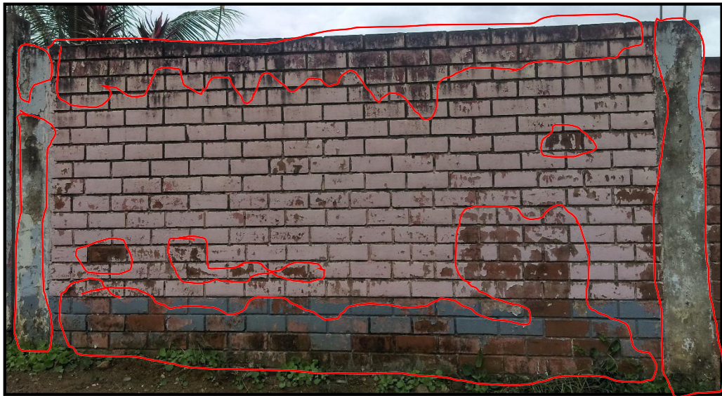
figura 61. Evidencia de la muestra 02, paño 07 - externo se observa las patologías de descascaramiento y eflorescencia.
