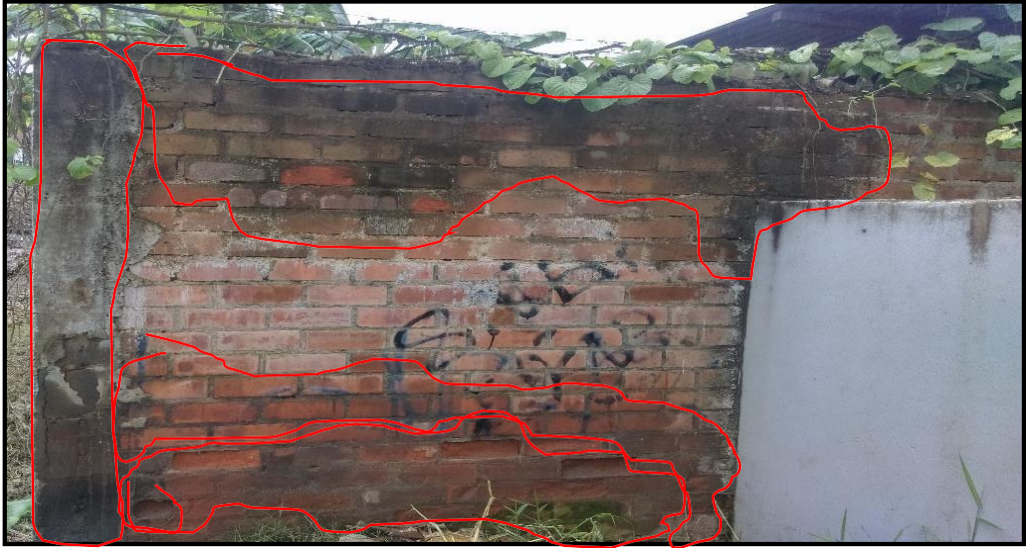
figura 70. Columna afectada por eflorescencia, muros por erosión, M3, paño 01- externo.
