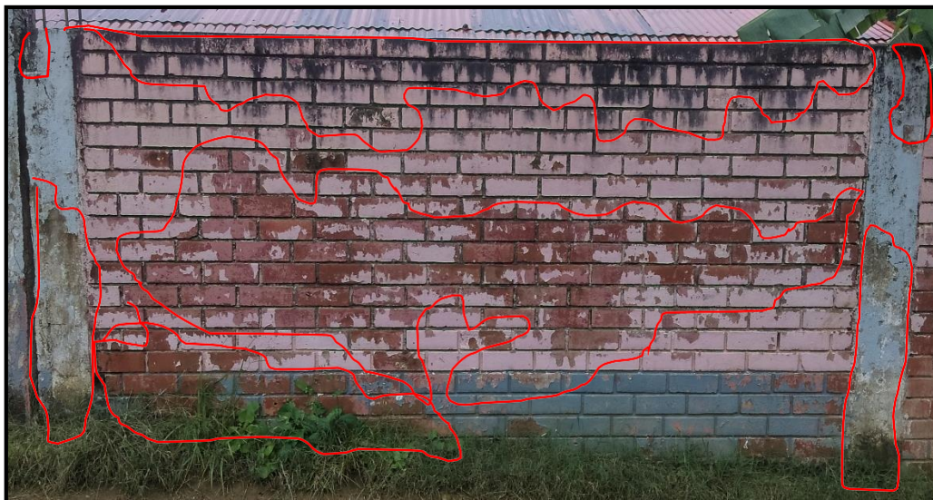
figura 63. Evidencia de la muestra 02 - externo, paño 11 se observa las patologías de descascaramiento y eflorescencia.
