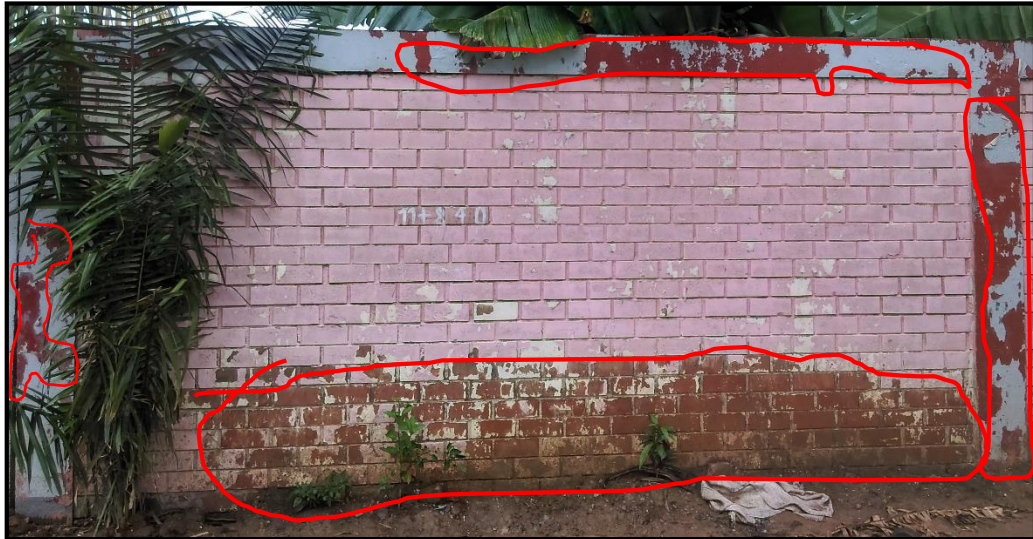
figura 55. Evidencia de la M1, paño 02 - externo se observa las patologías de eflorescencia y descascaramiento.
