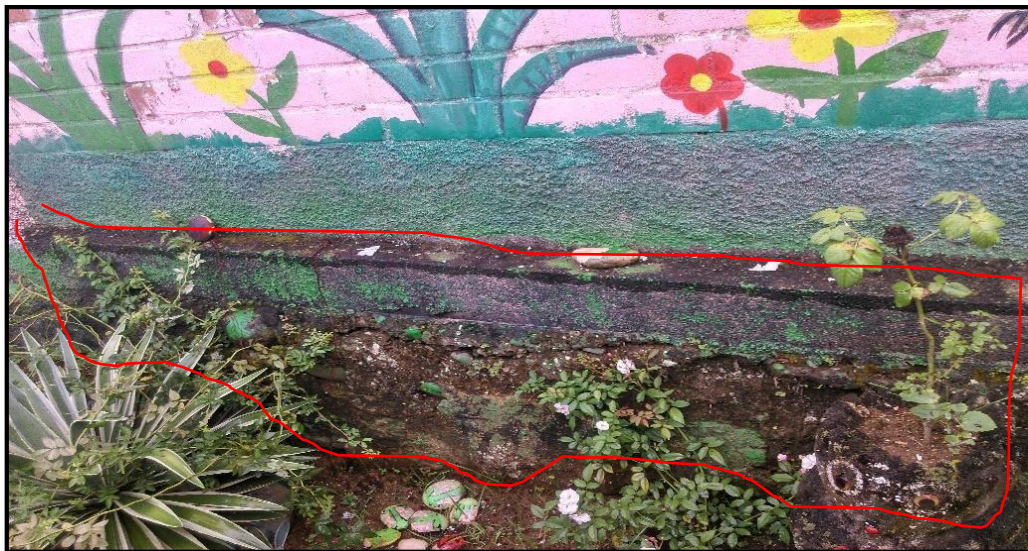
figura 67. Evidencia de la muestra 02, paño 07- interno se observa las patologías desintegración.
