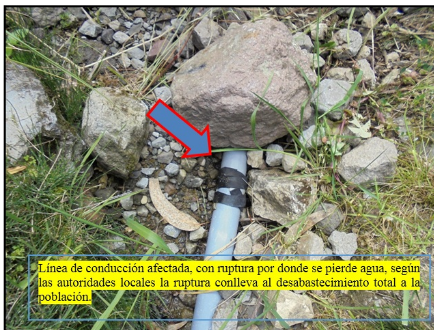
Figura 4.5: Fíjese el Estado de la Tubería en Línea de Conducción
