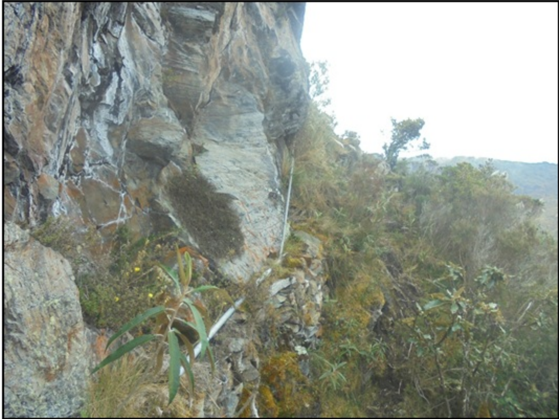
Figura 4.20: Vista de Tubería Expuesta en Línea de Conducción
