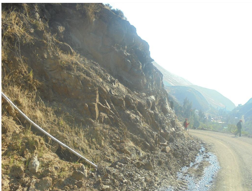
Foto 02: Aquí podemos observar la línea de conducción del sistema de agua potable de la localidad de Ayahuanco.
