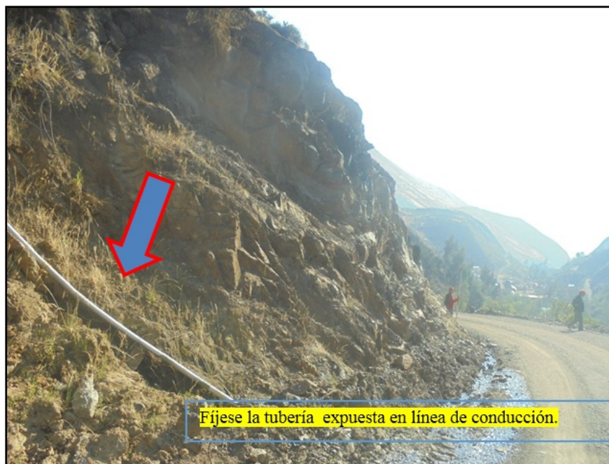
Figura 4.4: Fíjese El Estado de la Tubería en Línea De Conducción
