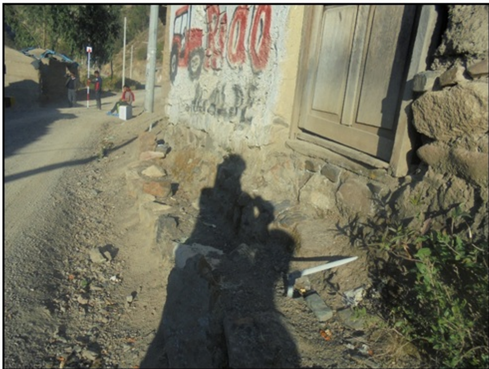
Figura 4.9: Vista de Conexiones Domiciliarias Expuestas.
