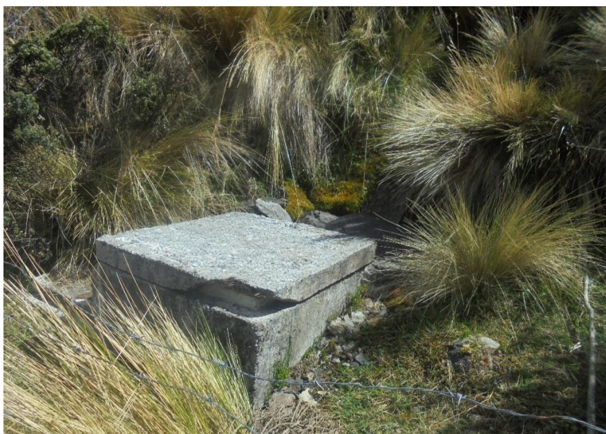
Foto 01: En esta toma fotográfica se observa la cámara de rompe presión en la localidad de Ayahuanco.
