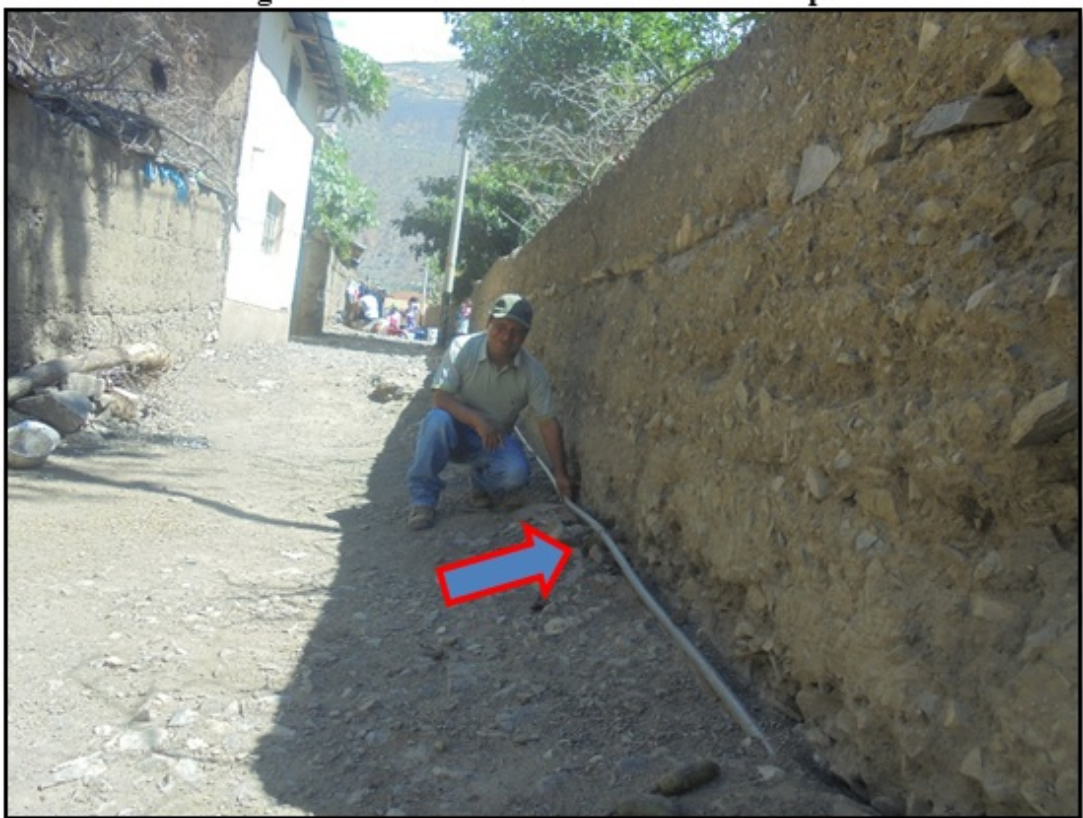
Figura 4.15: Vista de Red de Distribución Expuesta
