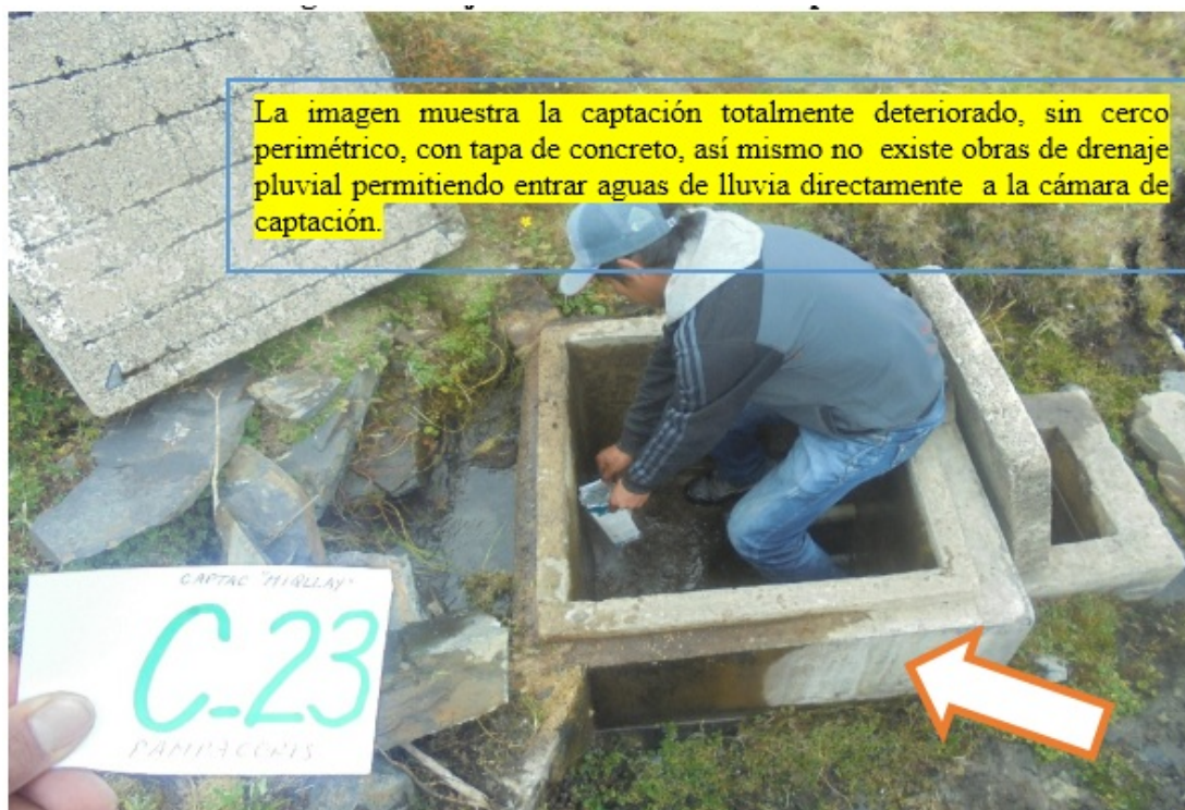
Figura 4.19: Fíjese el Estado de da Captación
