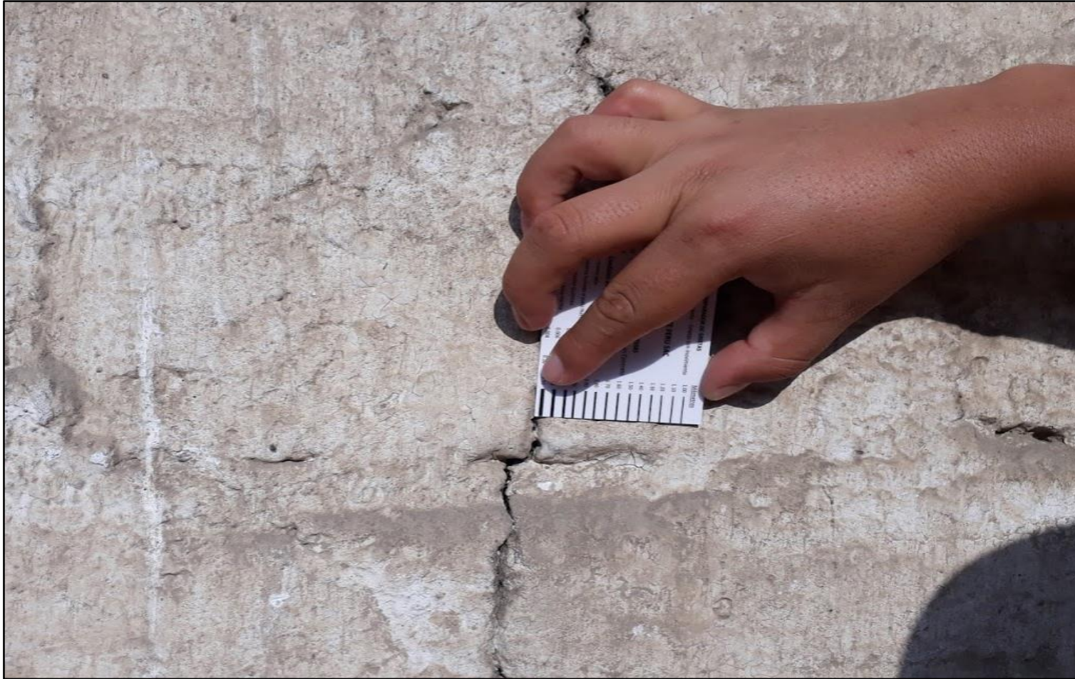
Fotografía 07. Muro afectado por grieta en la unidad muestral 09 con un ancho de 3.50 mm y un nivel de severidad alto, medida con un medidor de fisuras y grietas (fisurómetro).
