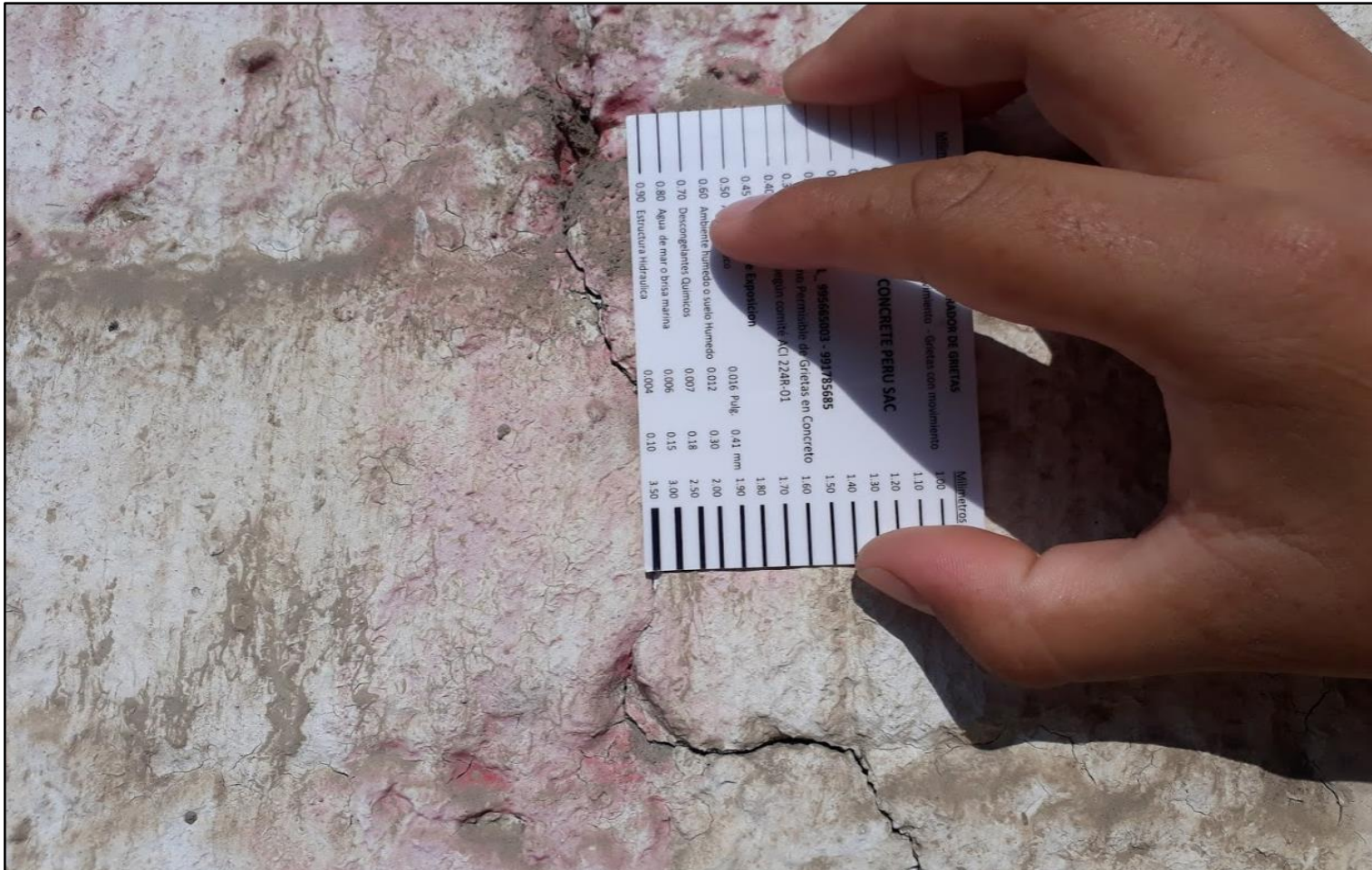
Fotografía 08. Muro afectado por grieta en la unidad muestral 08 con un ancho de 3.50 mm y un nivel de severidad alto, medida con un medidor de fisuras y grietas (fisurómetro).
