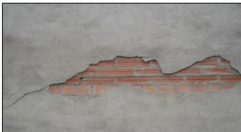
Figura 17. Desprendimiento en muro de albañilería.
