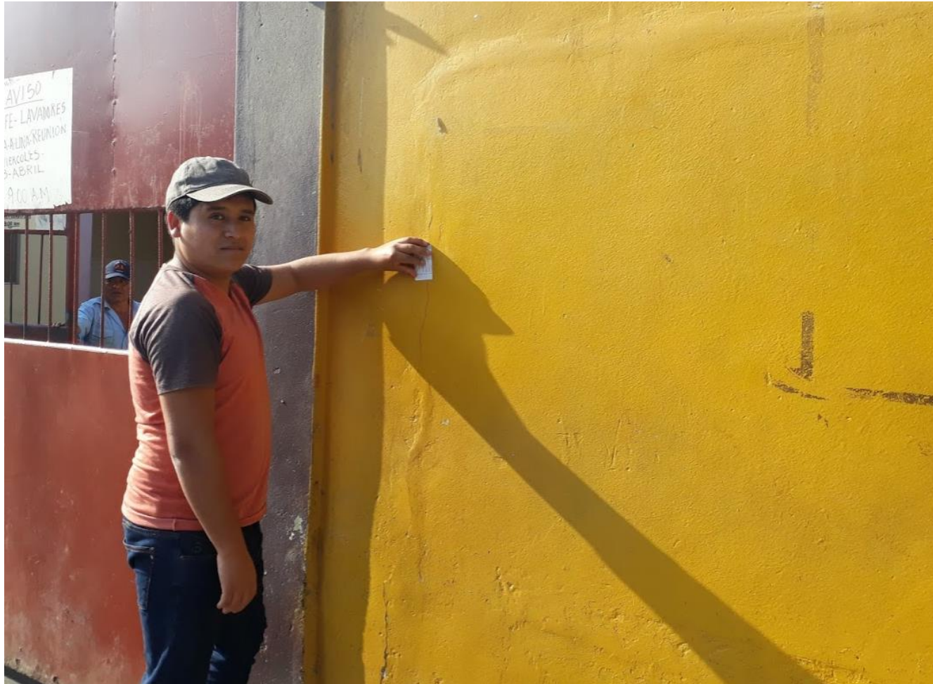
Fotografía 14. Muro afectado por fisura en la unidad muestral 03 con un ancho de 0.30 mm y un nivel de severidad medio, medida con un medidor de fisuras y grietas (fisurómetro).
