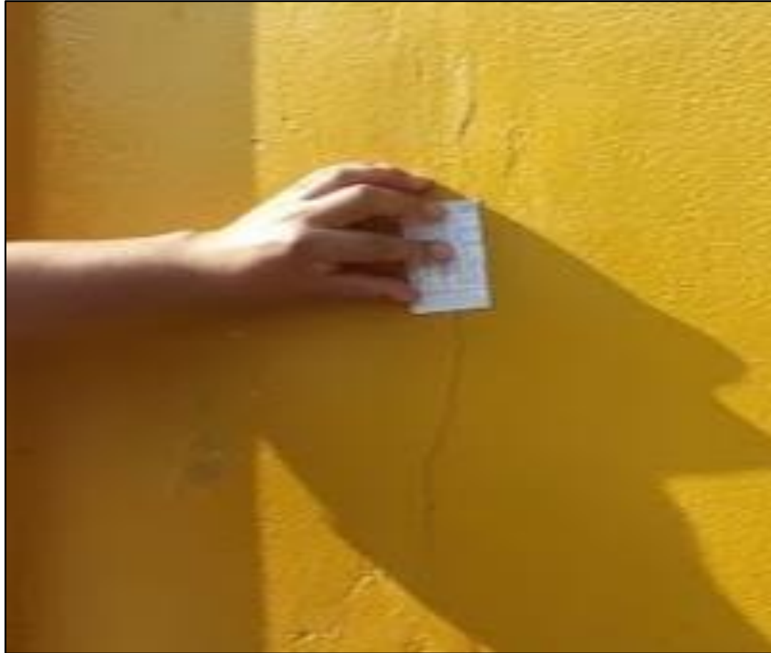
Fotografía 10. Muro afectado por fisura en la unidad muestral 03 con un ancho de 0.30 mm y un nivel de severidad medio, medida con un medidor de fisuras y grietas (fisurómetro).
