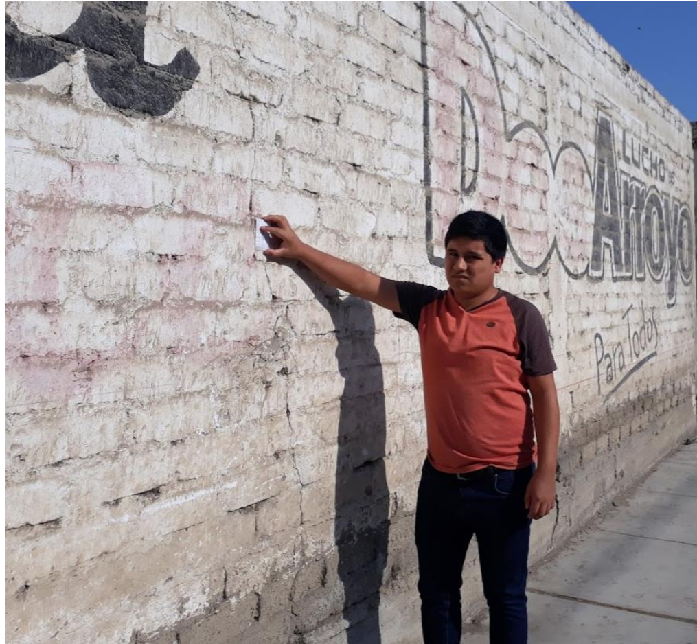
Fotografía 16. Muro afectado por grieta en la unidad muestral 08 con un porcentaje de área afectada de 2.68% y un nivel de severidad alto.
