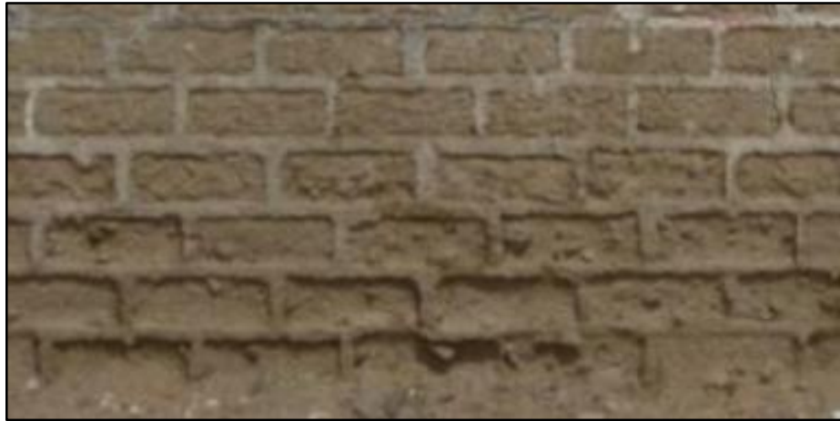
Figura 14. Patología disgregación en muro.
