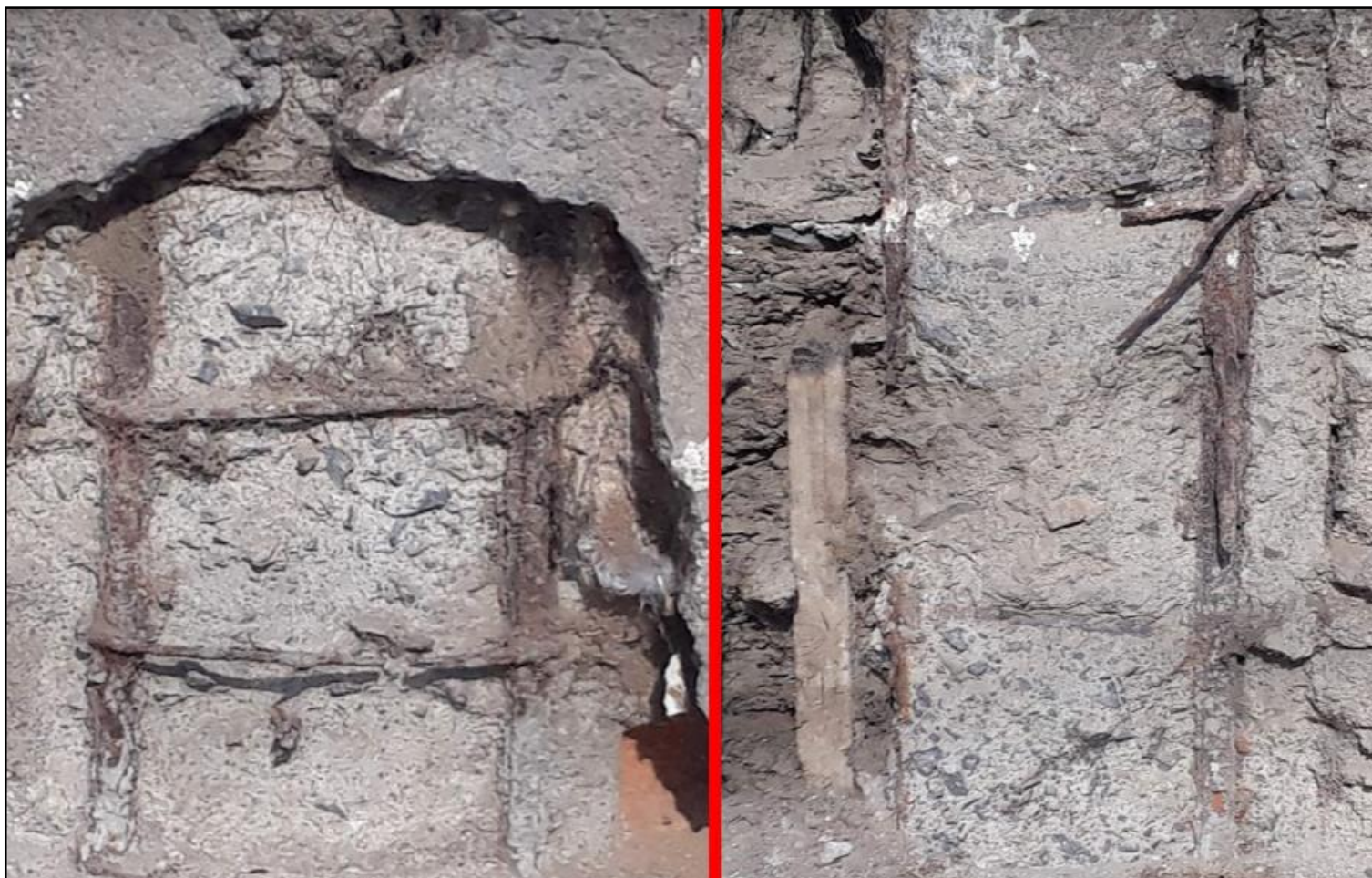
Fotografía 06. Columnas afectadas por corrosión en la unidad muestral 18 (columna 50) y 11 (columna 31) con un porcentaje de área afectada de 11.54% y 23.08 % respectivamente con un nivel de severidad alto.
