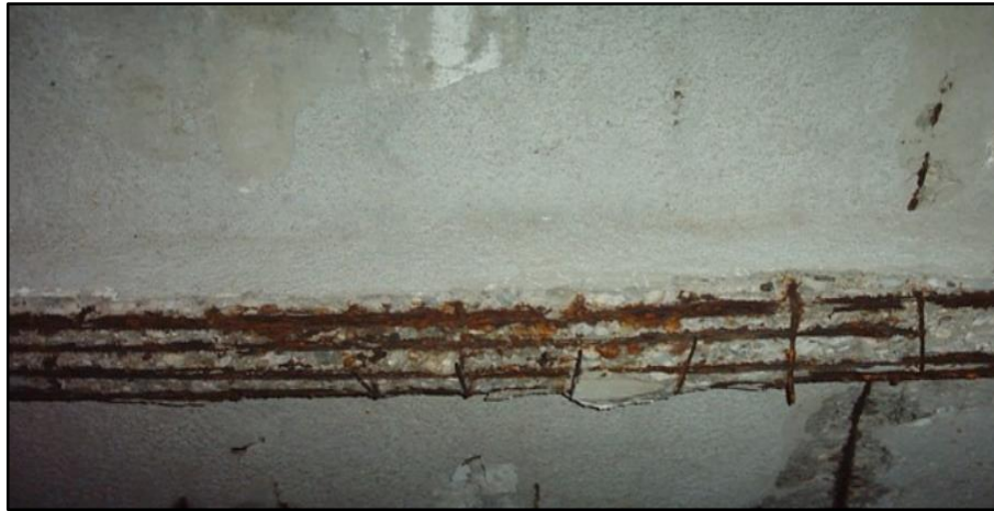
Figura 18. Corrosión en la armadura de acero.
