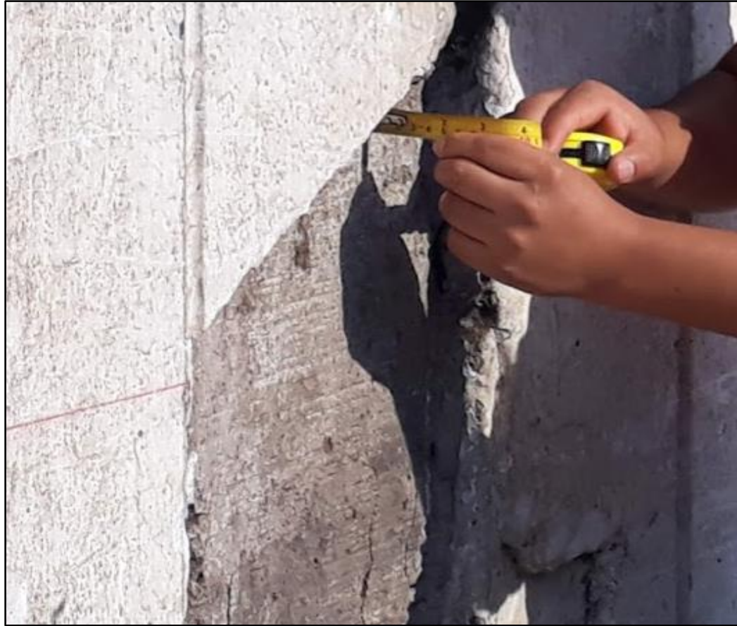
Fotografía 12. columna afectada por desprendimiento en la unidad muestral 14, con un área afectada de 6.76% y un nivel de severidad medio, tarrajeo presenta espesor fuera de lo reglamentario 2.5 cm.
