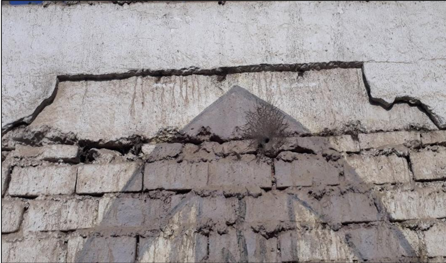
Fotografía 11. Viga afectada por desprendimiento en la unidad muestral 15, con un área afectada de 18.78% y un nivel de severidad medio.
