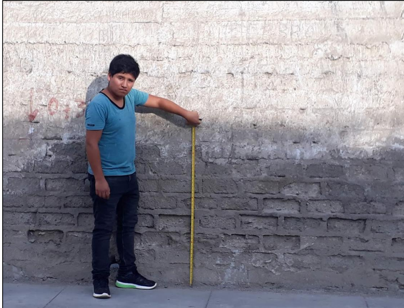
Fotografía 17. Toma de medidas de la patología disgregación en muro de la unidad muestral 10.
