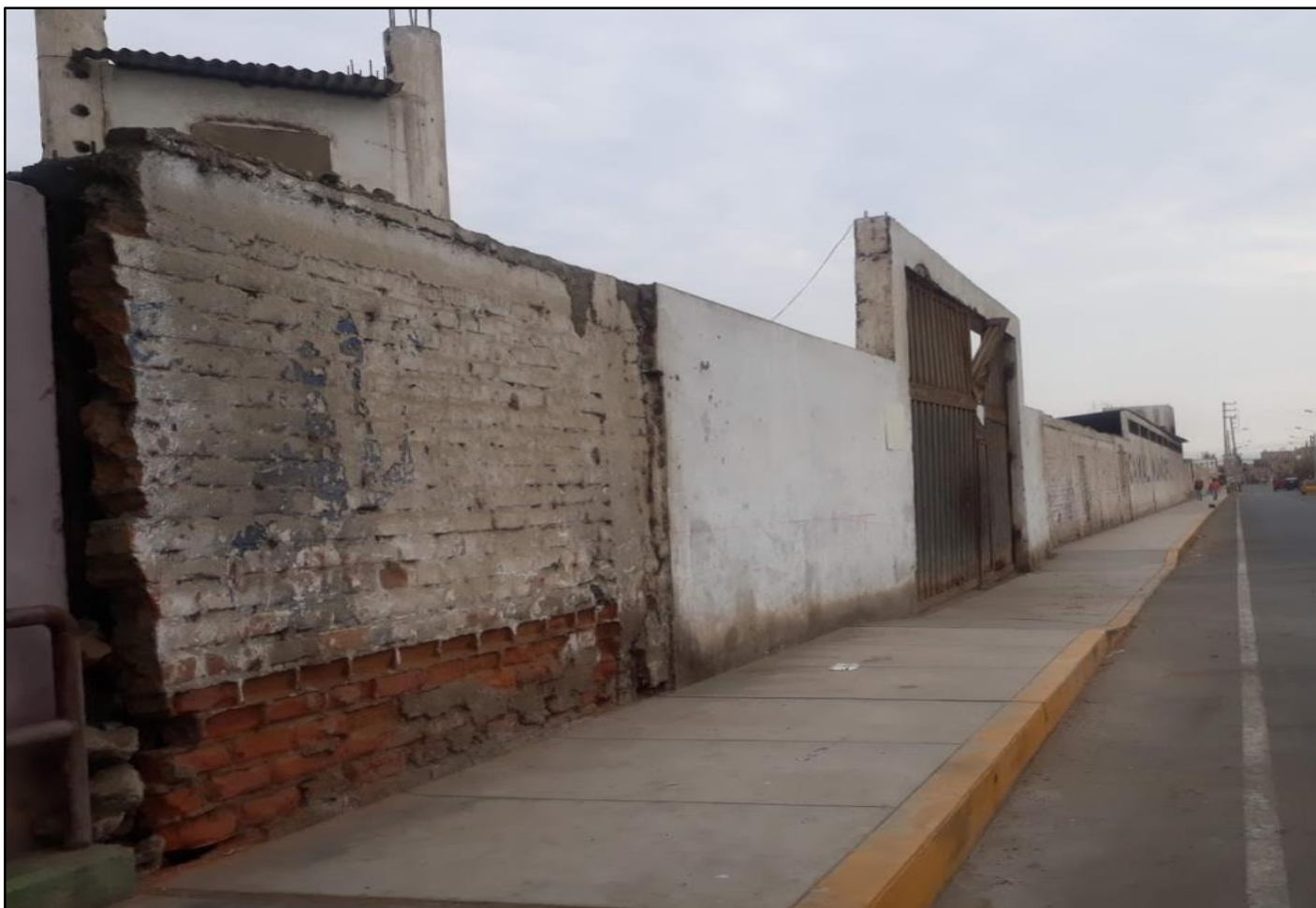
Fotografía 03. Vista del cerco perimétrico exterior del eje 2 - 2 del camal municipal del distrito de Chimbote, provincia del Santa, región Áncash.
