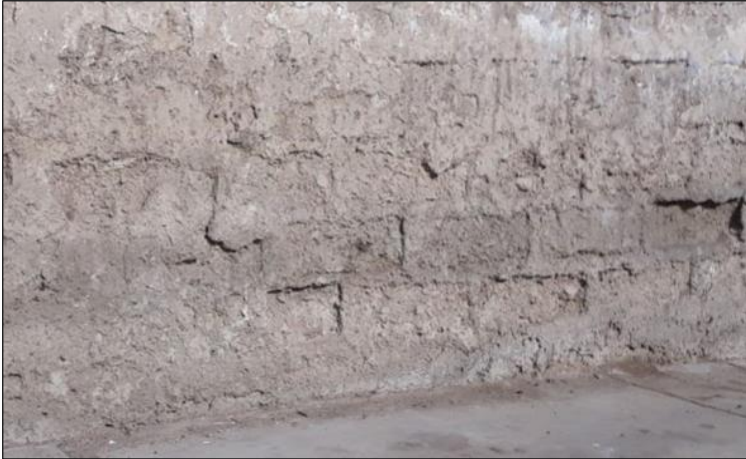
Fotografía 05. Muro afectado por disgregación en la unidad muestral 05 con un porcentaje de área afectada de 7.02% y un nivel de severidad medio.
