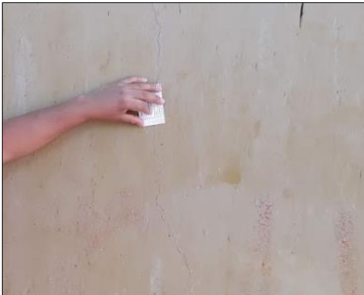
Fotografía 09. Muro afectado por fisura en la unidad muestral 02 con un ancho de 0.30 mm y un nivel de severidad medio, medida con un medidor de fisuras y grietas (fisurómetro).
