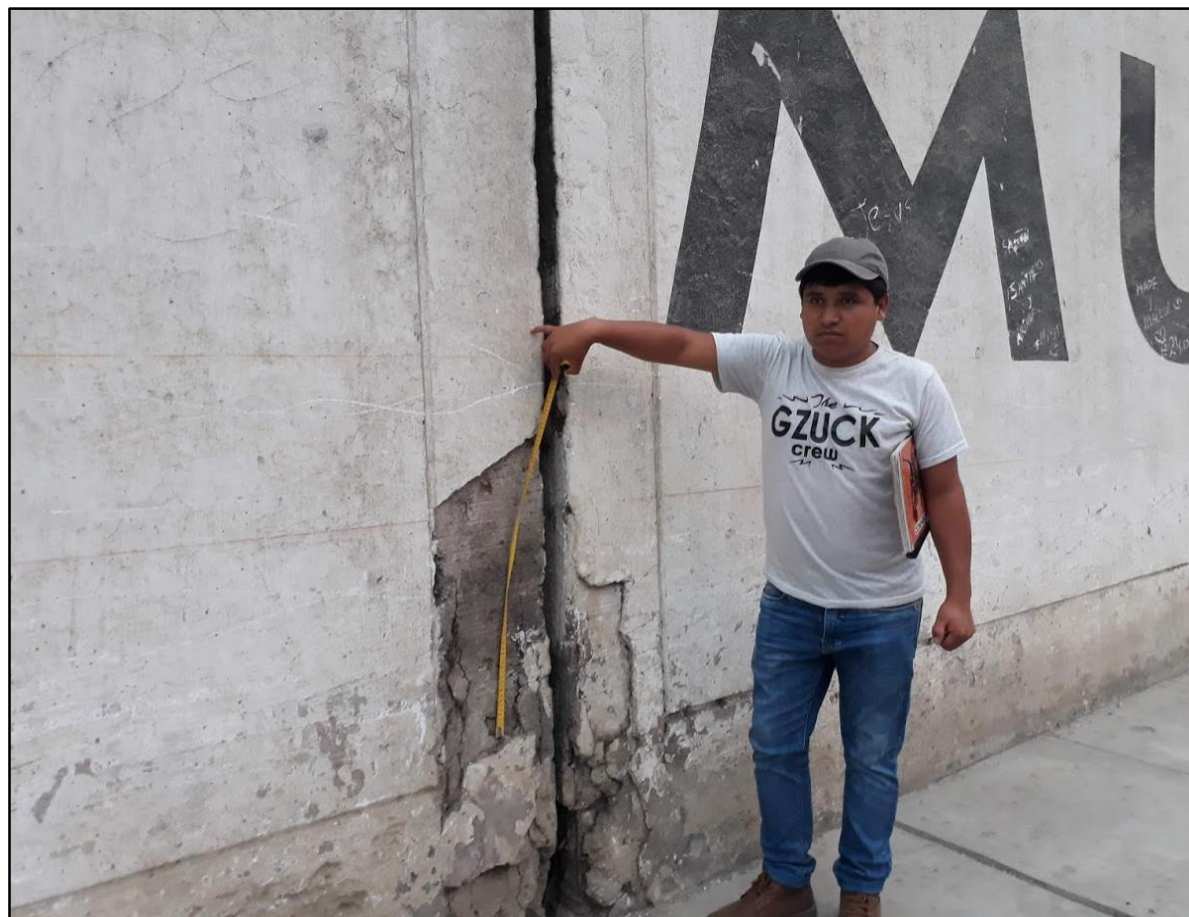
Fotografía 15. Columna afectada por desprendimiento en la unidad muestral 15 con un porcentaje de área afectada de 4.40% y un nivel de severidad medio.
