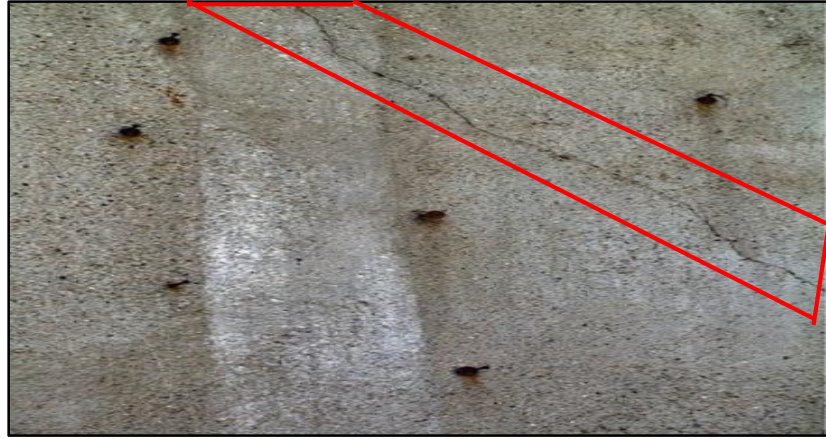
Figura 16. Fisura en elemento de concreto.
