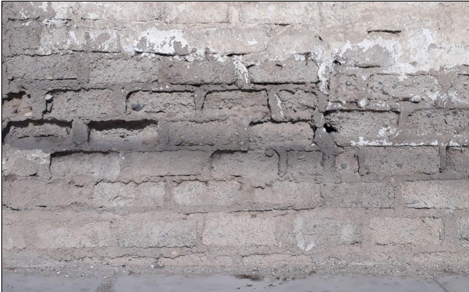
Fotografía 04. Muro afectado por disgregación en la unidad muestral 09 con un porcentaje de área afectada de 31.92% y un nivel de severidad alto.
