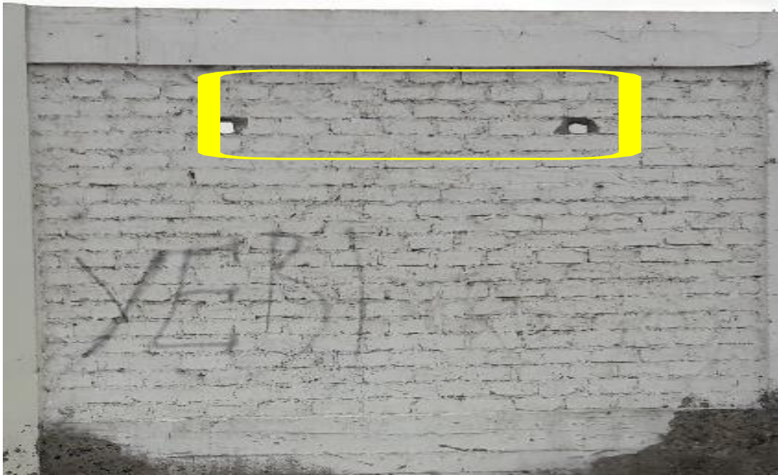
Fotografía 11: Patología Desintegración que afecta el muro en la Unidad Muestral-11.
