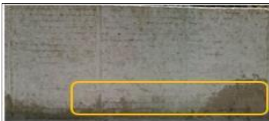
Imagen 11: Presencia de Eflorescencia, Fuente: Elaboración propia (2016).
