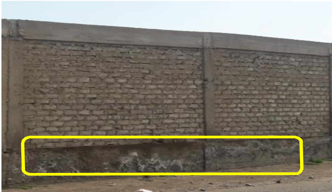
Fotografía 03: Patología Eflorescencia que afecta el muro en la Unidad Muestral-12.
