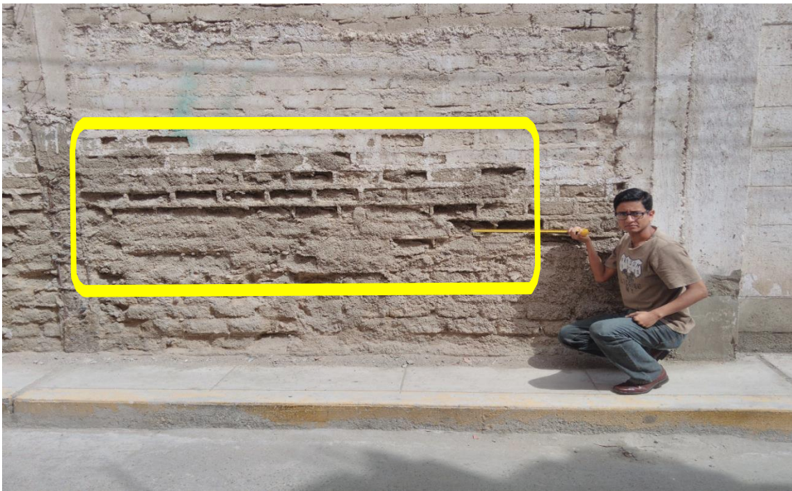
Fotografía 06: Patología Erosión que afecta al muro de la Unidad Muestral-15
