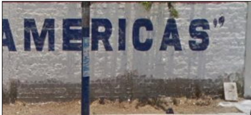
Imagen 09: Presencia de Erosión en muro de albañilería, Fuente: Elaboración propia (2016).
