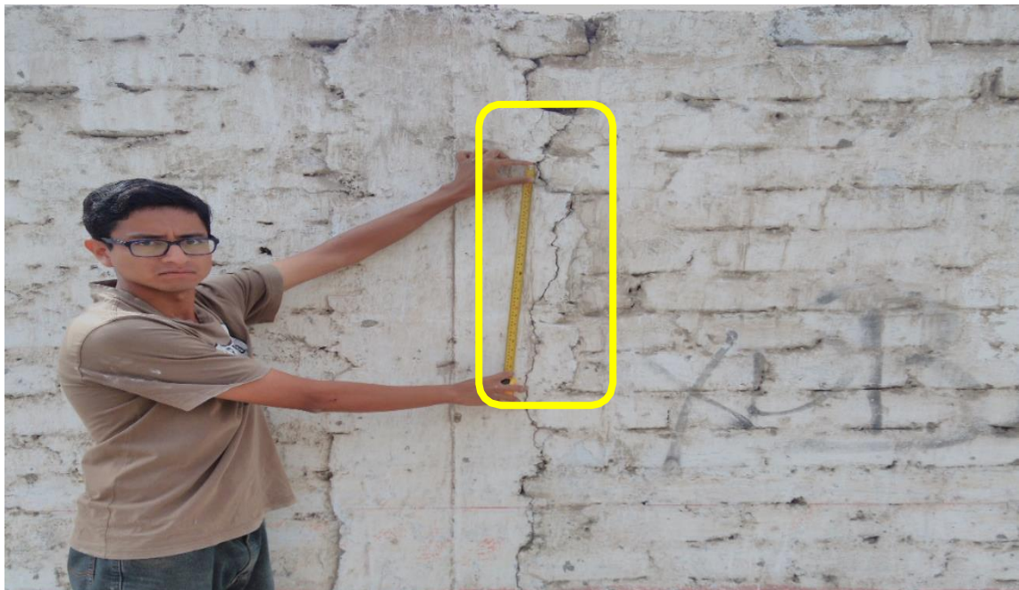
Fotografía 08: Patología Fisuras que afecta a la columna de la Unidad Muestral-04.
