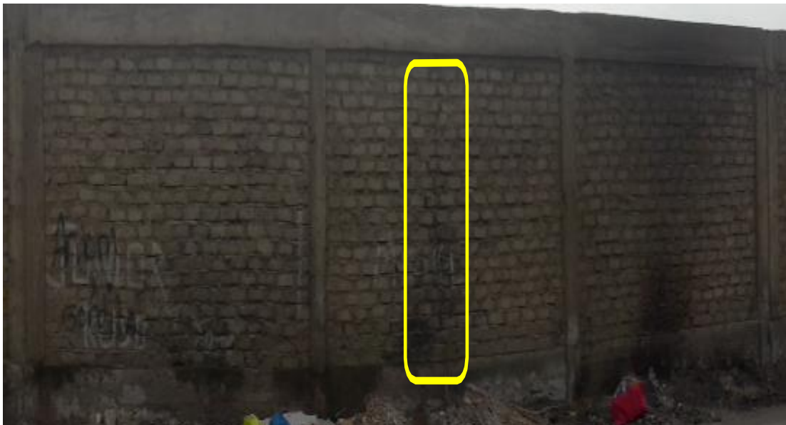
Fotografía 12: Patología Grietas que afecta a la columna de la Unidad Muestral-07.
