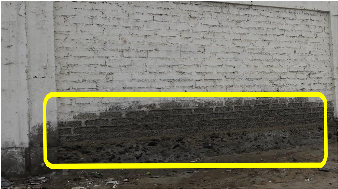
Fotografía 05: Patología Erosion que afecta al muro de la Unidad Muestral-14.
