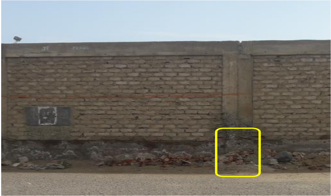
Fotografía 09: Patología Corrosión que afecta a la columna de la Unidad Muestral-15.
