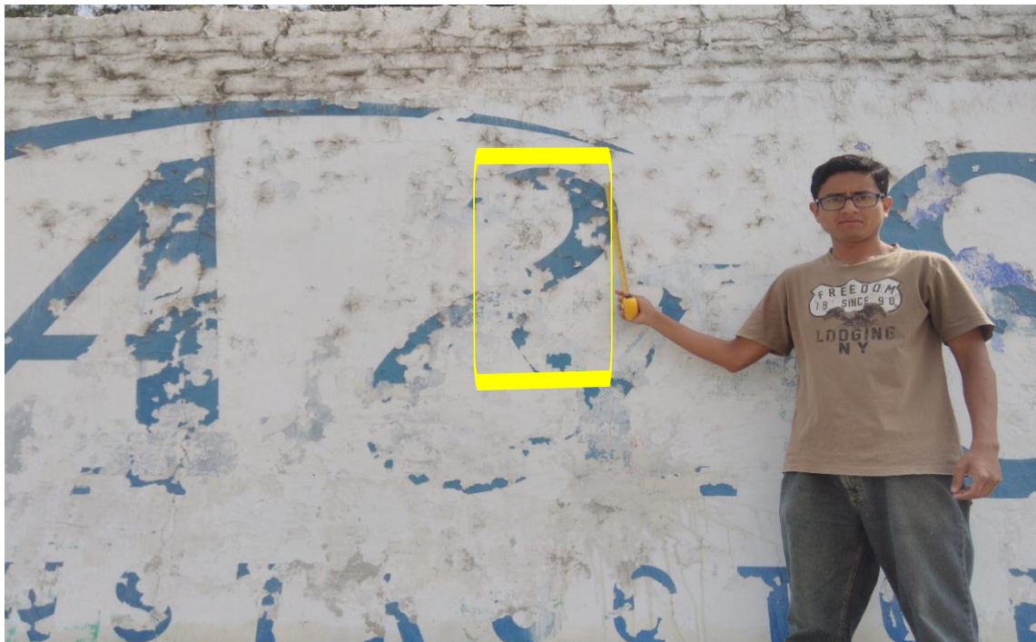
Fotografía 04: Patología Eflorescencia que afecta la columna de la Unidad Muestral-19.
