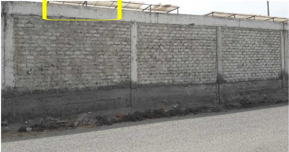
Fotografía 07: Patología Fisura que afecta el muro en la Unidad Muestral-10.
