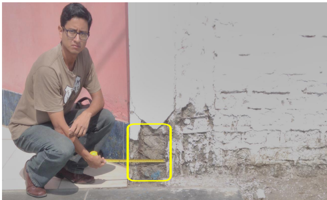
Fotografía 10: Patología Corrosión que afecta a la columna de la Unidad Muestral-02
