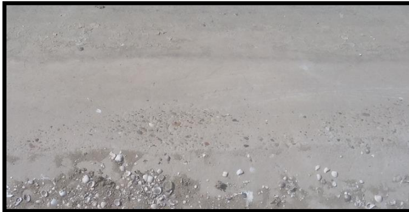
Imagen N° 10: Perdida de agregados
