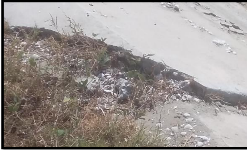
Imagen N° 9: Rotura en bloque de un canal
