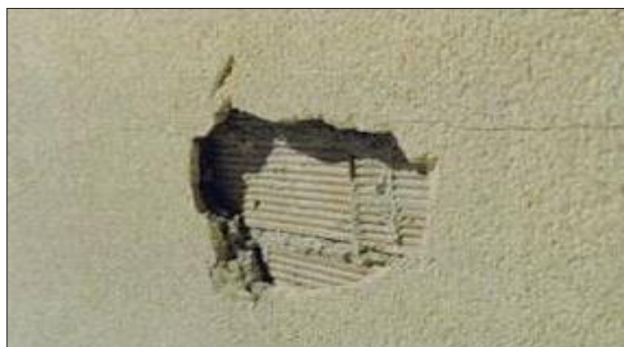
Imagen 13: Desprendimiento. – Fuente: Sepúlveda M. 47
