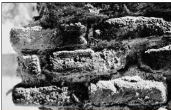
Imagen 10: Erosión. – Fuente: Broto C. 42
