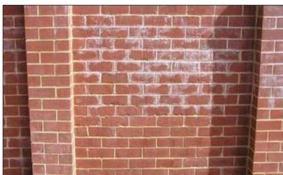
Imagen 14: Eflorescencia. – Fuente: Broto C. 42
