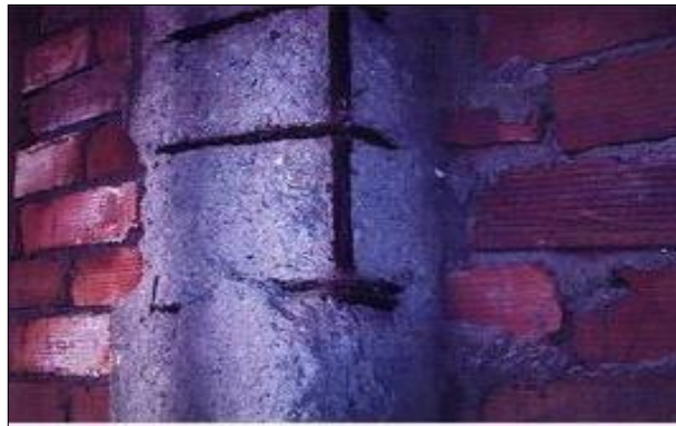
Imagen 15: Corrosión. – Fuente: Sepúlveda M. 47
