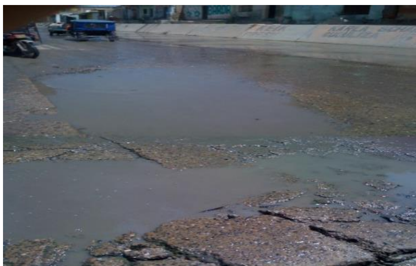
Figura 08. Patología -Canal Vía Tramo Entre: Tarapacá y Piura. Fuente: Tesis - Identificar y diagnosticar las patologías de las losas de concreto del canal vía tramo entre las transversales Tarapacá Universidad Uladech
