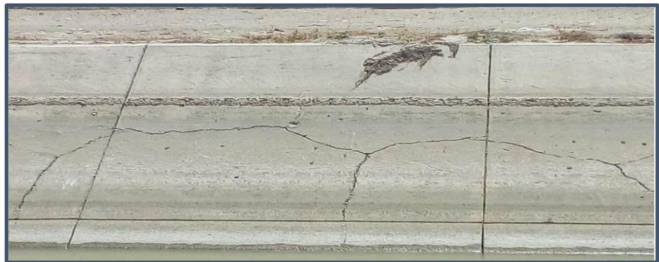
Figura 06. Patología – Grieta. Canal Biaggio Arbulú
