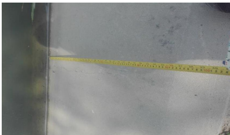
Figura 24. Fisura – Canal San Seminario Fuente: Elaboración Propia (2018)
