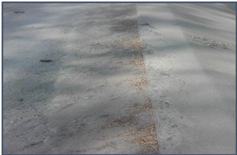
Figura 33. Descascaramiento en el Canal San Seminario Fuente: Elaboración propia (2018)
