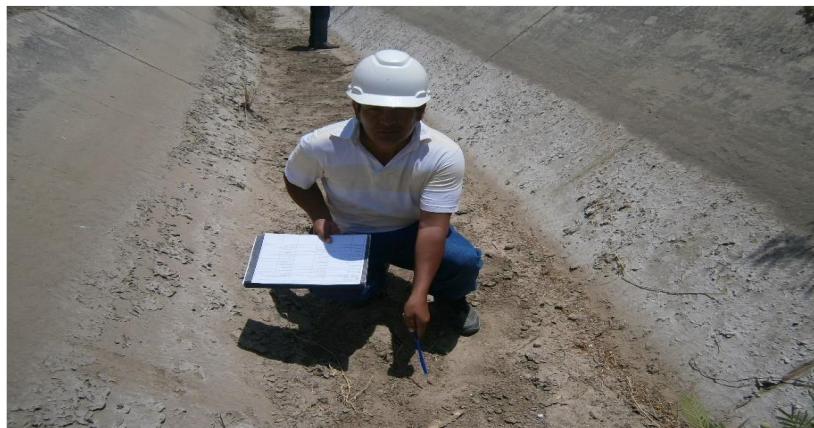
Figura 32. Sedimentos - Canal San Seminario Fuente: Tesis - Determinación y Evaluación de las Patologías del Concreto en el Canal de Riego T-52 Universidad Uladech
