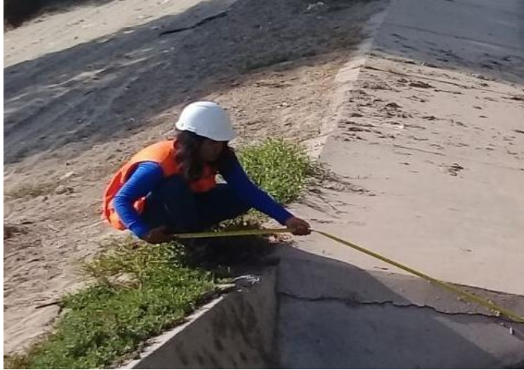
Figura 25. Grieta – Canal San Seminario Fuente: Elaboración Propia (2018)
