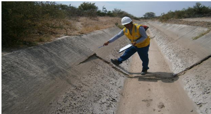
Figura 27. Hundimiento. Fuente: Tesis - Determinación y Evaluación de las Patologías del Concreto en el Canal de Riego T-52 Universidad Uladech
