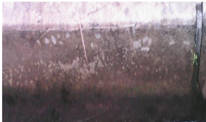
Figura 22. Patologías Fuente: Tesis Determinación y Evaluación de las Patologías del concreto en el canal de regadío Cabana – Universidad Uladech
