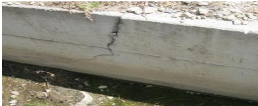
Figura 05. Patología – Grieta Longitud. Canal de irrigación Huapish Fuente: Tesis - Determinación y evaluación de las patologías del concreto en el canal de irrigación Huapish Universidad Uladech
