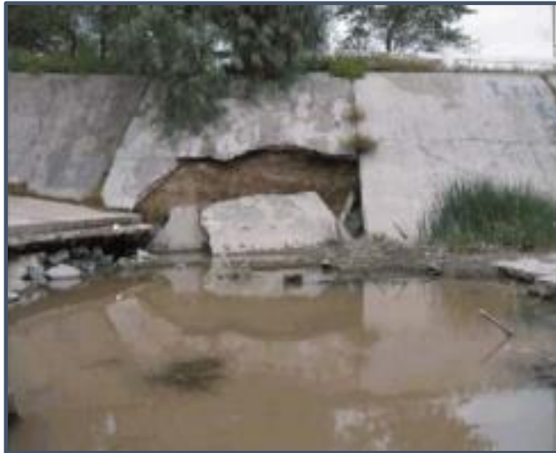
Figura 01. Patología Canal Maldonado Fuente: Congreso internacional sobre Patología y Recuperación de Estructuras. CINPAR
