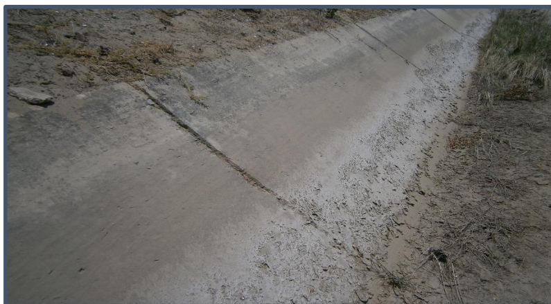
Figura 07. Patología – Sello de junta. Canal de Riego T-52
