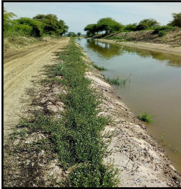
Imagen 25: Presencia de Vegetación y Sedimentos– Losa Izquierda Progresiva: 00+768 – 00+835 Fuente. Elaboración Propia, noviembre 2018
