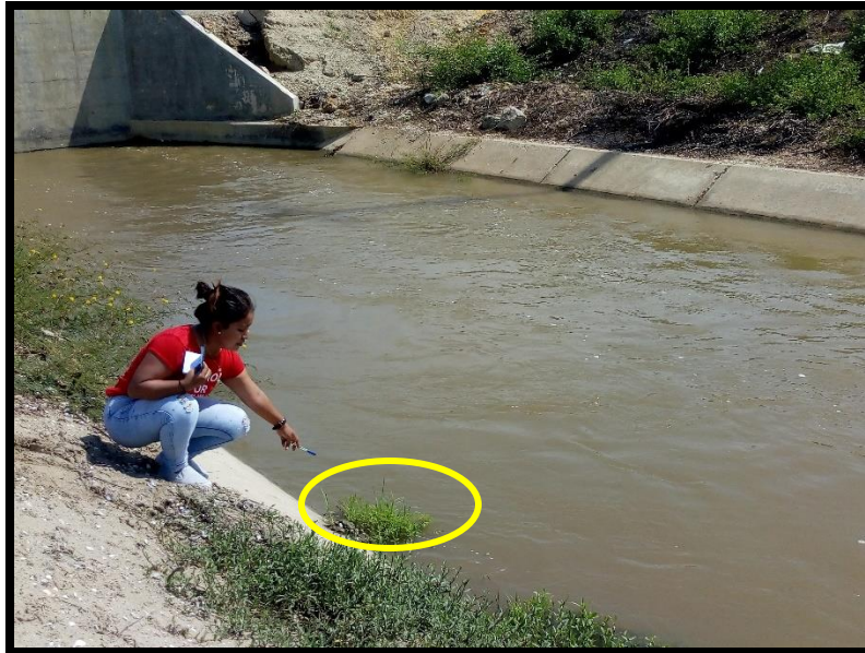
Imagen 19: Presencia de Vegetación en Losa Izquierda Progresiva: 00+500 – 00+567. Fuente: Elaboración Propia, noviembre 2018.
