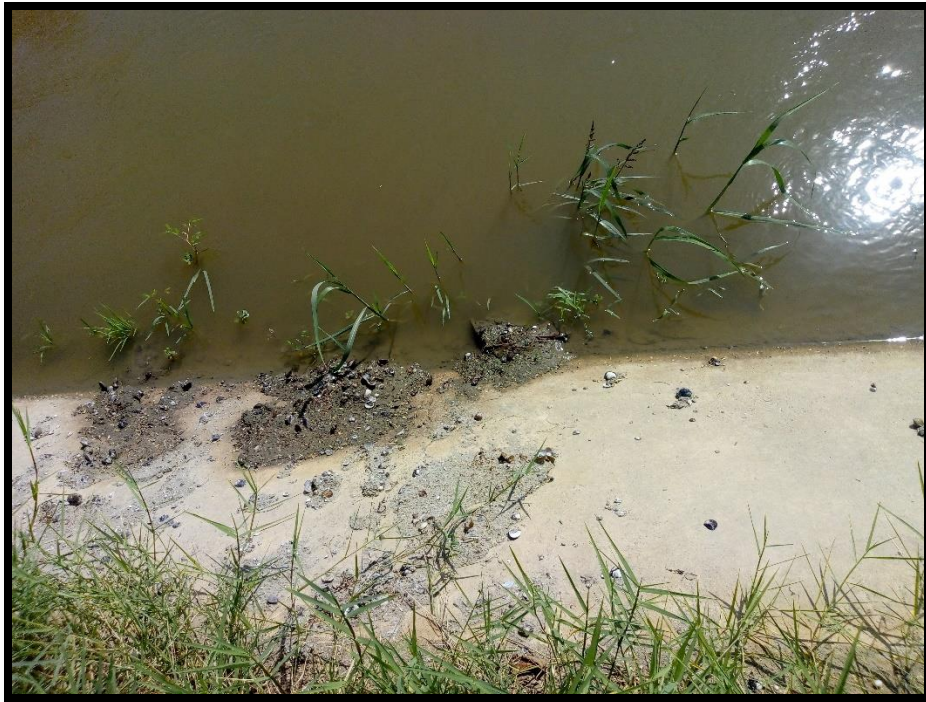
Imagen 35: Presencia de sedimentos y vegetación – Losa Izquierda Progresiva: 01+304 – 01+371 Fuente. Elaboración Propia, noviembre 2018
