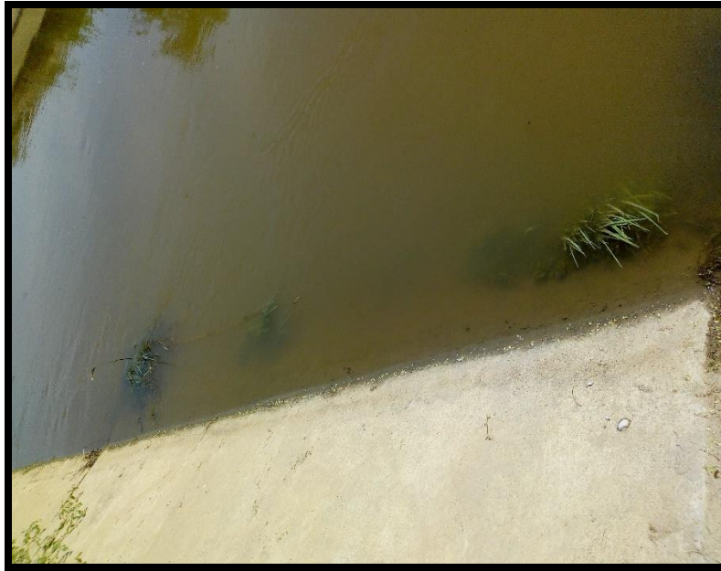
Imagen 23: Presencia de Vegetación – Losa Izquierda Progresiva: 00+634 – 00+701 Fuente. Elaboración propia, noviembre 2018
