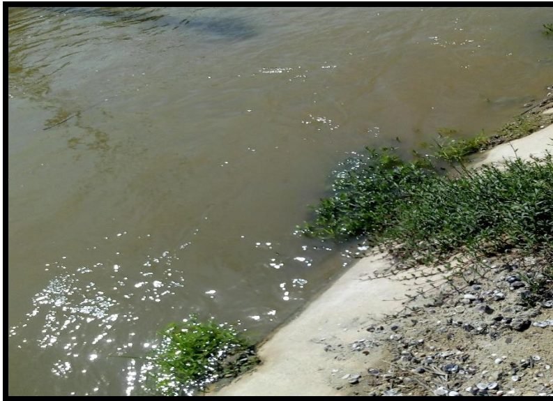
Imagen 27: Presencia de Vegetación - Losa de Izquierda Progresiva: 00+835 – 00+902 Fuente. Elaboración Propia, noviembre 2018
