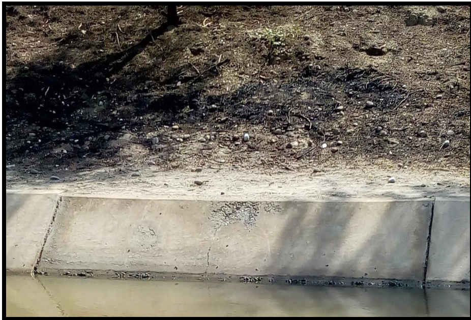
Imagen 36: Erosión y Fisuras – Losa Derecha Progresiva: 01+371 – 01+438 Fuente. Elaboración Propia, noviembre 2018
