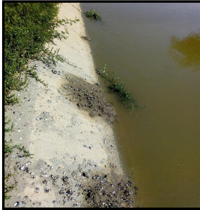
Imagen 21: Presencia de Sedimentos y Vegetación – Losa izquierda Progresiva: 00+567 – 00+634 Fuente. Elaboración Propia, noviembre 2018.
