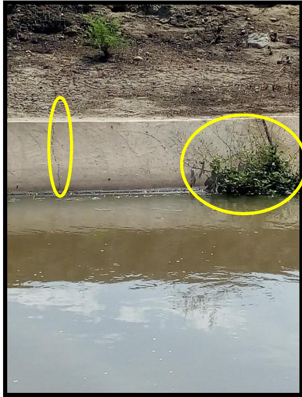
Imagen 33: Presencia de Vegetación y Fisuras – Losa Derecha Progresiva: 01+170 – 01+237
