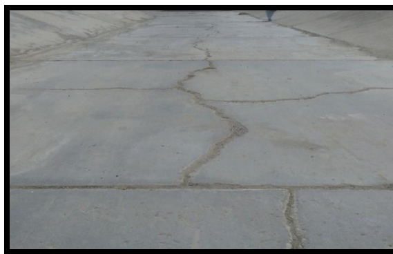
Imagen 12. Grietas en Concreto Fuente. Elaboración Propia, noviembre - 2018
