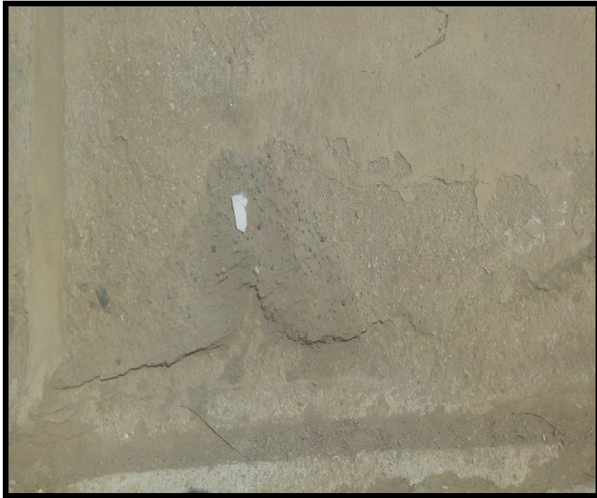
Imagen 29: Desprendimiento – Losa Izquierda Progresiva: 00+969 – 01+036 Fuente. Elaboración Propia, noviembre 2018
