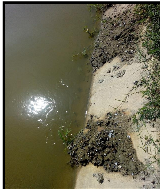
Imagen 26: Presencia de Sedimentos - Losa de Izquierda Progresiva: 00+835 – 00+902 Fuente. Elaboración Propia, noviembre 2018
