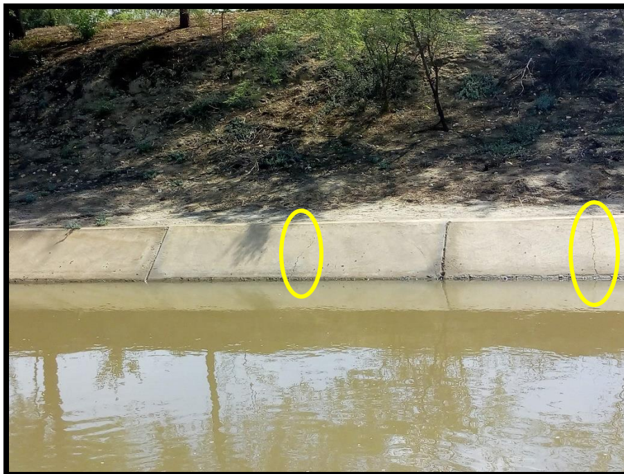
Imagen 22: Presencia de Grietas – Losa derecha Progresiva: 00+634 – 00+701 Fuente. Elaboración Propia, noviembre 2018
