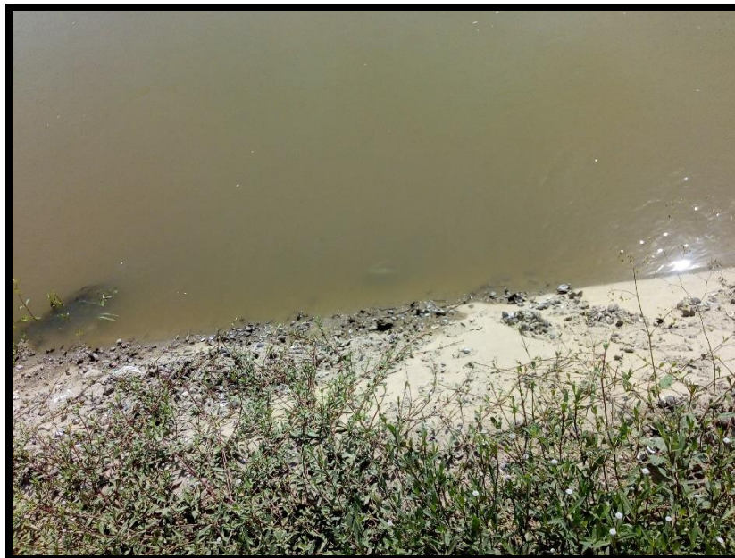
Imagen 24: Presencia de Sedimentos – Losa Izquierda Progresiva: 00+701 – 00+768 Fuente. Elaboración propia, noviembre 2018
