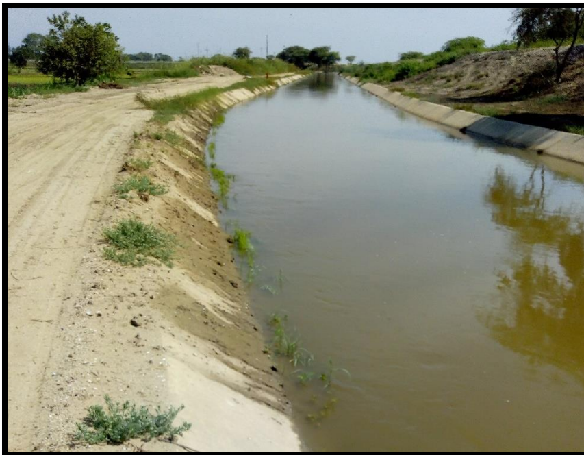
Imagen 28: Presencia de Sedimentos – Losa Izquierda Progresiva: 00+902 – 00+969 Fuente. Elaboración Propia, noviembre 2018
