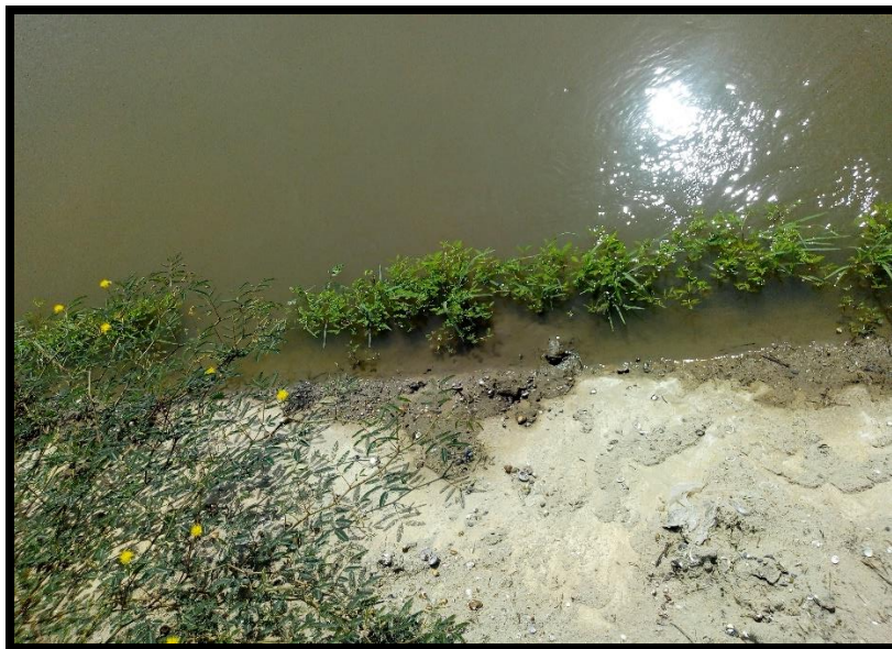
Imagen 20: Presencia de Vegetación y Sedimentos Losa Izquierda Progresiva: 00+500 – 00+567 Fuente: Elaboración Propia, noviembre 2018
