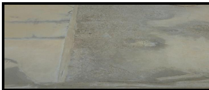
Imagen 13. Descascaramiento Fuente. Elaboración Propia, noviembre - 2018
