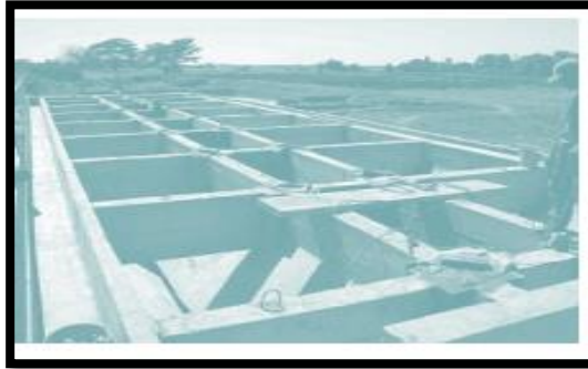
IMAGEN N° 6: Planta de tratamiento.
