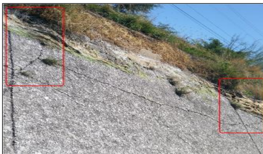
Grafico N° 09: Grieta de esquina. Fuente: Elaboración propia, 2018.
