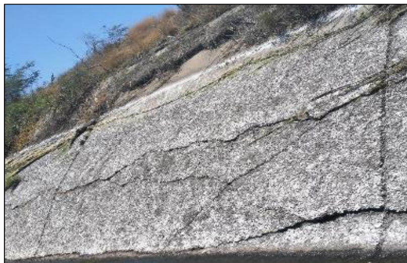
Grafico N° 14: Deterioro de fragmentación de losa.
