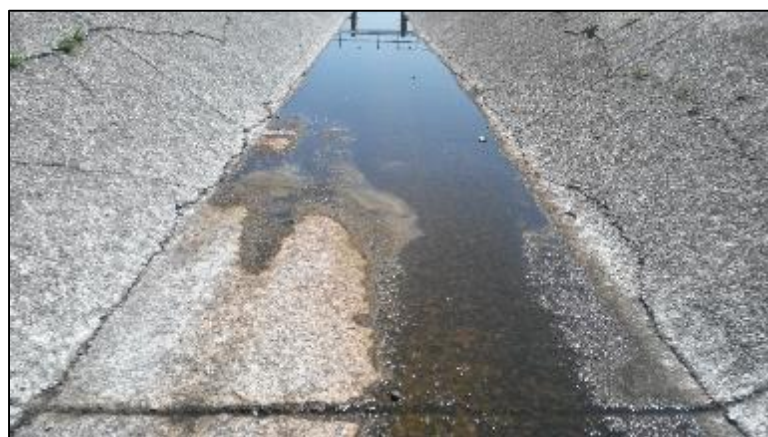
Grafico N° 10: Grietas lineales, transversales y diagonales.
