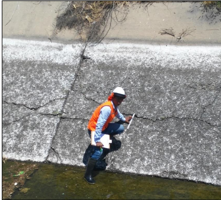
Grafico N° 95: Medición de grietas lineales, transversales y diagonales. Fuente: Propia.
