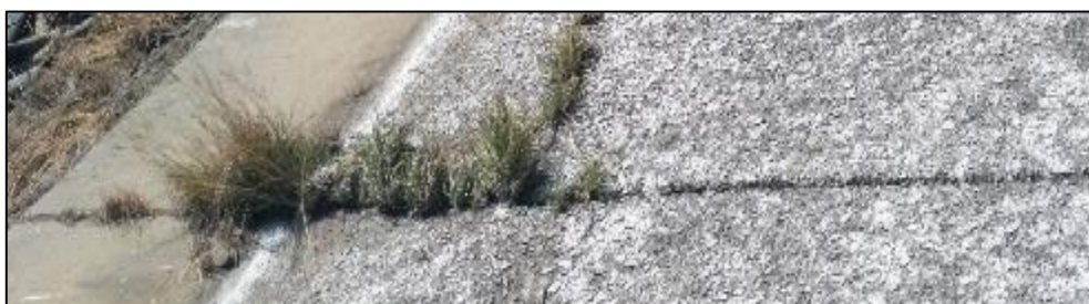
Grafico N° 12: Deterioro de sello de junta.
