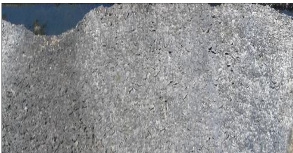
Grafico N° 13: Deterioro de descascaramiento.
