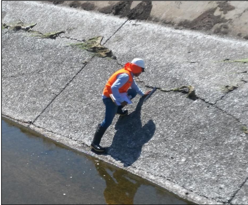
Grafico N° 108: Medición de grietas lineales, transversales y diagonales. Fuente: Propia.
