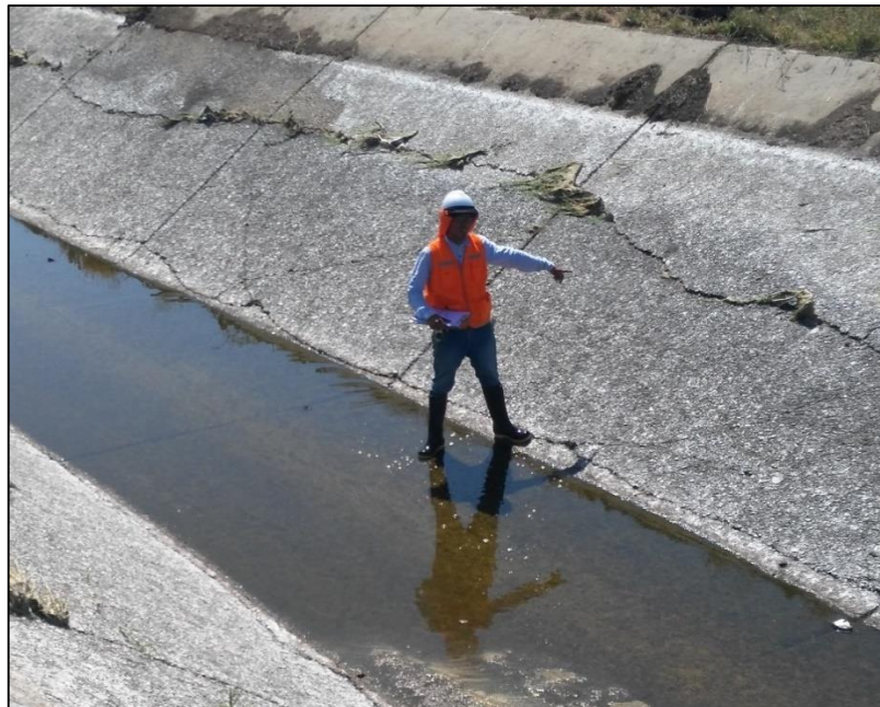
Grafico N° 107: Apreciación de la patología: Grietas lineales, transversales y diagonales, de grado de severidad medio. Fuente: Propia.
