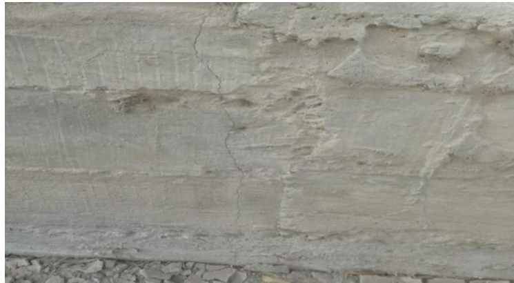
Gráfico 13: Fisura en un sobrecimiento.
