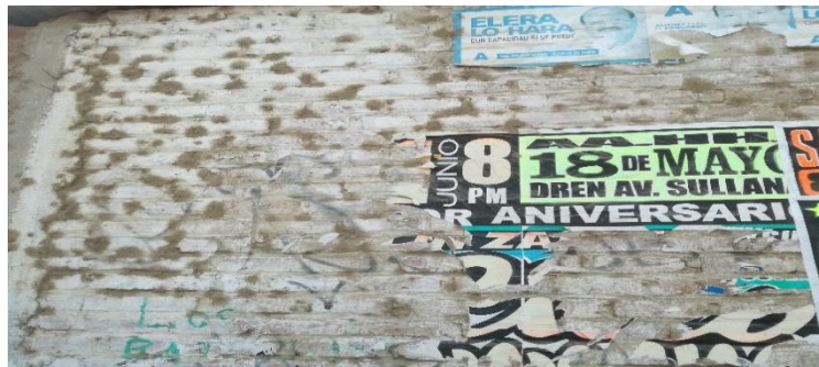
Gráfico 11: Suciedad en muro de albañilería.
