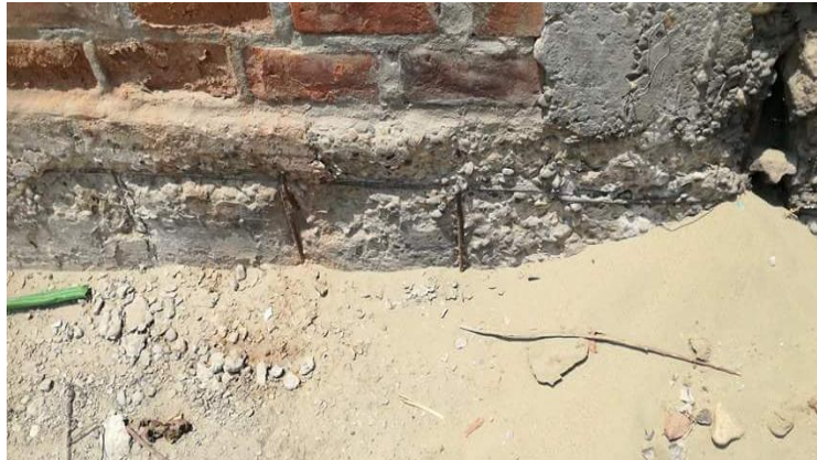
Gráfico 16: Corrosión en el acero del sobrecimiento
