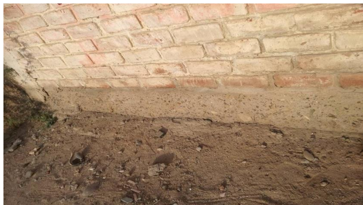
Gráfico 10: Erosión en sobrecimiento.
