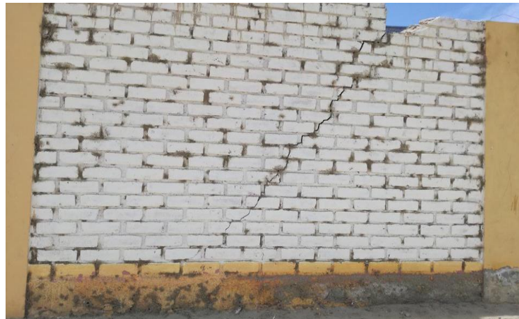
Gráfico 12: Grieta en un muro de albañilería.
