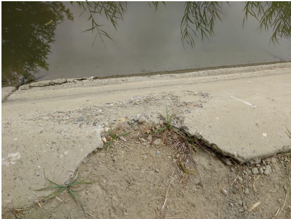
Gráfico 99: Desprendimiento del concreto en la corona del canal
