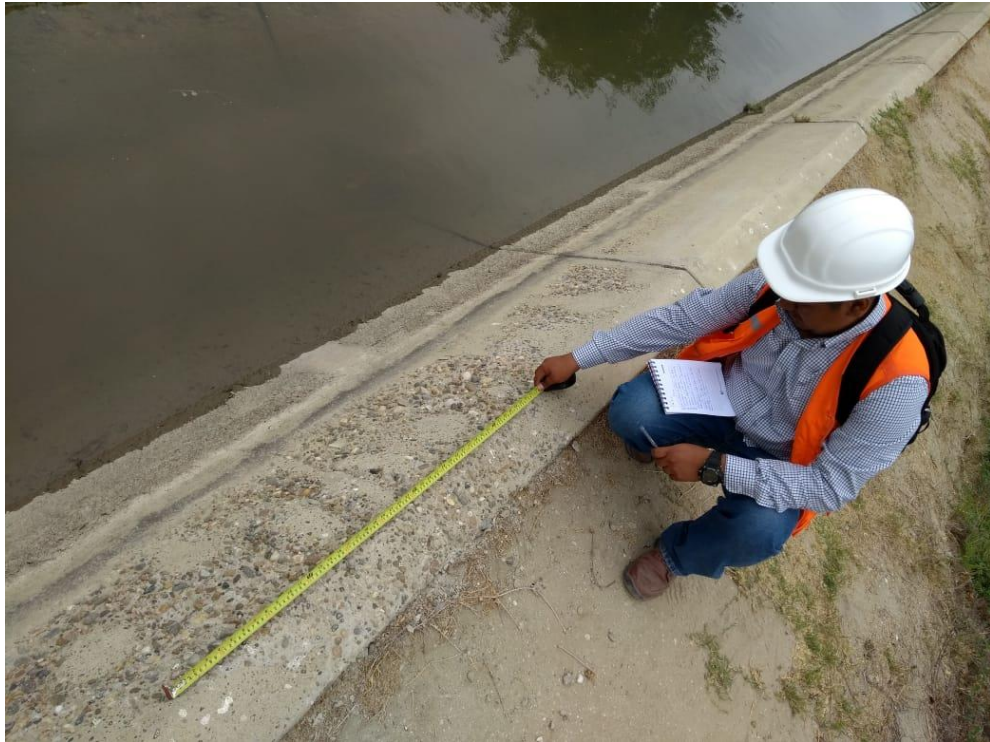
Gráfico 98: Erosión del concreto en el canal.
