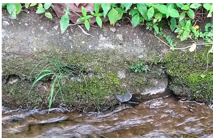
Gráfico 10: Grieta en estructura de concreto.
