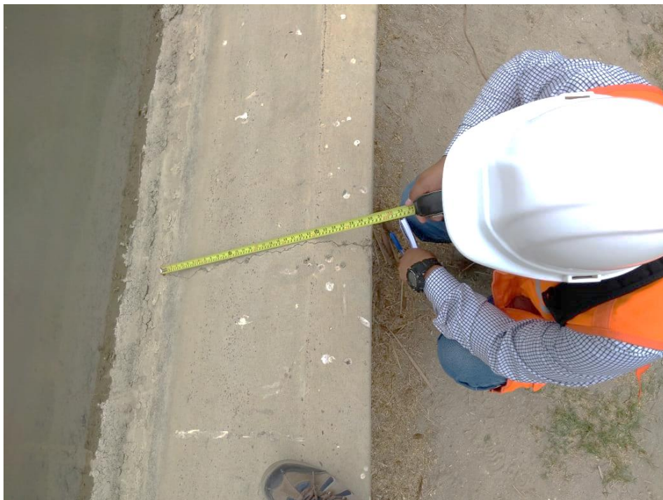
Gráfico 97: Agrietamiento en la losa lateral del canal.
