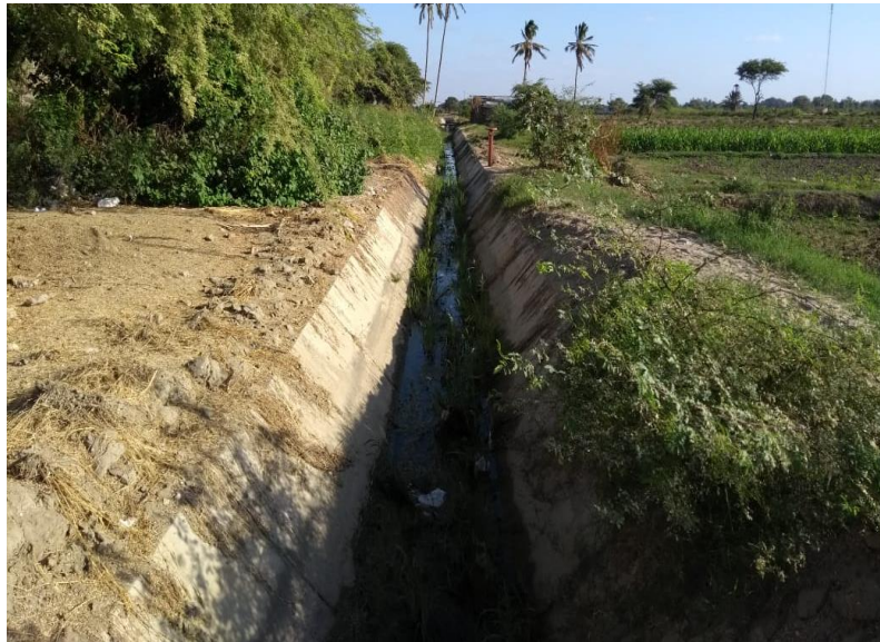
Gráfico 11: Vegetación en canal de concreto.
