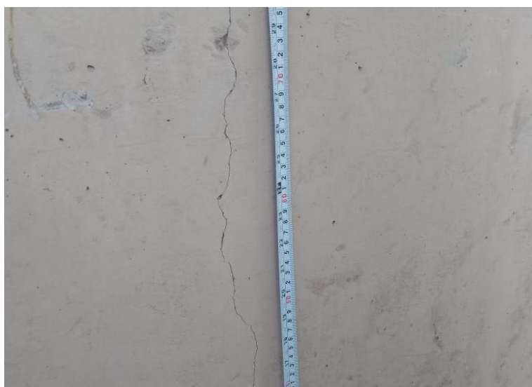
Gráfico 9: Fisura en losa lateral del canal.
