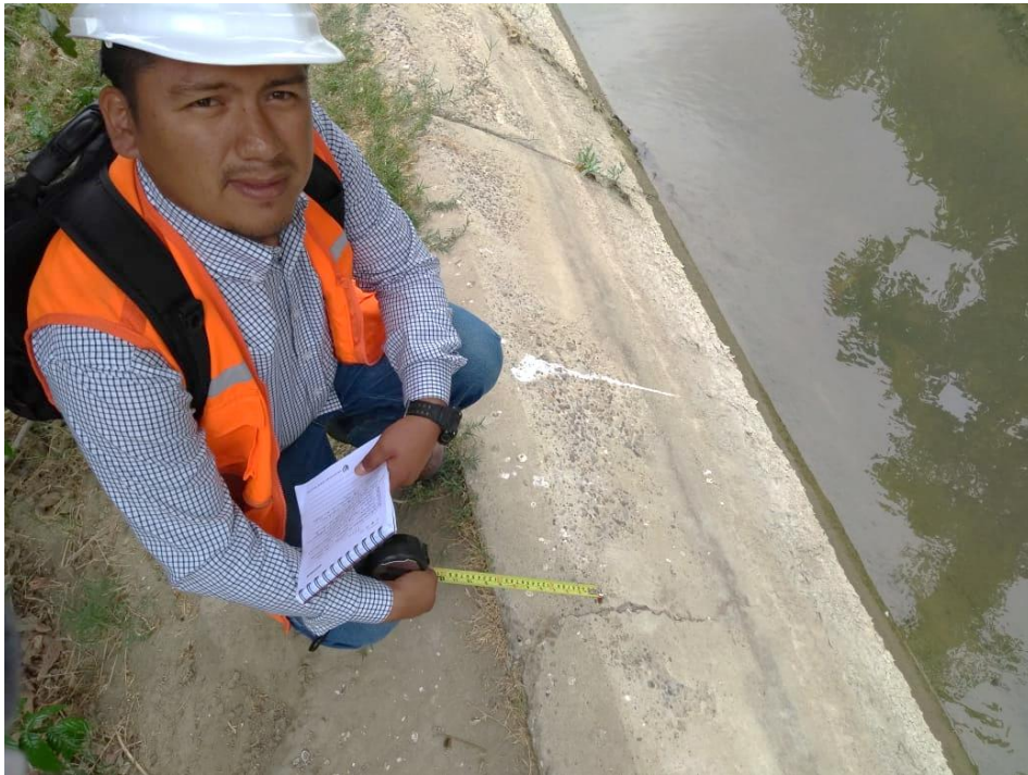
Gráfico 94: Erosión en losa lateral del canal.
