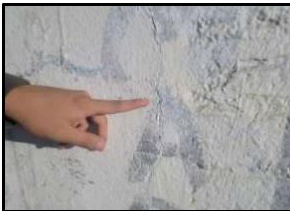
Figura 4. Grieta en muro del cerco Cuna más – Perú. Fuente: Chinchayan (2016).
