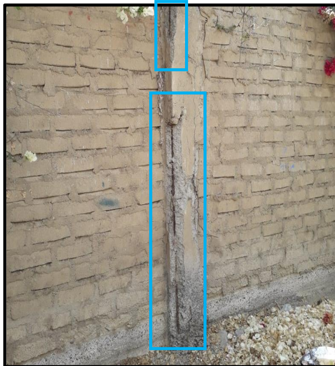
Imagen 9: Corrosión analizada en la unidad de muestra 16, con un 0.88% de afectación.
