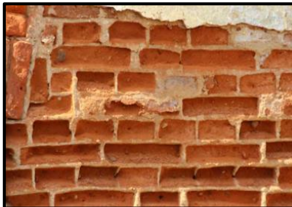
Figura 27. Erosión en paredes de ladrillo - Alemania. Fuente: Braxmeir (2018).
