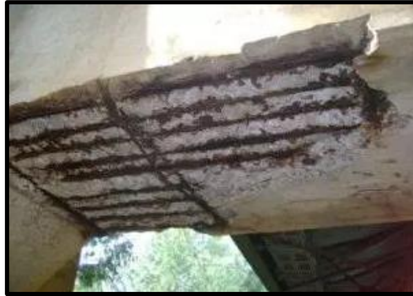
Figura 24. Corrosión en acero de refuerzo – Panamá. Fuente: Castro (2013).
