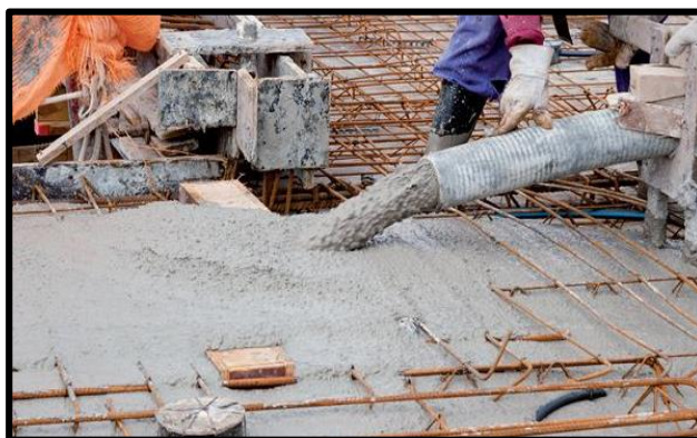
Figura 17. Función de una estructura de hormigón armado – Brasil. Fuente: Romario (2013).
