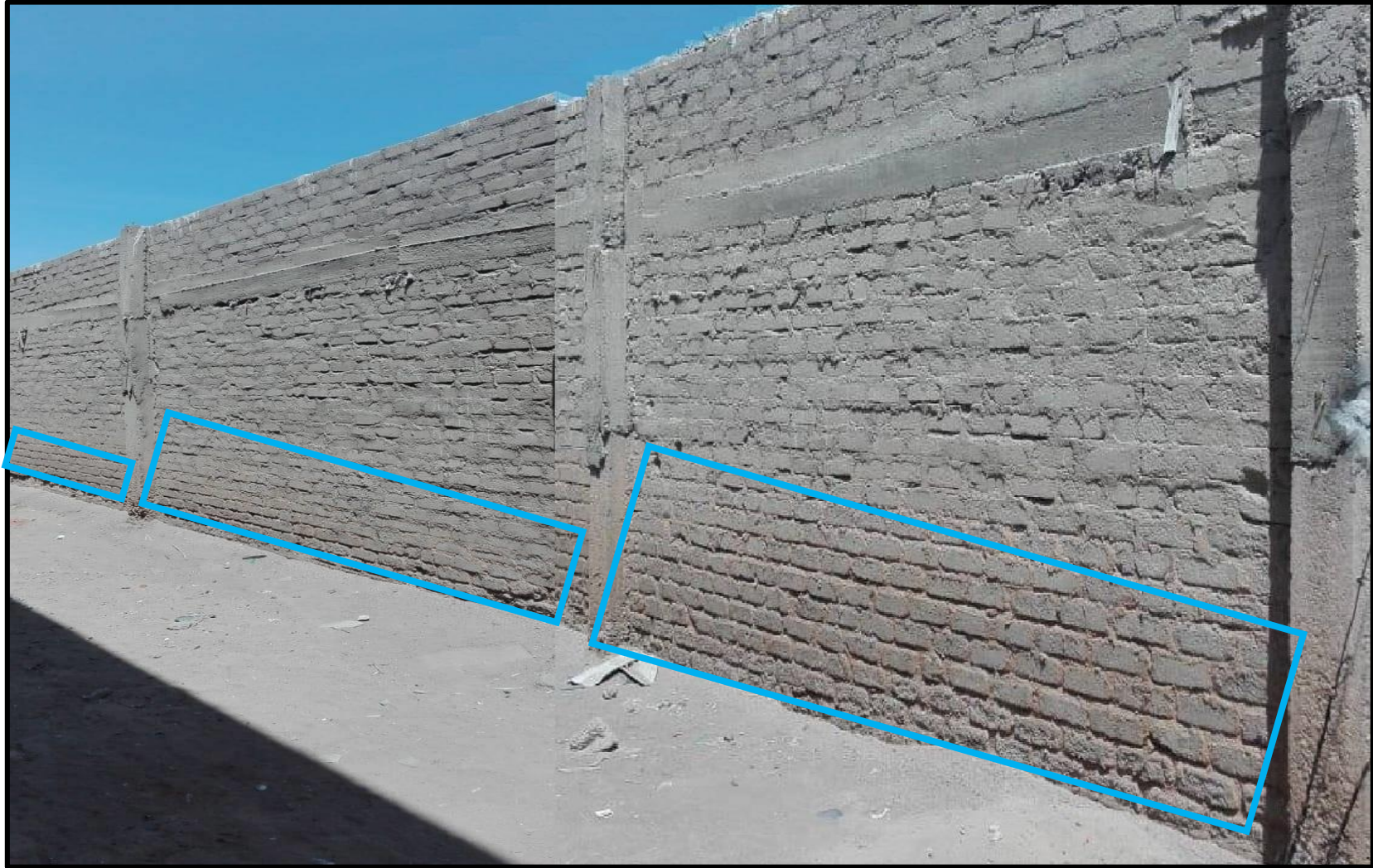
Imagen 2: Tramo 5-6 del cerco perimétrico de Institución Fe y Alegría número 16, donde la erosión es la patología predominante.
