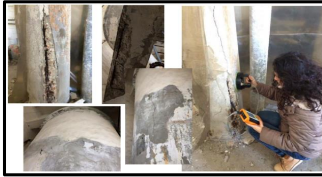
Figura 2. Desprendimiento ubicado en fachadas - México. Fuente: Gómez (2018).
