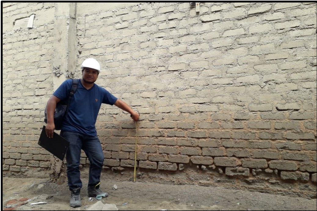
Imagen 5: Evaluación de la patología erosión en el muro de la unidad de muestra 20.
