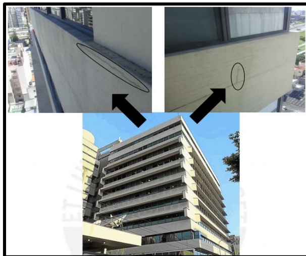
Figura 3. Fisuras en edificio de Cable Visión en C.A.B.A. Fuente: Sika Argentina S.A.I.C. (2018).
