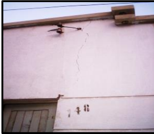
Figura 28. Fisura en muro de Posta Santa Ana - Colombia. Fuente: Arquigráfico (2016).
