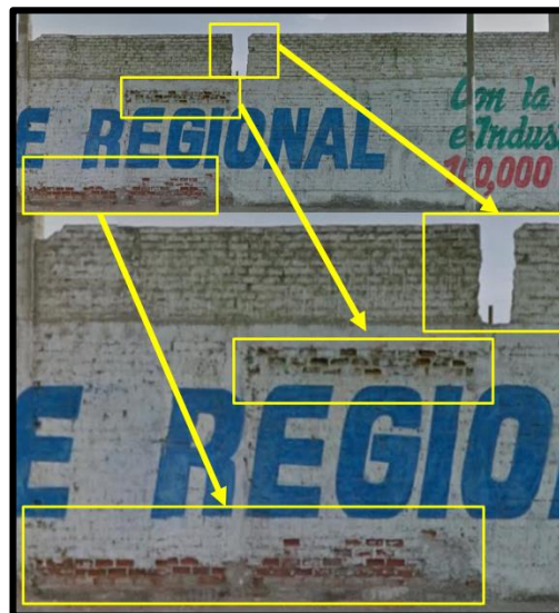
Figura 5. Erosión en muro de Tasa Astillero–Chimbote-Perú.Fuente: Lavado (2016).
