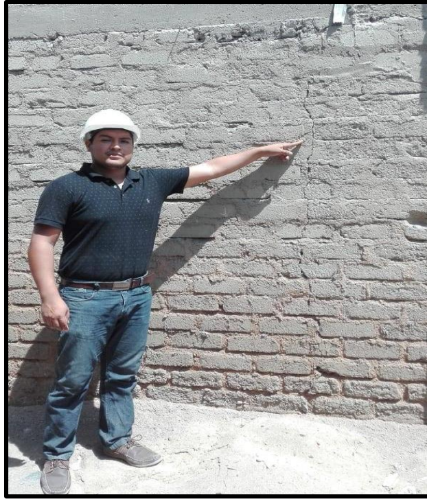
Imagen 8: Grieta en la unidad de muestra 21.
