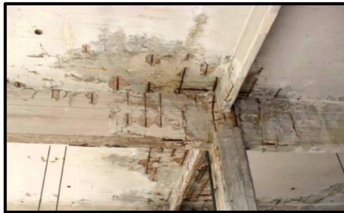
Figura 21. Defectos del concreto – Argentina. Fuente: Quijada (2014).
