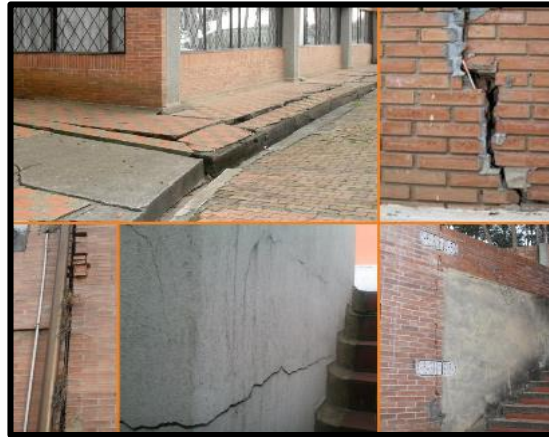
Figura 23. Guía para el estudio de patología de construcción – California – Estados Unidos. Fuente: Díaz (2014).
