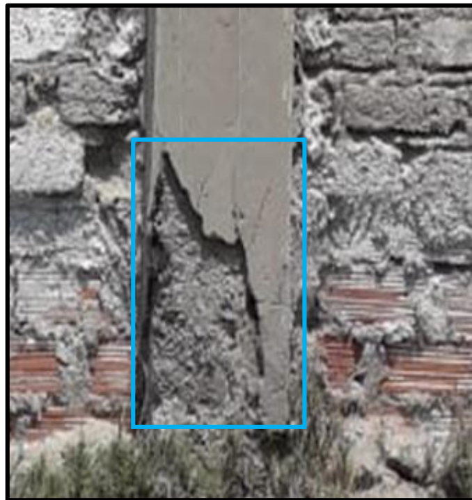
Imagen 11: Desprendimiento hallado en la unidad de muestra 29.
