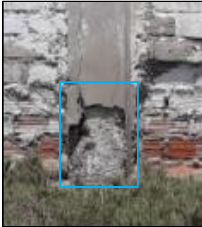
Imagen 12: Desprendimiento hallado en la unidad de muestra 29.
