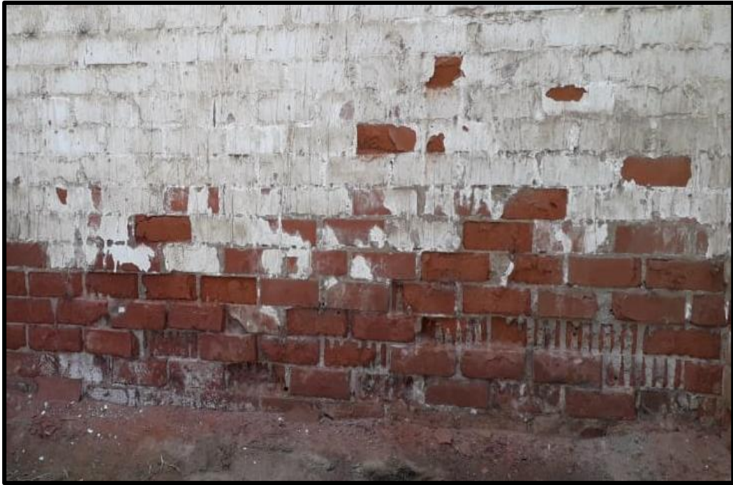
Imagen 4: Erosión encontrada en el muro de la unidad de muestra 8.
