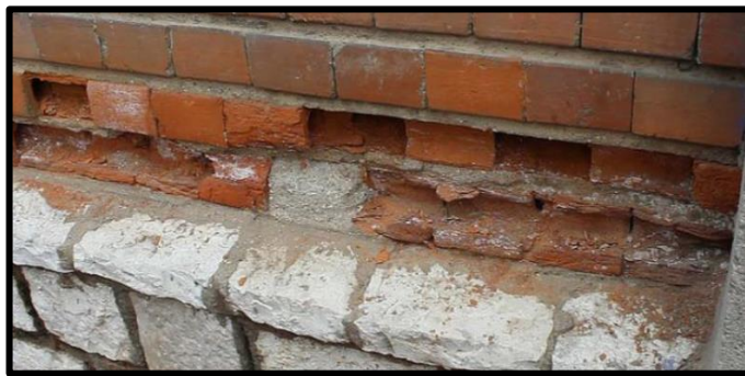
Figura 25. Daños por erosión en fachada – Panamá. Fuente: Peña (2017).
