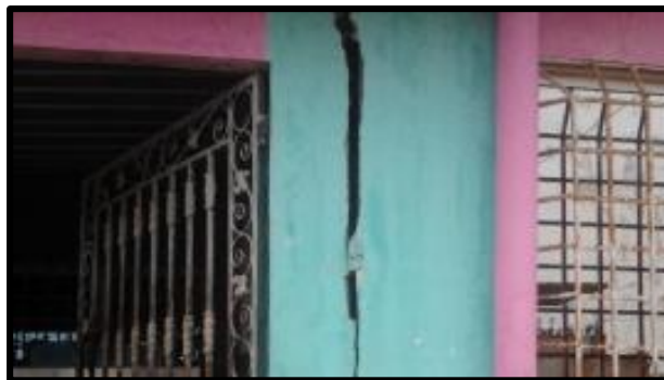
Figura 1. Fisura ubicada en una pared de las viviendas en Machala – Ecuador. Fuente: Gia (2016).
