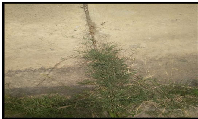
Figura 9: Vegetación en canal de concreto
