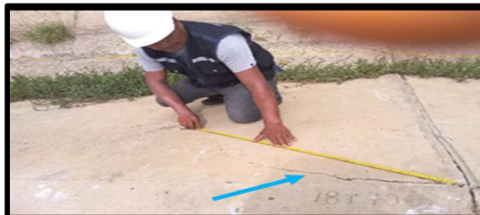
Figura 7: Grietas horizontales en canal de concreto
