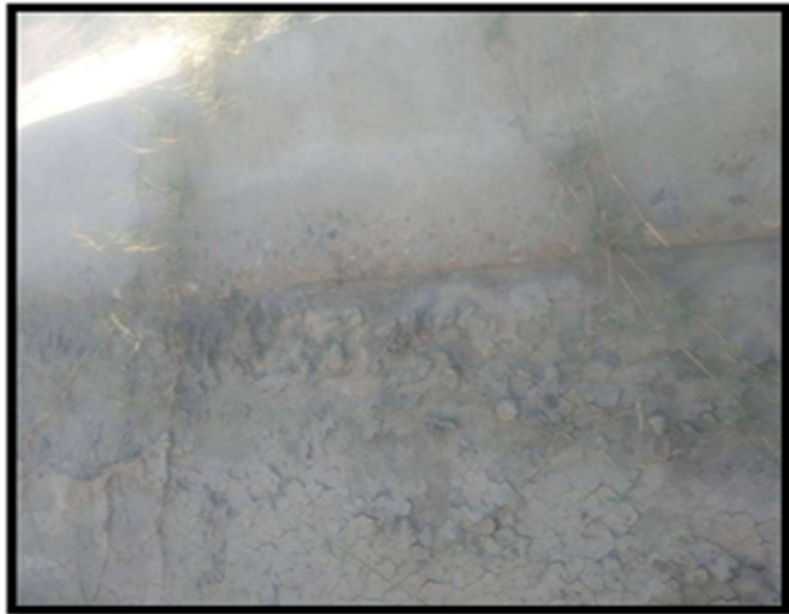
Figura 12: Desintegración de partículas en canal de concreto.
