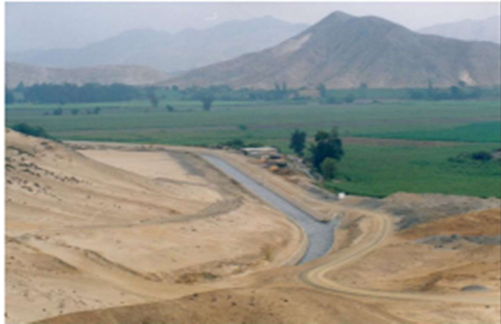
Figura 2: Canal de derivación
