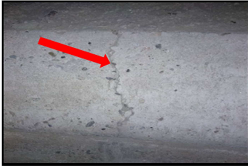
Figura 18: LOSA CON GRIETA
