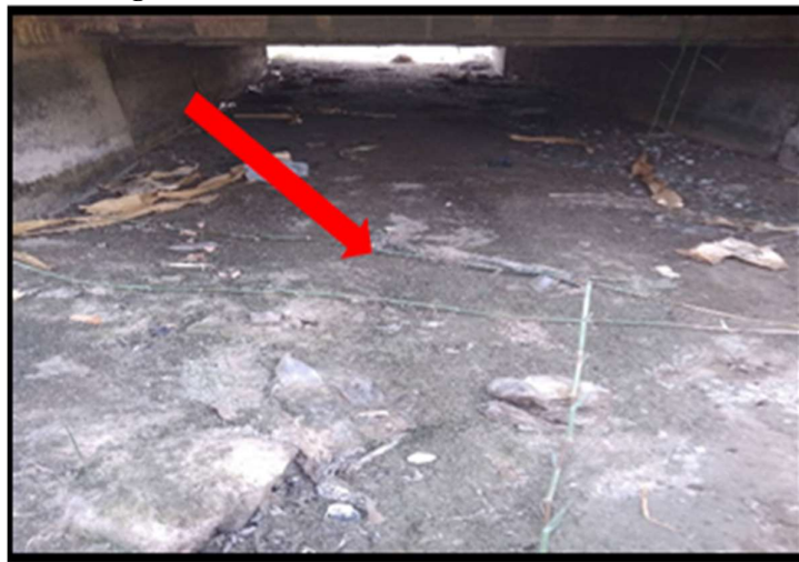
Figura 23: SEDIMENTACION EN EL CANAL
