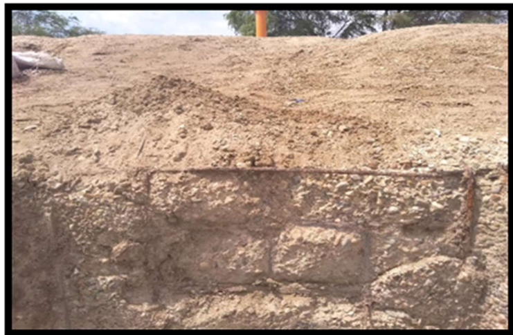
Figura 11: Erosión en canal de concreto
