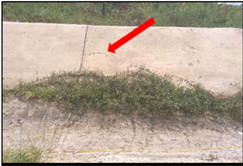
Figura15: LOSA CON FISURA
