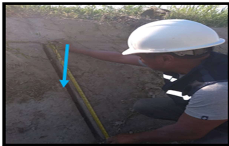
Figura 10: Deterioro de sello de junta en canal de concreto
