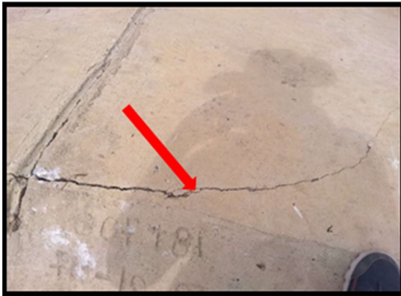
Figura 17: LOSA CON FISURA
