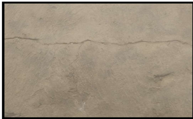
Figura 8: Fisuras en canal de concreto
