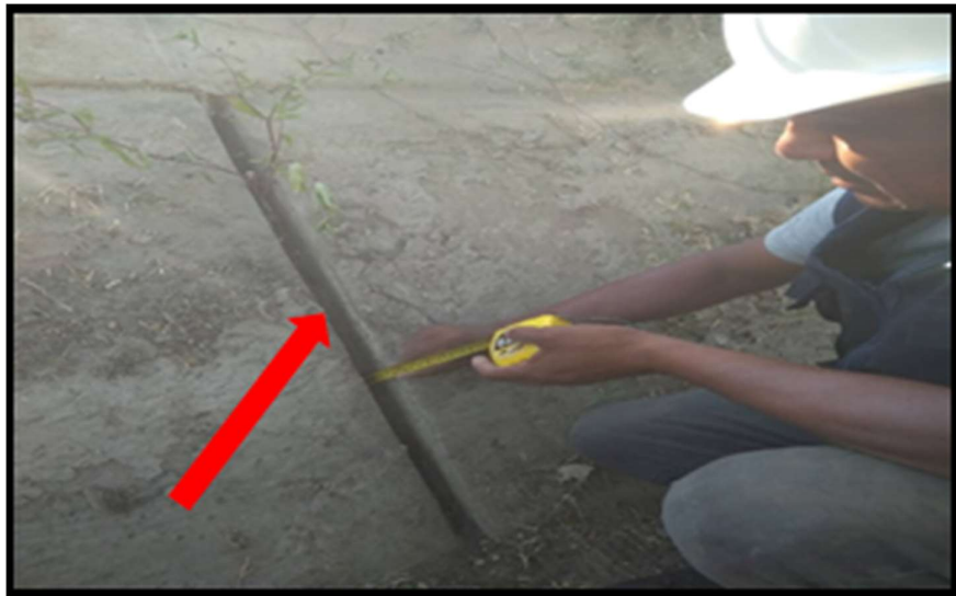
Figura 19: PÉRDIDA DE SELLO DE JUNTA
