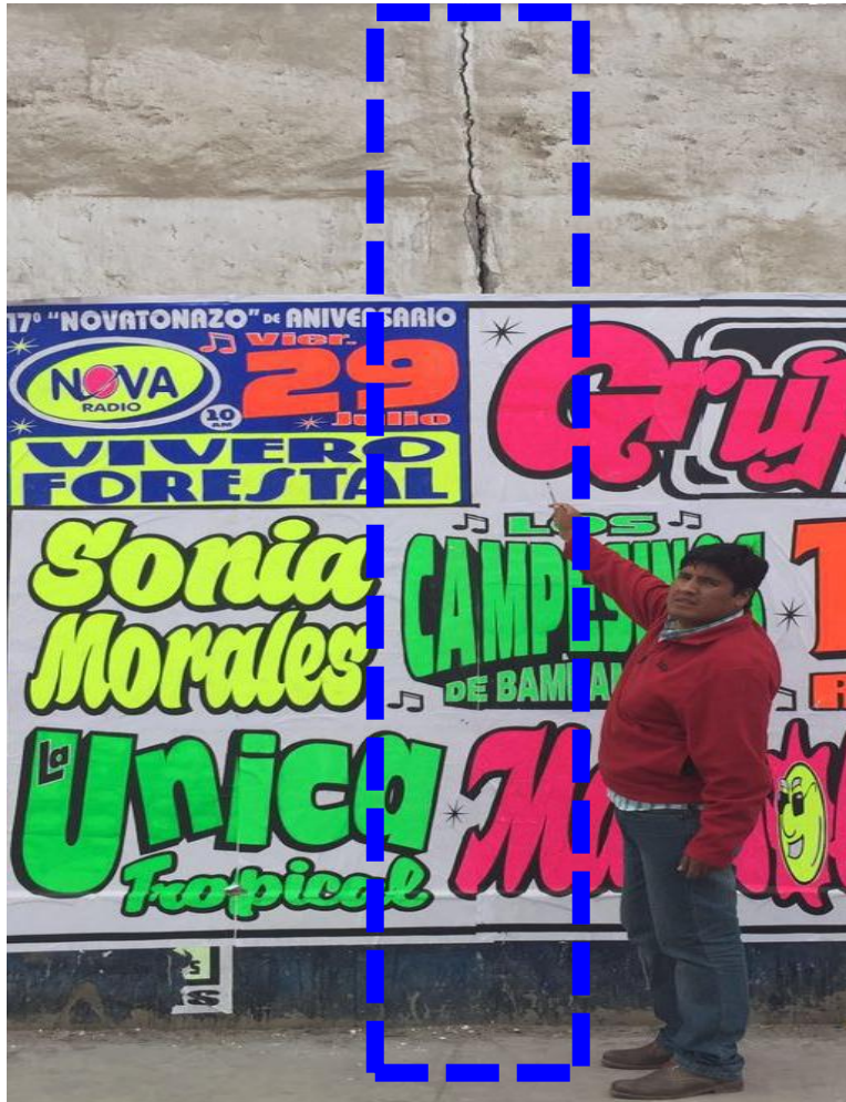
Figura 25: Imagen de la muestra 04 se aprecia el muro afectado de línea punteada azul
