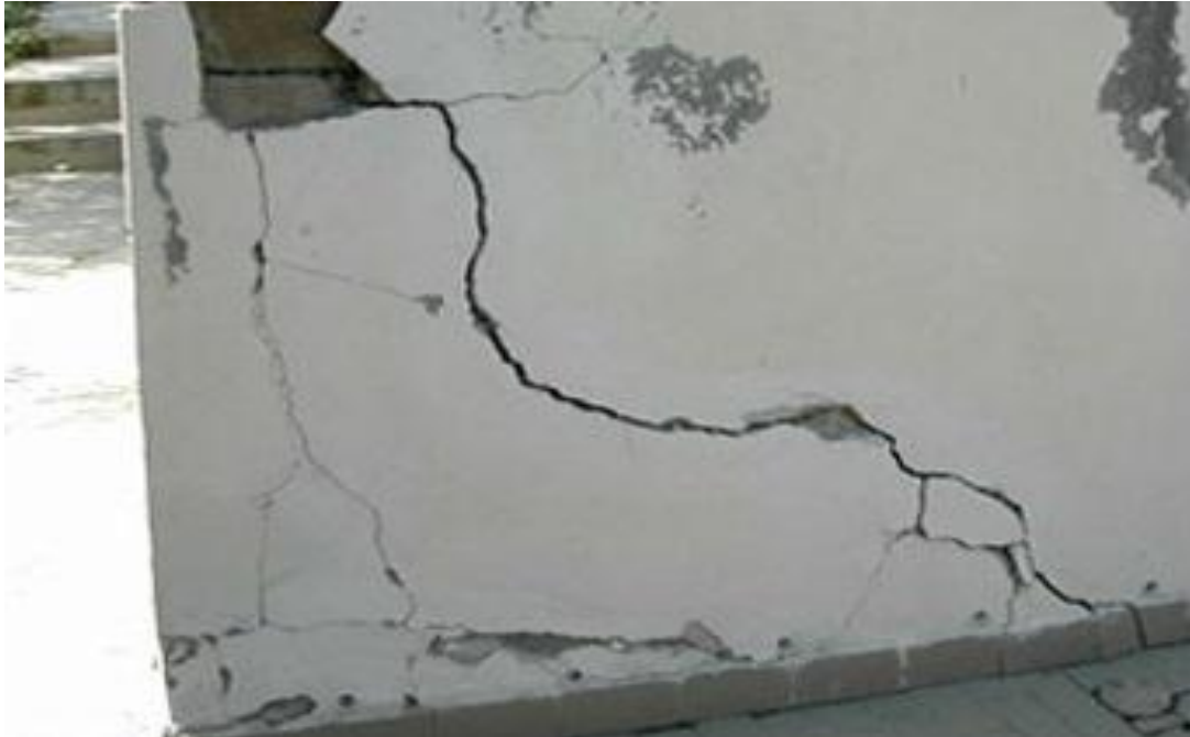
Figura 10: Agrietamiento en el concreto
