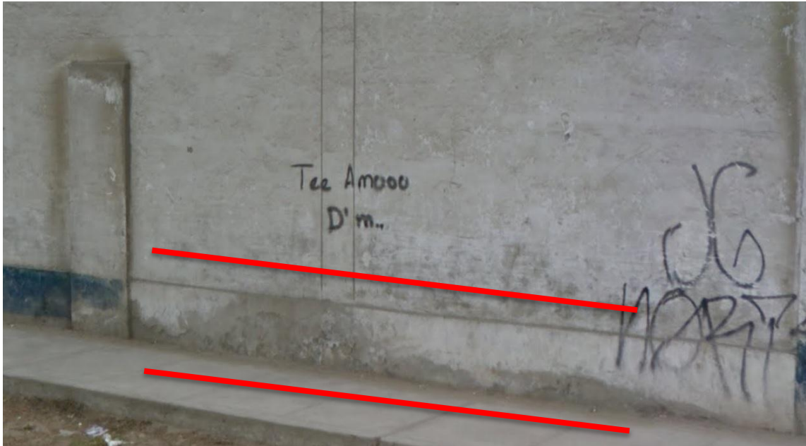
Figura 26: Imagen de la muestra 05 afectado por la patología de delaminación.
