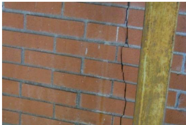
Figura 6. Grieta en muro de albañilería Nota. Fuente: Gegdyszman (2013).
