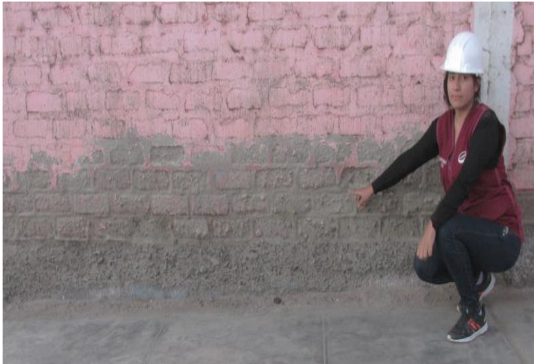
Fotografía 6: Muro afectado por la Erosión en la Unidad de Muestra 16.
