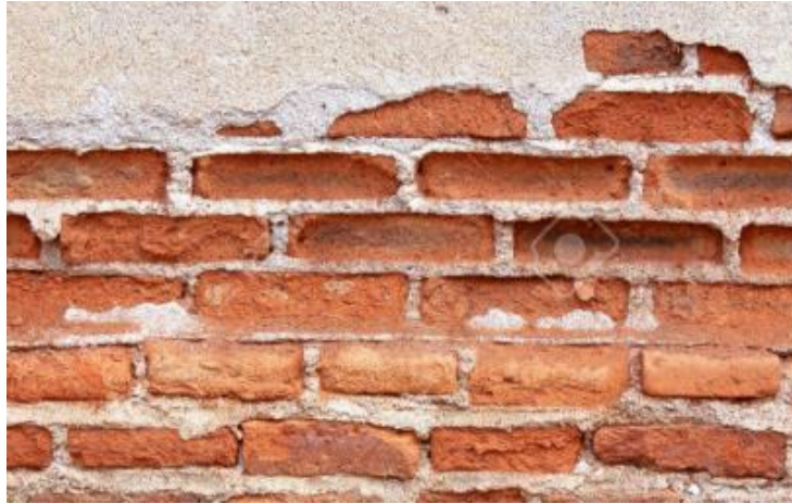
Figura 8. Erosión química en muro de albañilería Nota. Fuente: Enciclopedia Broto (2012).
