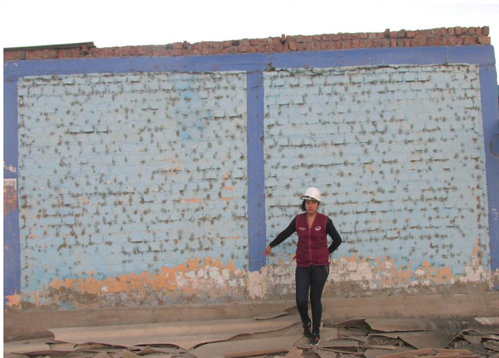
Fotografía 8: Muro afectado por la Eflorescencia en la Unidad de Muestra 08.
