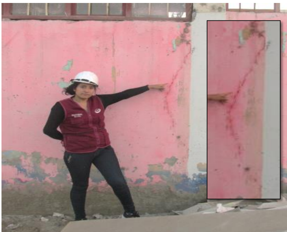
Fotografía 10: Fisura en la Unidad de Muestra 06.
