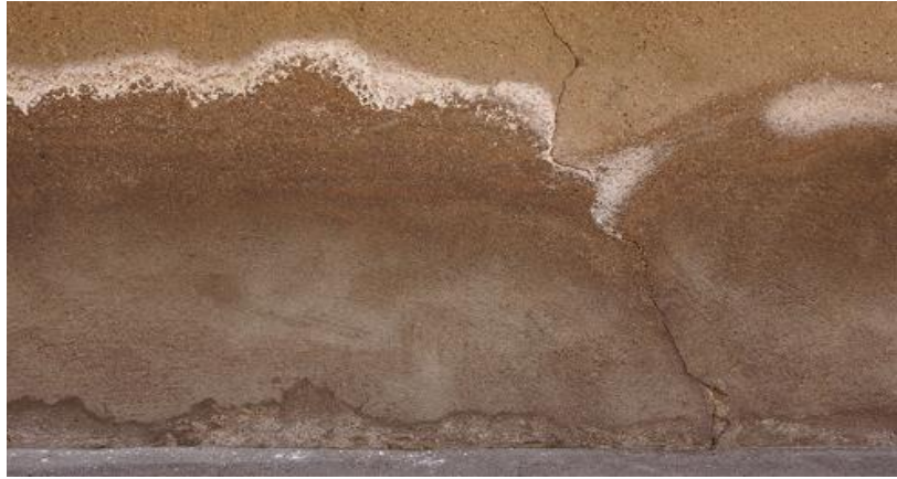
Figura 9. Eflorescencia en Muro.
