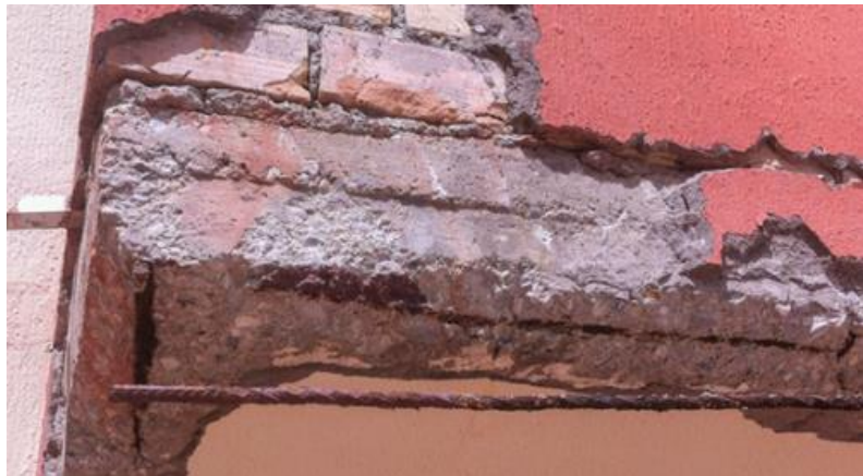
Figura 10. Corrosión en viga de concreto armado. Nota. Fuente: Bartolomé (2008).
