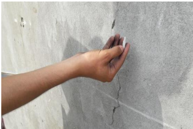
Figura 8. Fisura vertical en muro.
