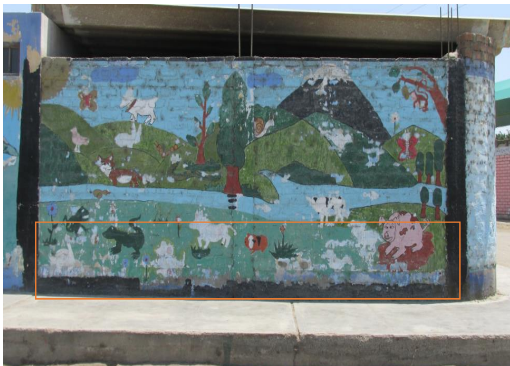
Fotografía 9: Muro afectado por la Eflorescencia en la Unidad de Muestra 14.
