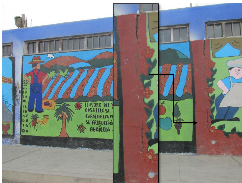
Fotografía 11: Muro afectado grieta en la Unidad de Muestra 12.
