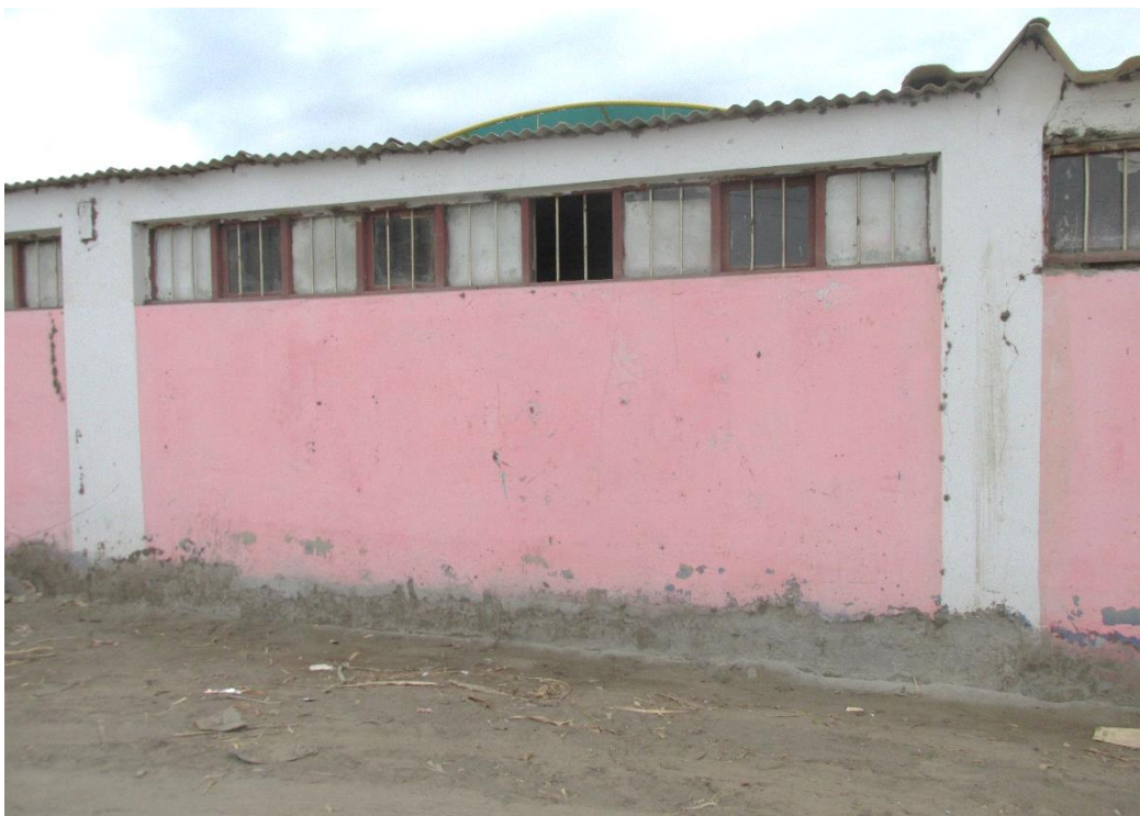
Fotografía 7: Muro afectado por la Erosión en la Unidad de Muestra 05.
