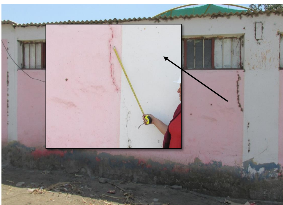
Fotografía 11: Fisura en la Unidad de Muestra 04.
