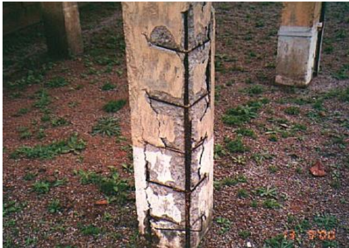
Figura 5. Corrosión en columna
