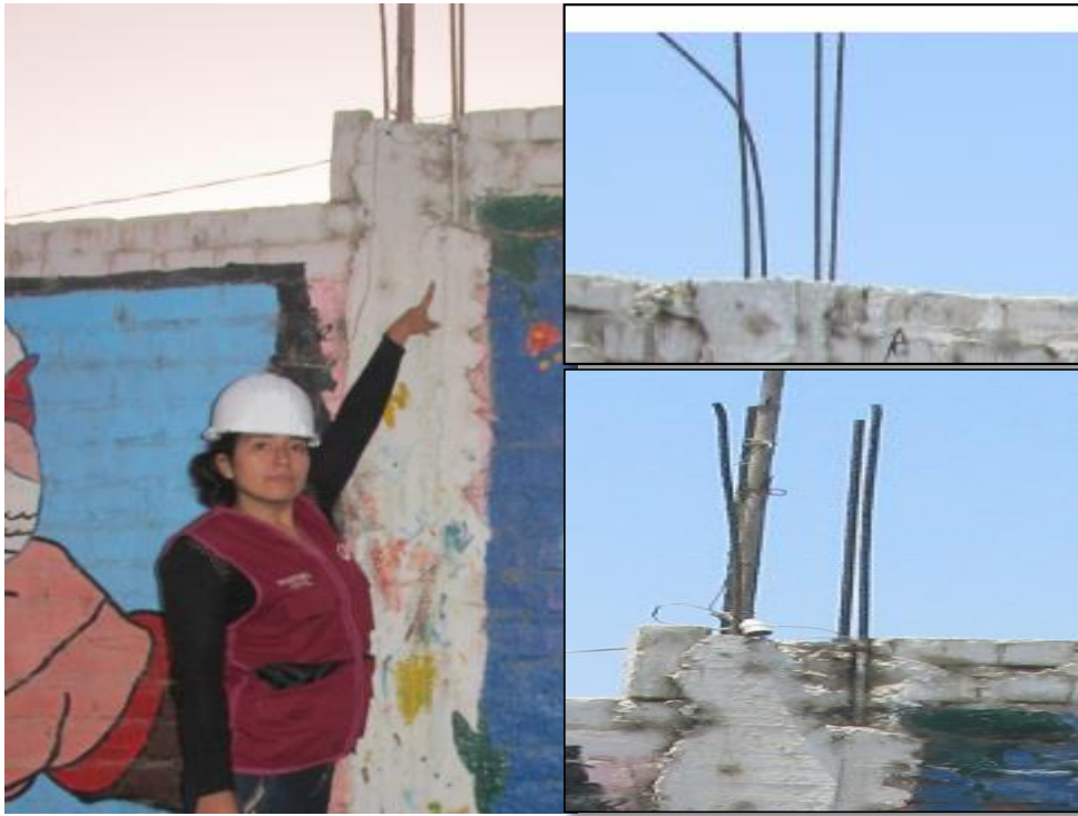
Fotografía 12: Columna afectada por la Corrosión en la Unidad de Muestra 18.
