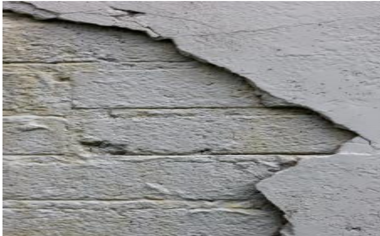
Figura 7. Desprendimiento en revoque
