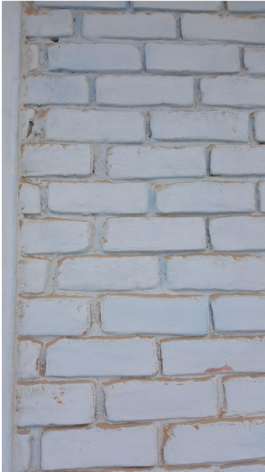
Imagen 22: Suciedad en muros unidad de muestra 07.
