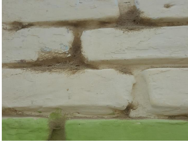
Imagen 3: Suciedad en muros.
