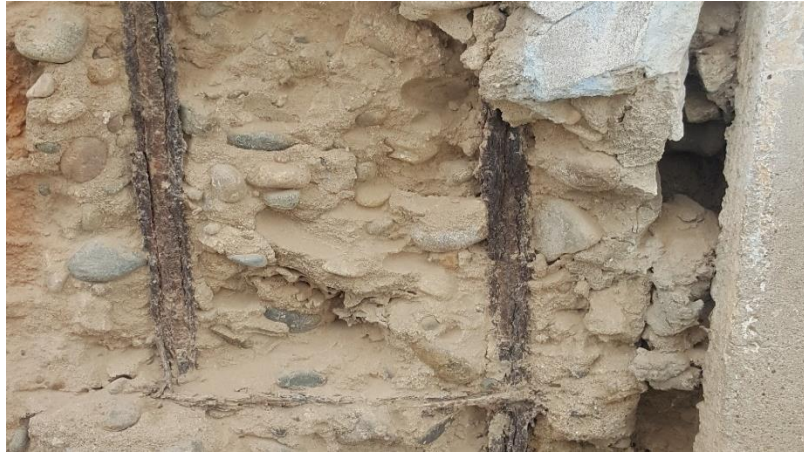
Imagen 4: Corrosión en muros.
