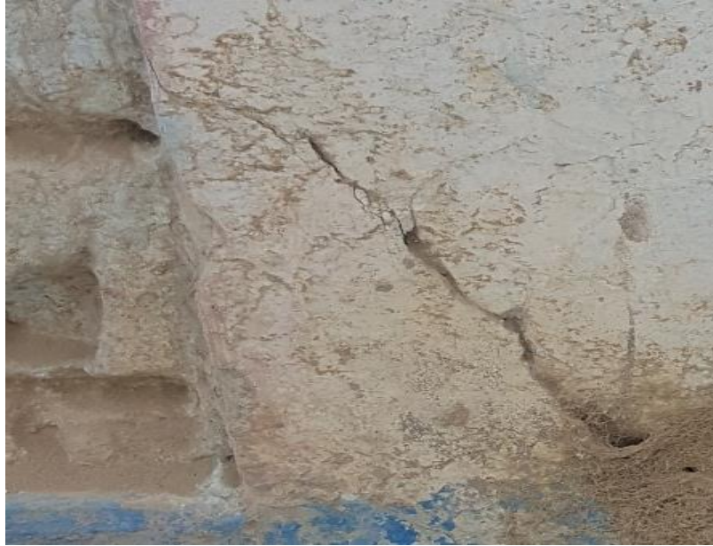
Imagen 7: Grietas en muros.
