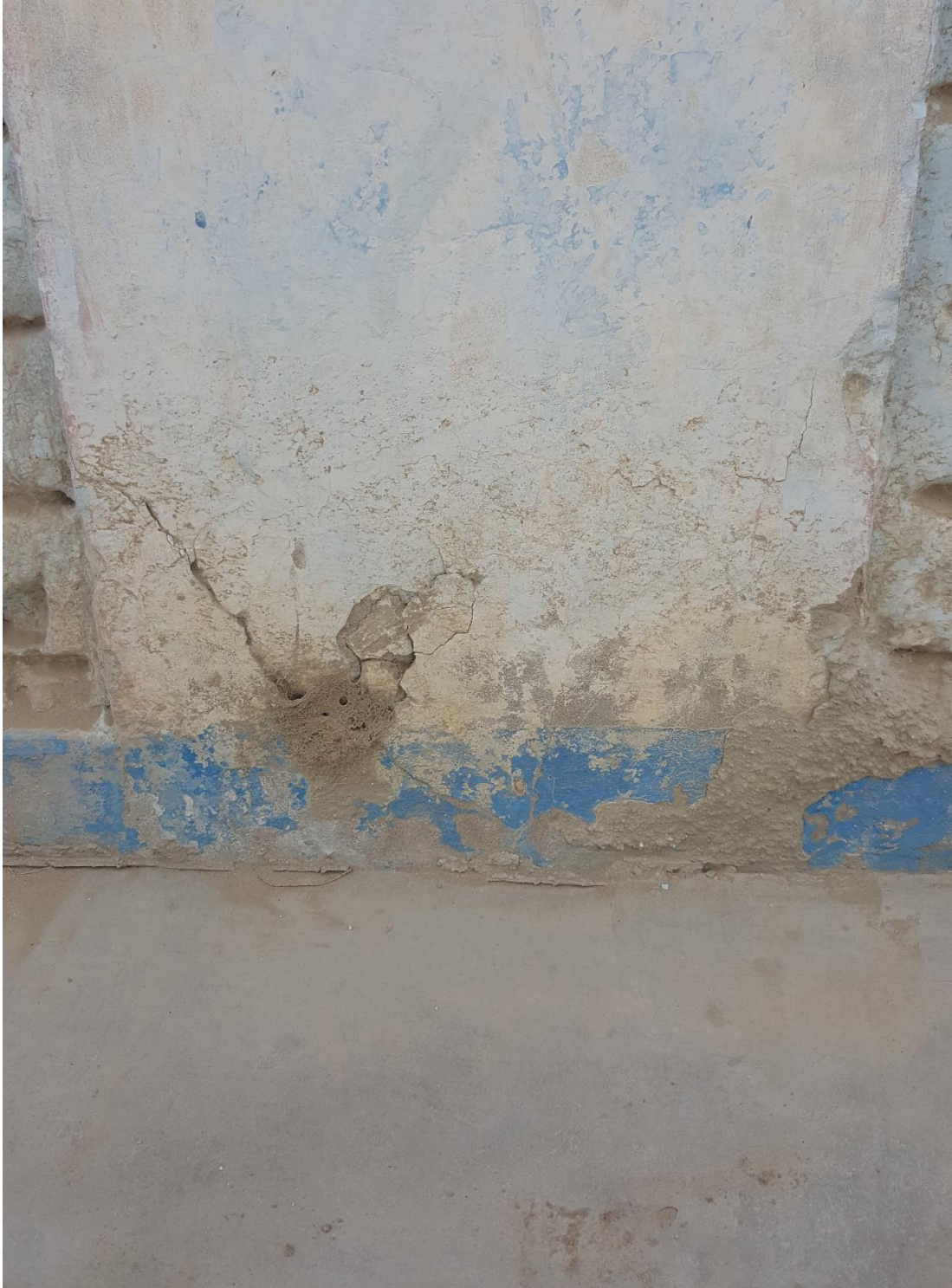
Imagen 23: Suciedad y fisuras en columna unidad de muestra 08.
