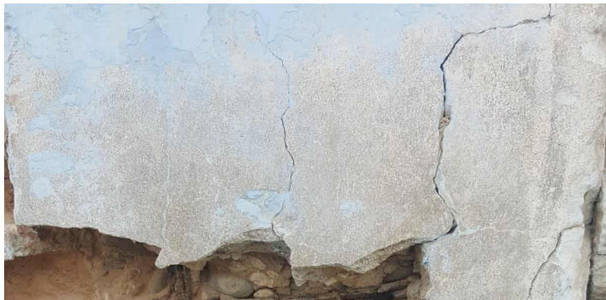
Imagen 5: Desprendimientos en muros.
