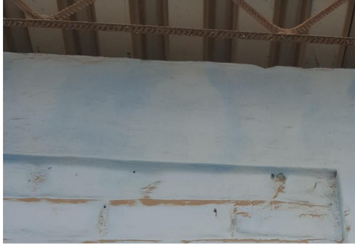
Imagen 8: oxidación en acero corrugado. Fuente: Elaboración Propia.
