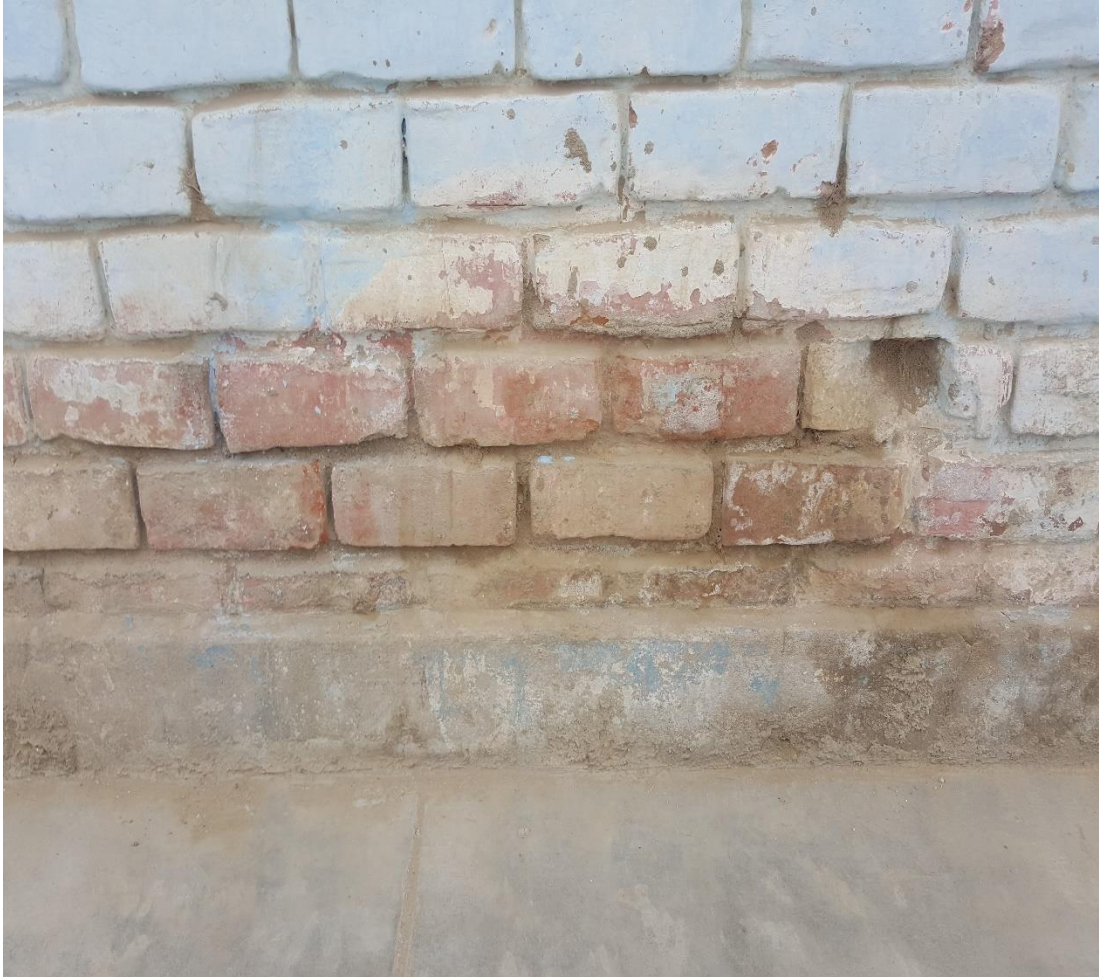
Imagen 18: Humedad en muros unidad de muestra 04.
