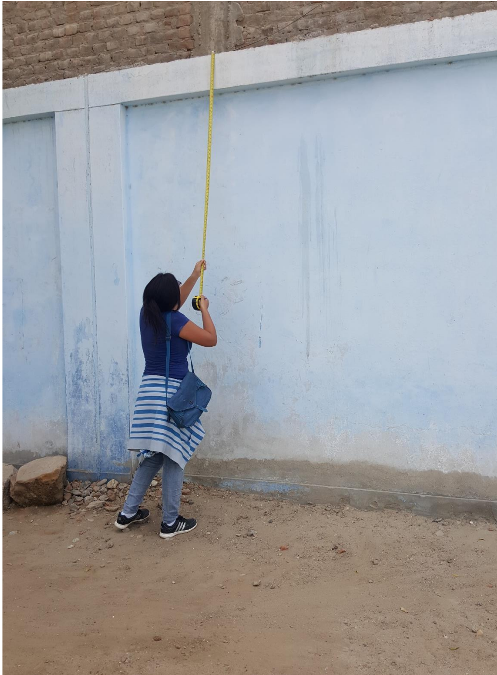
Imagen 10: Eflorescencia en muros y columna unidad de muestra 13.
