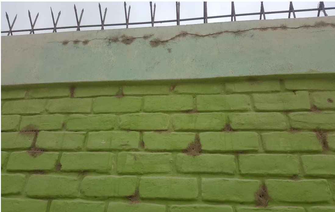
Imagen 14: Fisura en viga unidad de muestra 02.
