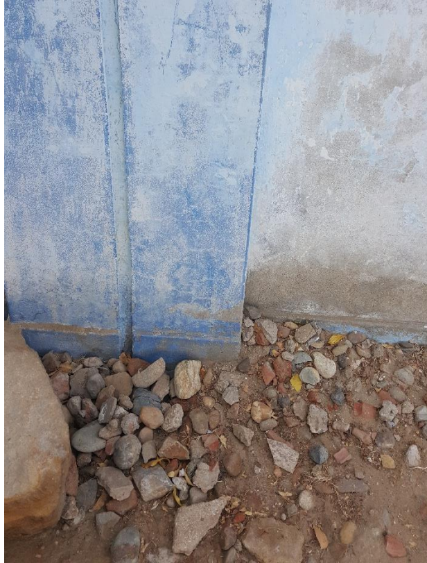
Imagen 1: Humedad en muros.
