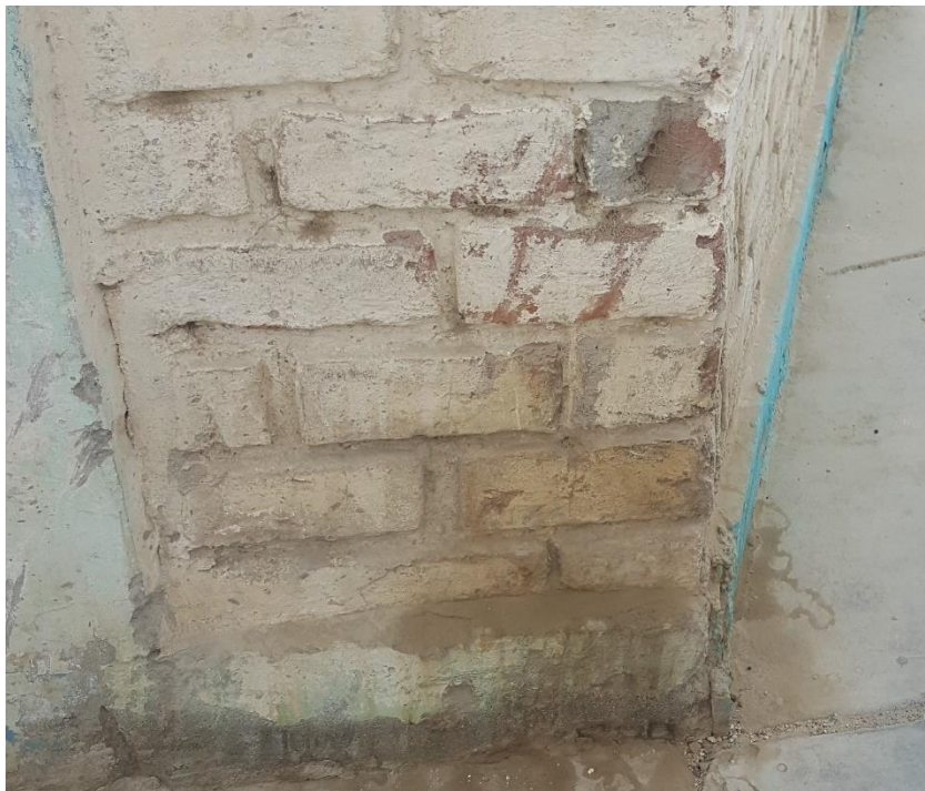
Imagen 17: Humedad en muros unidad de muestra 03.
