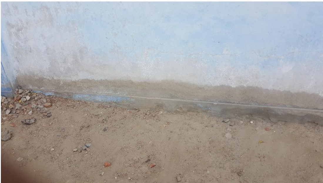
Imagen 25: Humedad en muros unidad de muestra 14.
