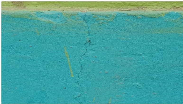
Imagen 6: Fisuras en muros.
