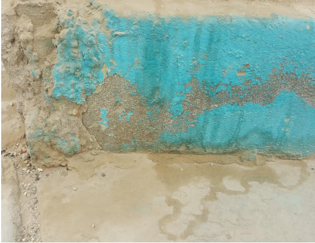
Imagen 16: Eflorescencias en muros unidad de muestra 03.
