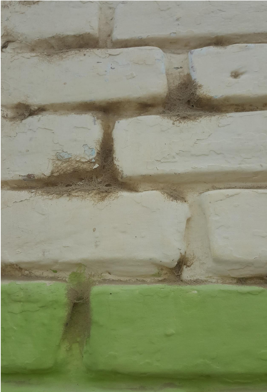
Imagen 11: Suciedad en la unidad de muestra 01.
