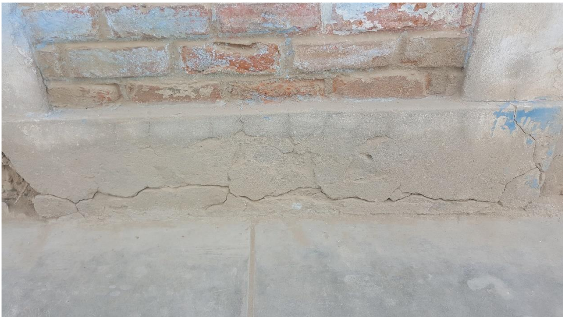
Imagen 21: Fisuras en muros unidad de muestra 06.
