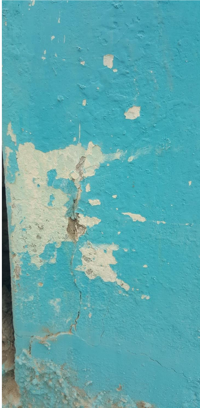
Imagen 15: Fisuras en columna unidad de muestra 02.
