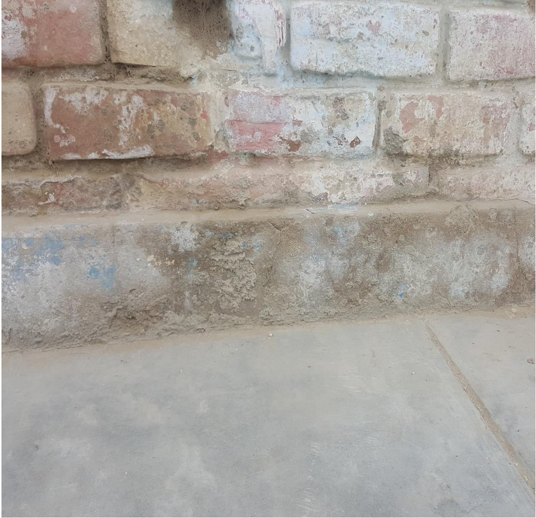
Imagen 19: Eflorescencia en muros unidad de muestra 04.
