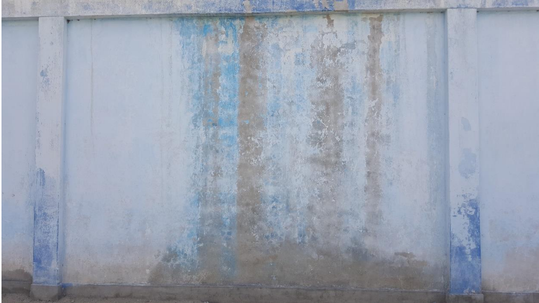
Imagen 24: Humedad en muros unidad de muestra 14.
