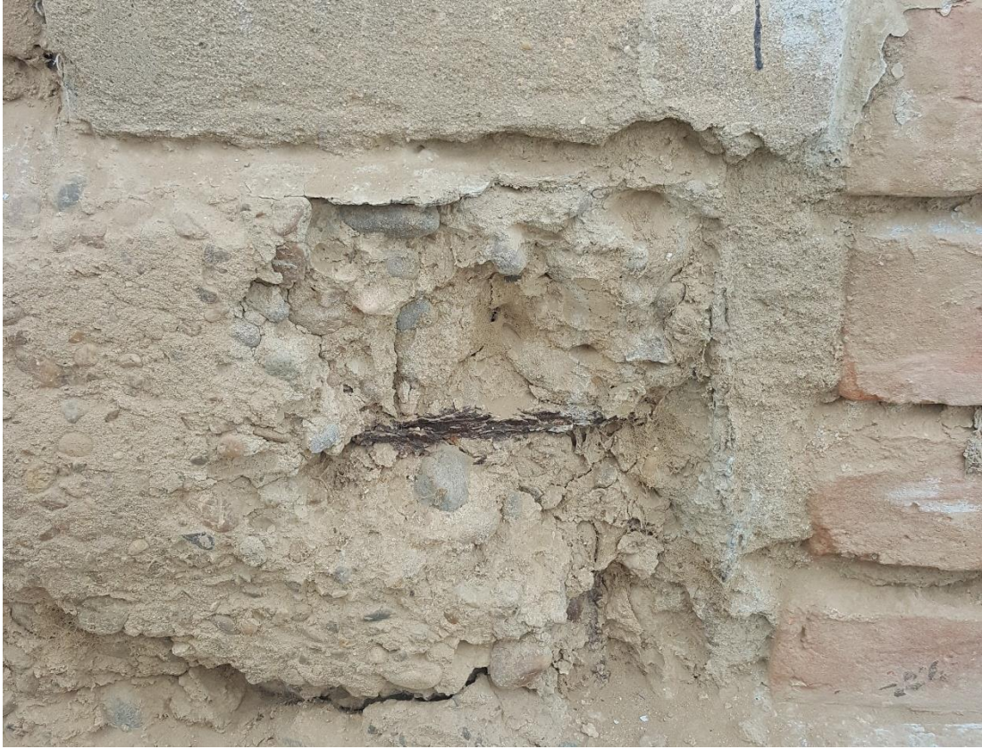
Imagen 20: Corrosión en columna unidad de muestra 05.
