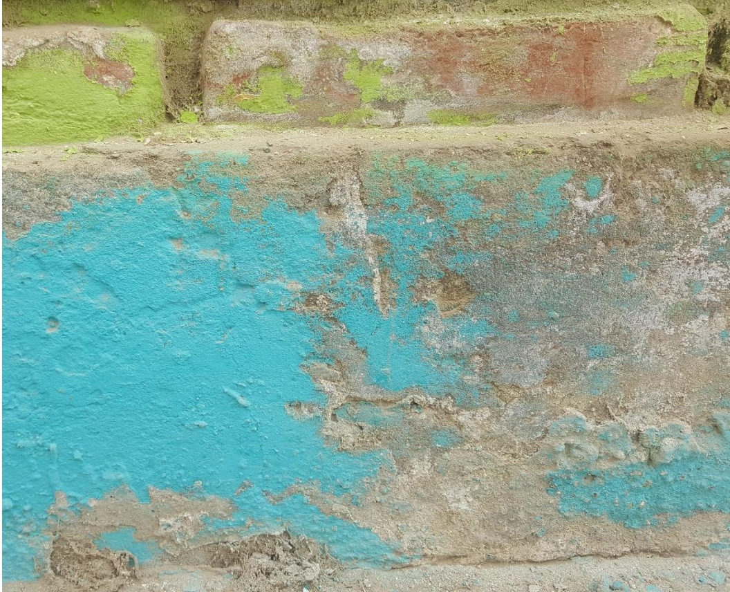
Imagen 13: Eflorescencia en muros de la unidad de muestra 02.
