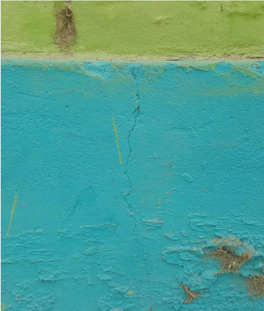
Imagen 12: Fisura en la unidad de muestra 01.
