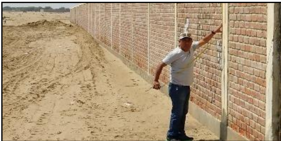
Grafico N° 89. Patología de Manchas. Fuente Propia.
