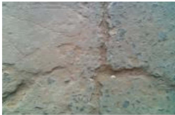
Grafico N° 21. Fisura. Fuente Google
