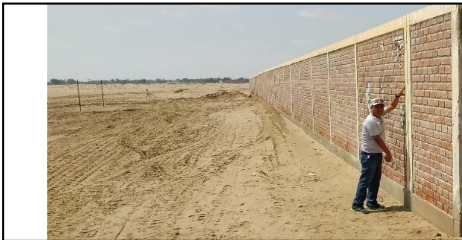
Grafico N° 96: Patología de Eflorescencia en las columnas. Fuente Propia.
