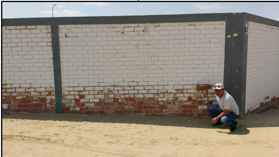
Grafico N° 87. Patología del Delaminación. Fuente Propia.
