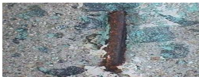
Grafico N° 09. Corrosión. Fuente Google
