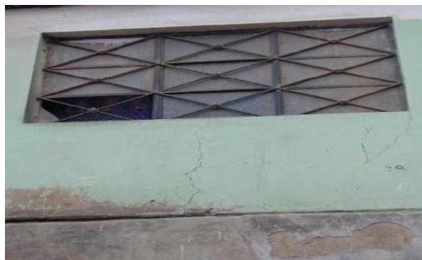
Grafico N° 22. Grieta. Fuente Propia
