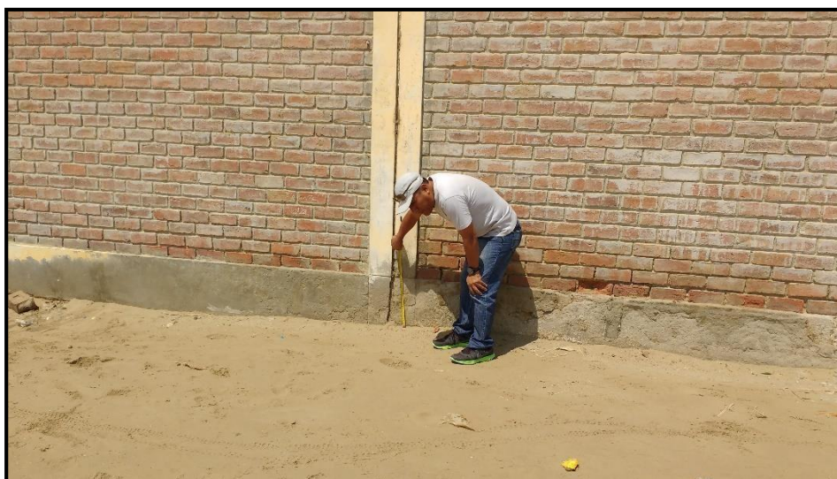
Grafico N° 90. Patología de Eflorescencia en las columnas. Fuente Propia.
