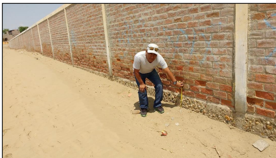
Grafico N° 91. Patología de Exudación en la parte inferior de los paños. Fuente Propia.
