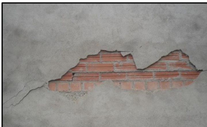
Grafico 8 - Imagen de desprendimiento en muro de albañilería
