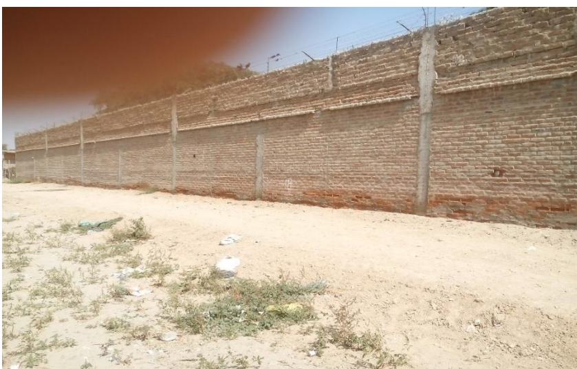
Anexo 4. Patología de la humedad y erosión
