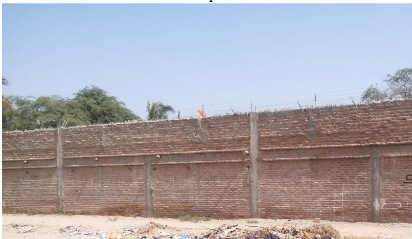
Anexo 3: Erosión en la parte inferior del muro
