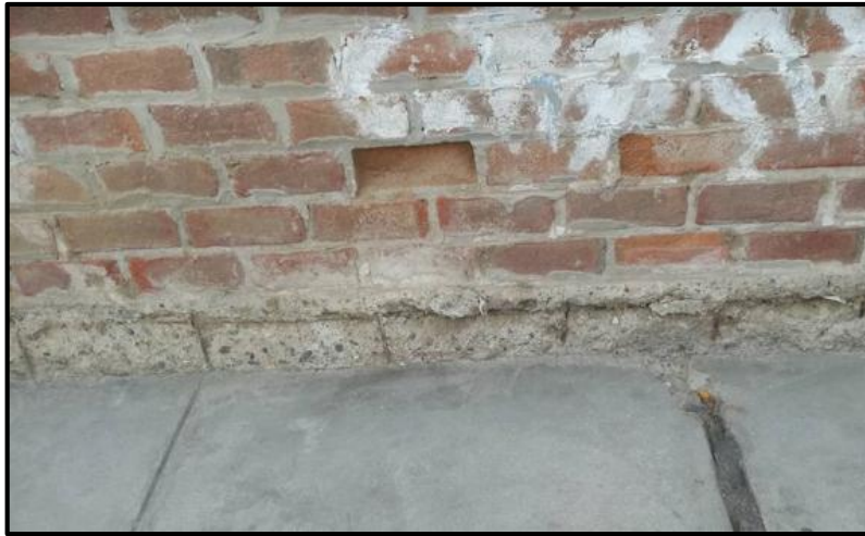
Grafico 10 - Imagen de oxidación y corrosión en muro de albañilería.
