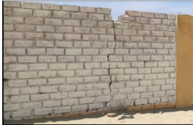
Grafico 6 - Imagen de agrietamiento en muro de albañilería
