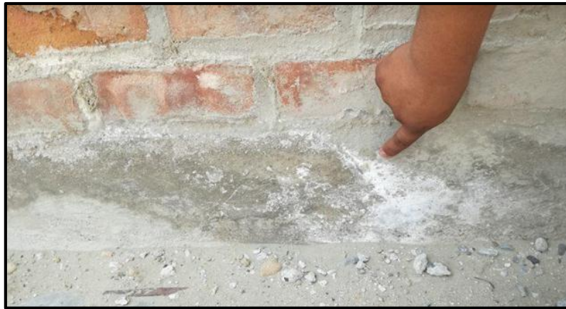
GRAFICO 9 - IMAGEN DE EFLORESCENCIA EN MURO DE ALBAÑILERÍA
