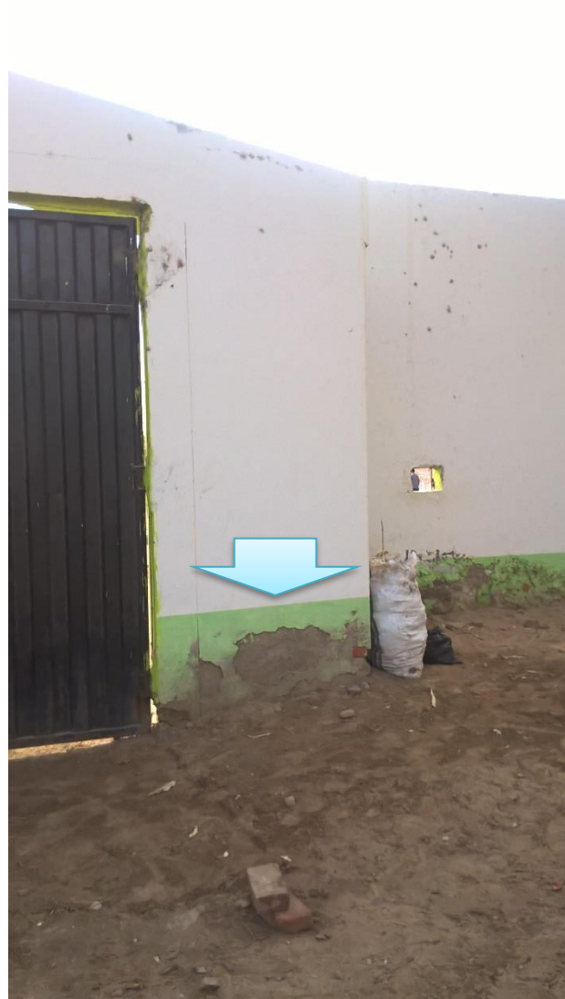
Imagen 05. Muestra 26, desprendimiento del acabado del muro.
