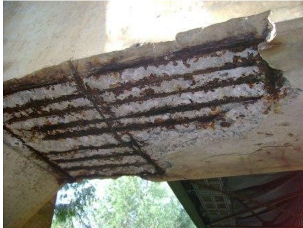
Figura 22: Corrosión del acero.
