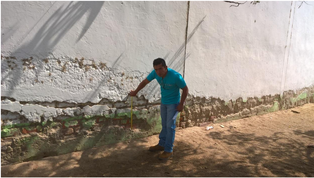
Imagen 04. Muestra 02, desprendimiento del acabado del muro.
