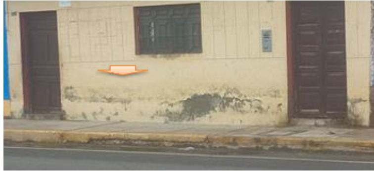
Figura 14: Humedad de filtración.
