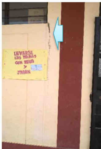
Figura 17: Fisura y grietas.
