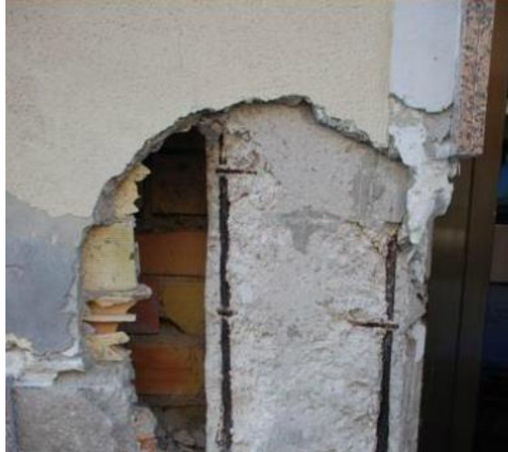
Figura 12: Lesión química, oxidación del acero.
