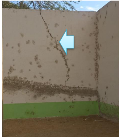
Figura 11: Lesión mecánica, grieta.
