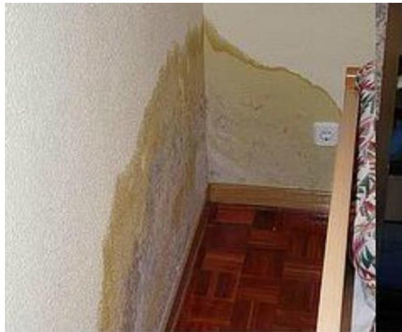
Figura 10: Lesión física, humedad.
