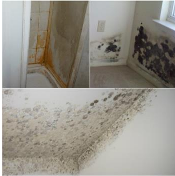
Figura 15: Humedad de condensación.
