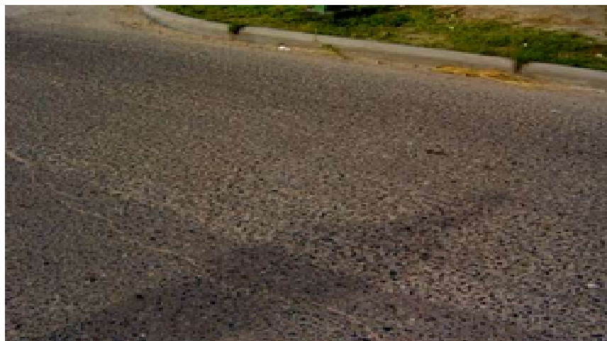
Foto N° 19 Peladura (pérdida de bitumen de cubierta).
