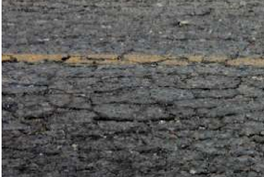
Foto N° 0 5 Piel de cocodrilo ( falla por fatiga )
