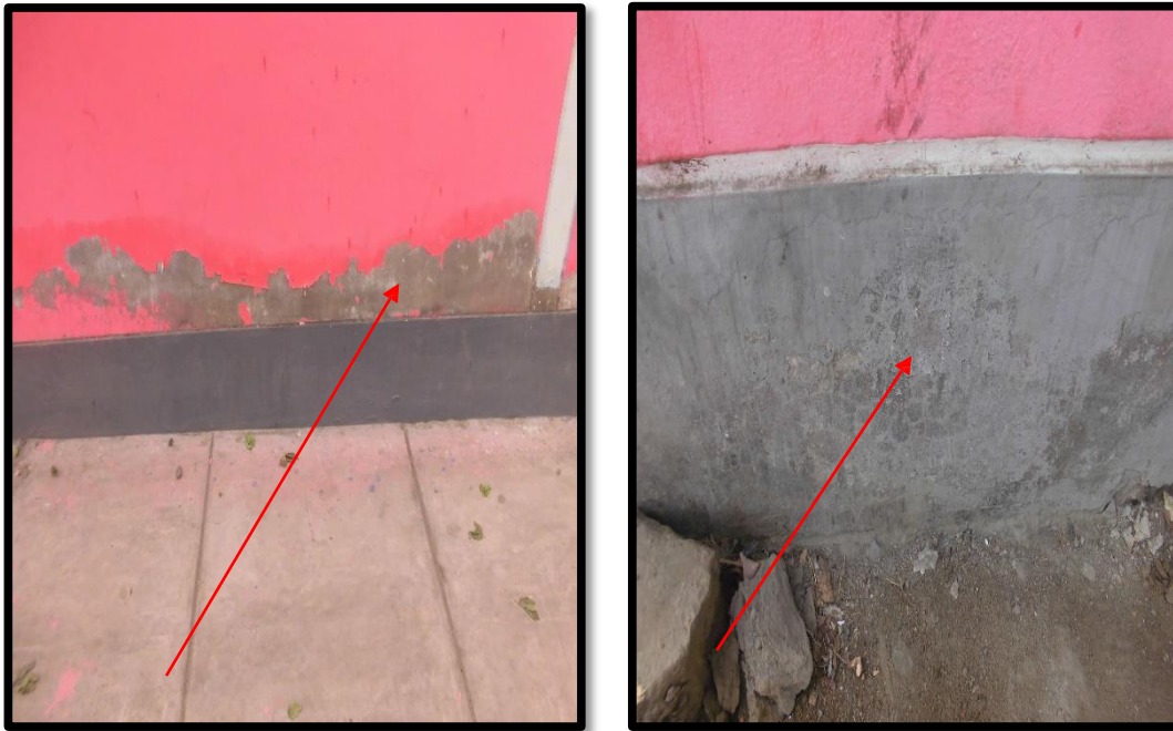
Imagen N° 20y 21: unidades muestrales 1 y 12 en el tramo E-F y A-B, se muestra Desintegración (patología 6) localizada en sobrecimiento.
