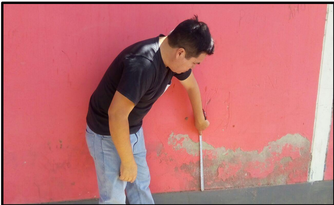
Imagen 06: Muro, sobrecimiento y columna afectados por eflorescencia en unidad muestral 13
