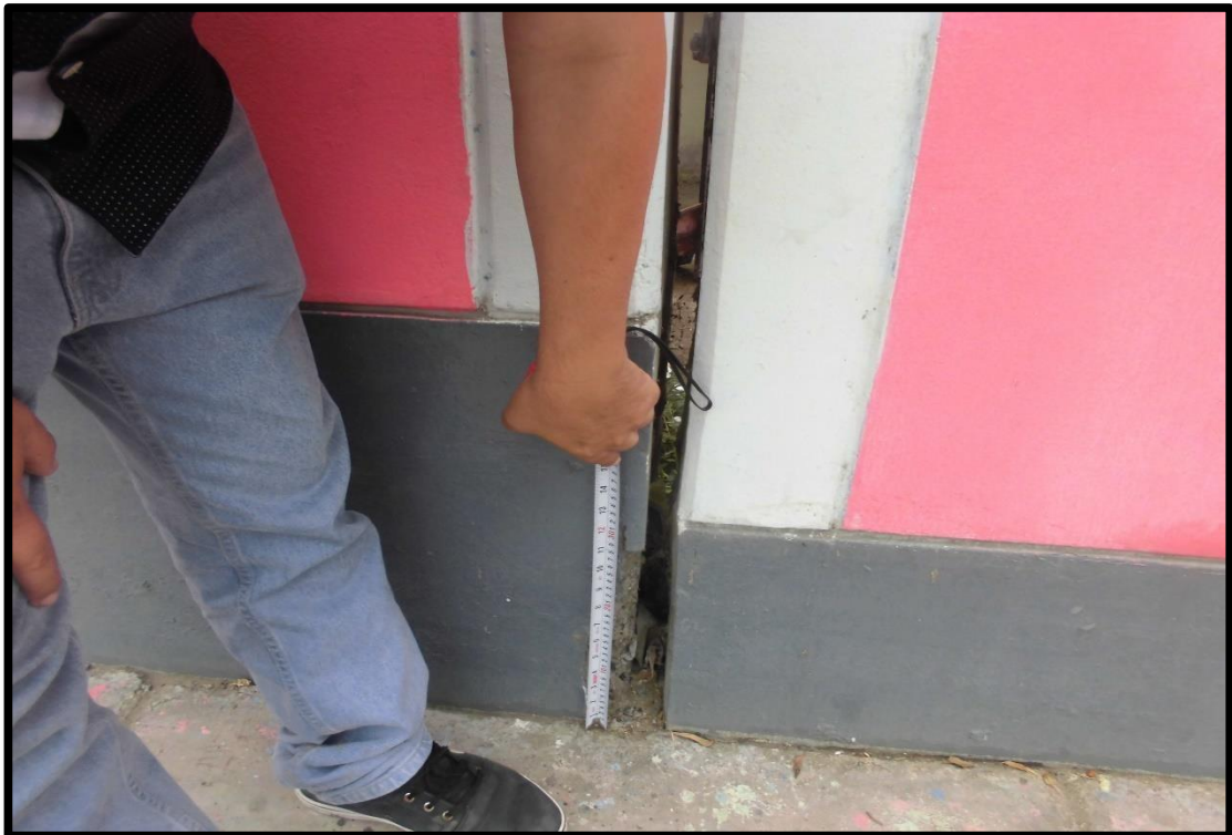
Imagen 07: Columna afectados por desprendimiento en unidad muestral 12.
