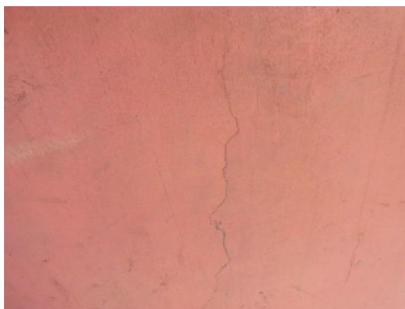
Imagen 05: Fisuras Lineales. Nota. Fuente: propia (2018)
