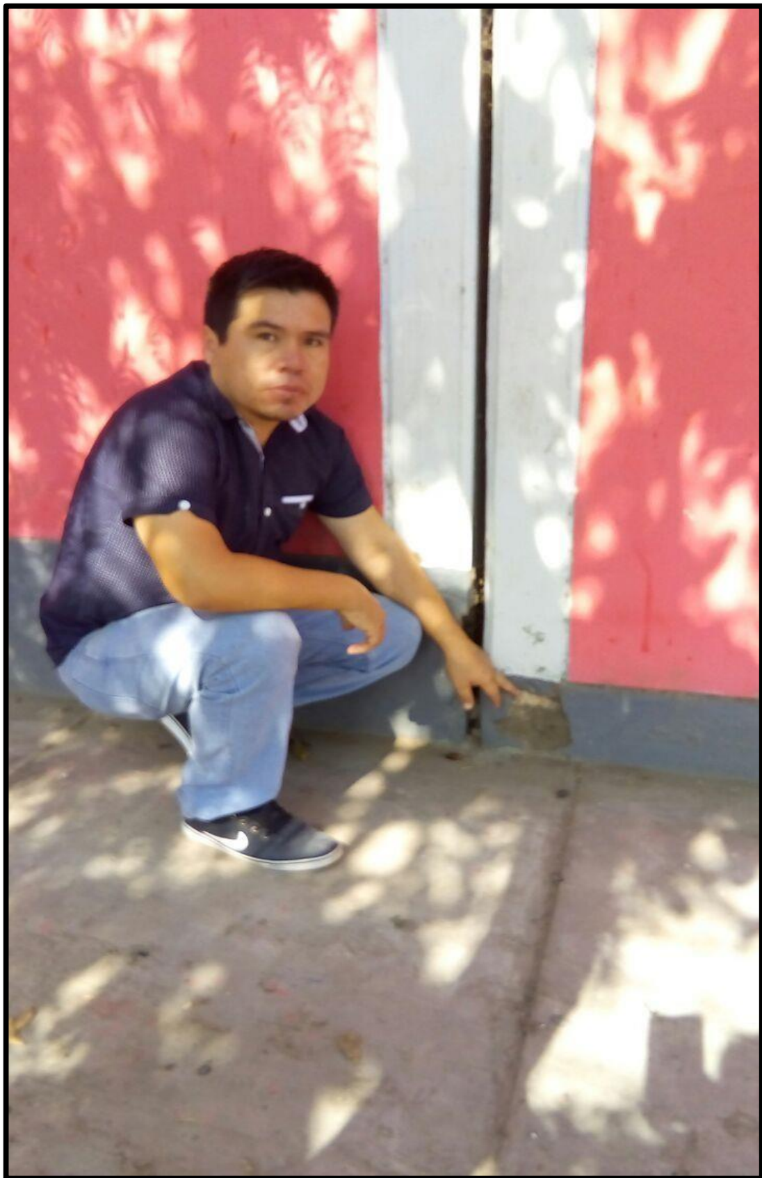
Imagen 09: Sobrecimiento afectados por fisura en unidad muestral 12.
