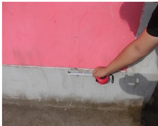
Imagen 2: Descascaramiento, Nota. Fuente: propia (2018)
