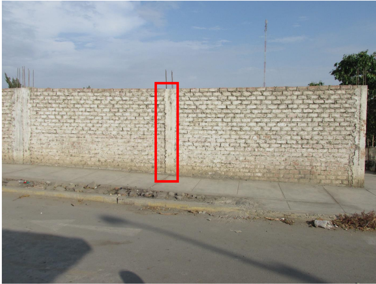
Fotografía 7: Unidad de muestra 10 afectado por la grieta, con un porcentaje de 5.11% y un nivel de severidad SEVERO.
