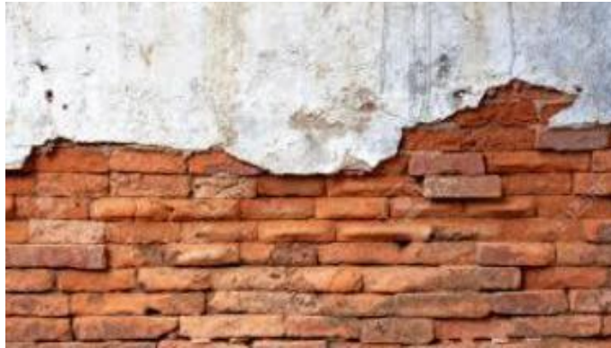
Gráfico 15: Erosión en Muros de Mampostería. Fuente: Enciclopedia Broto. (2016).
