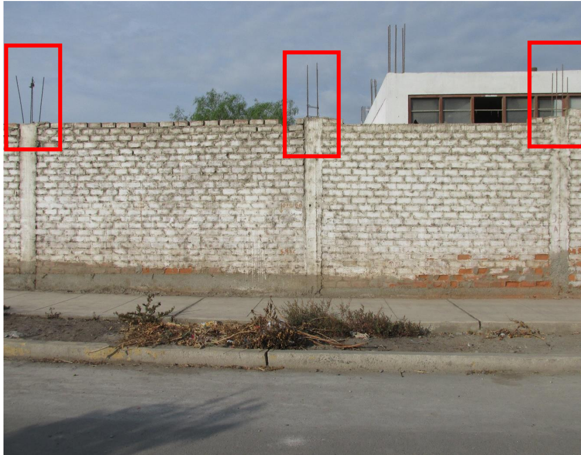
Fotografía 9: Unidad de muestra 12 afectado por la fisura, con un porcentaje de 0.92% y un nivel de severidad MODERADO.
