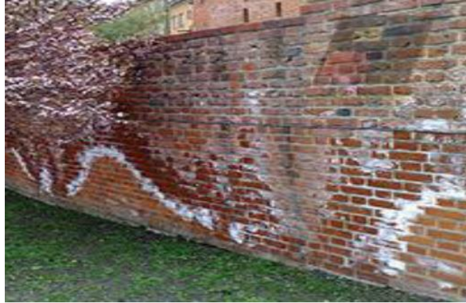
Gráfico 19: Eflorescencia en muro de mampostería. Fuente: Rincón J, Romero M. (2001).
