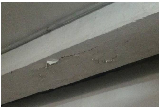
Gráfico 13: Grieta en viga de concreto armado. Fuente: Elaboración Propia. (2016).
