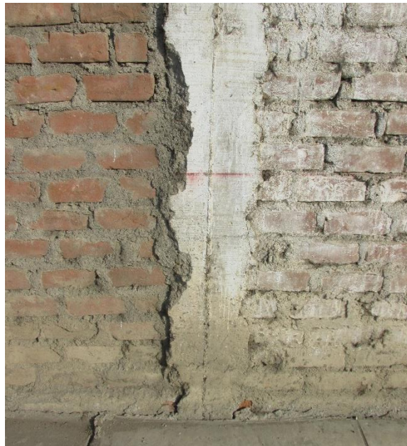
Gráfico 16: Desprendimiento del concreto en columnas.
