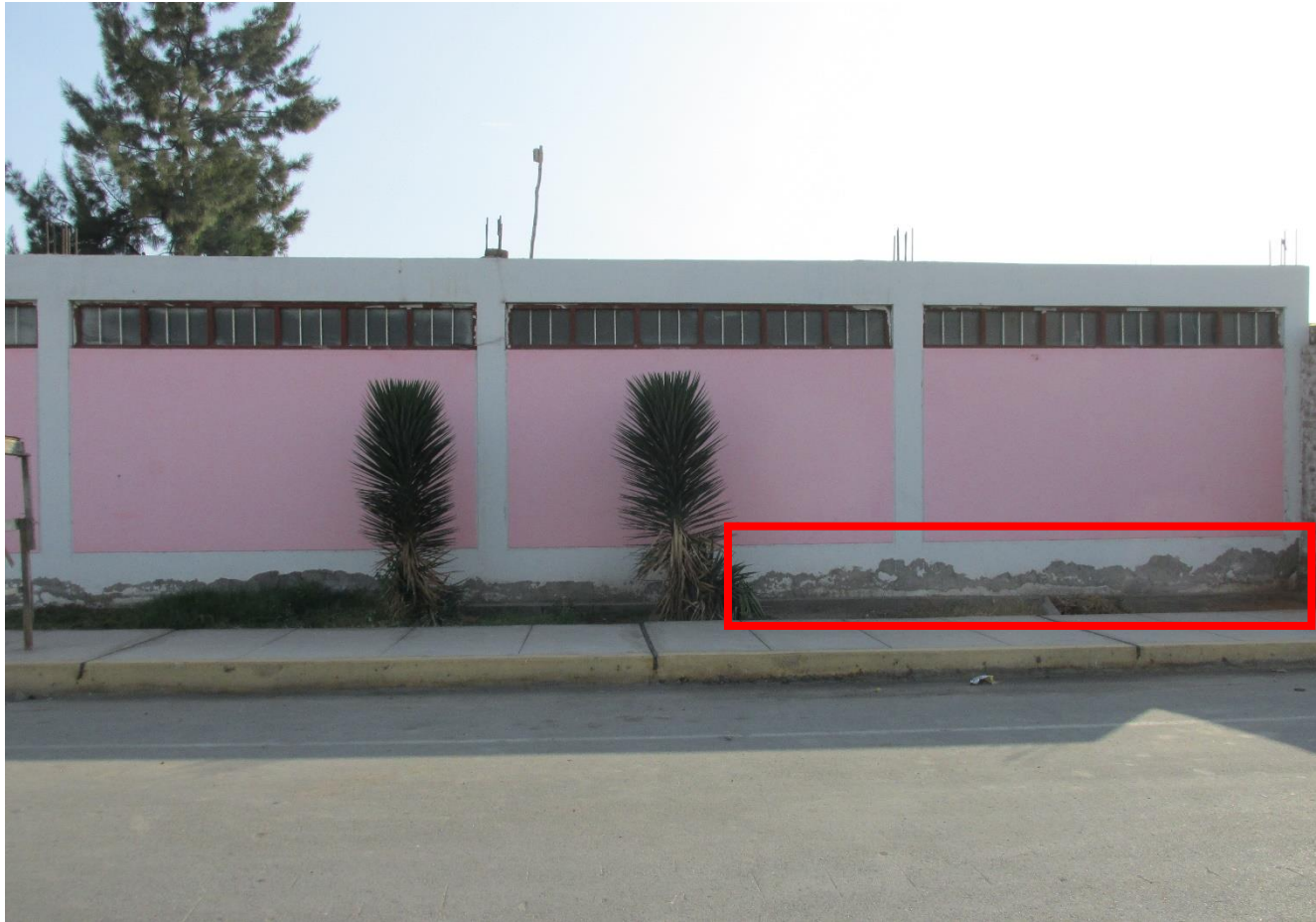
Fotografía 5: Unidad de muestra 03 afectado por eflorescencia, con un porcentaje de 22.60% y un nivel de severidad MODERADO.
