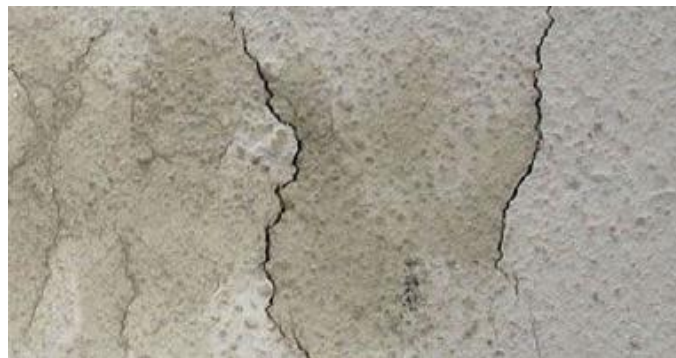
Gráfico 12: Fisuras en Muros de Mampostería. Fuente: Monjo J. (1997).
