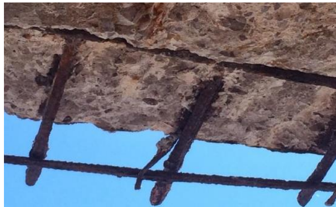
Gráfico 20: Oxidación en vigas de concreto armado. Fuente: Roslin R. (2016).
