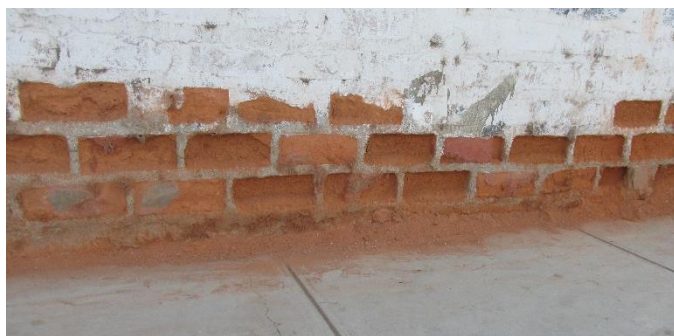
Gráfico 11: Erosión en muros de mampostería. Fuente: Elab. Propia (2018).
