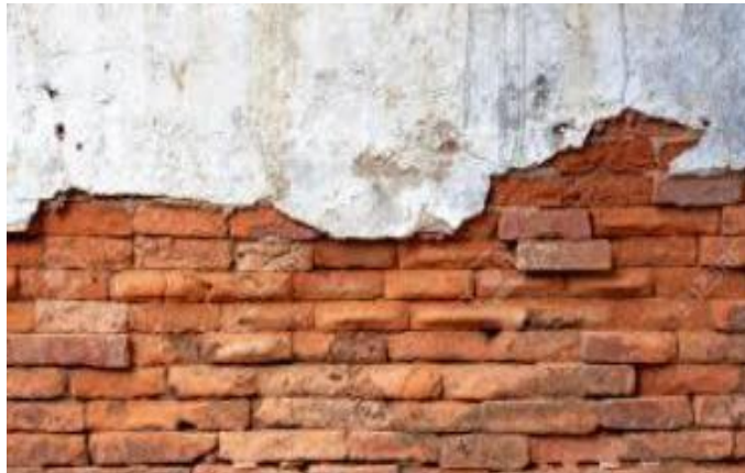
Gráfico 21: Erosión en Muros de Mampostería. Fuente: Enciclopedia Broto. (2016).
