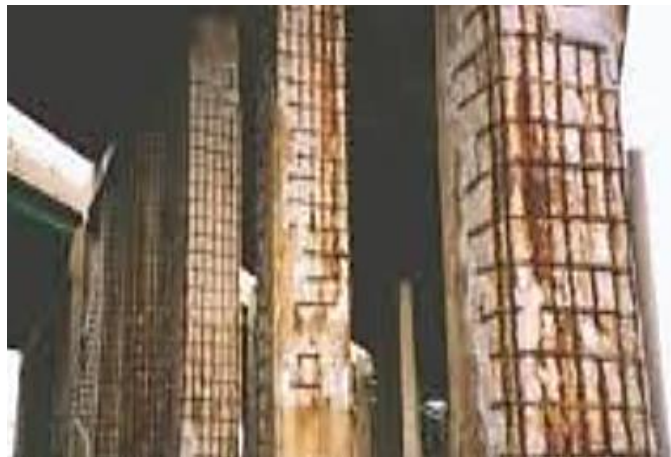
Gráfico 18: Corrosión del acero en una columna. Fuente: León A. (2015).
