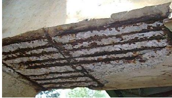
Gráfico 17: Corrosión del acero en una viga. Fuente: León A. (2015).
