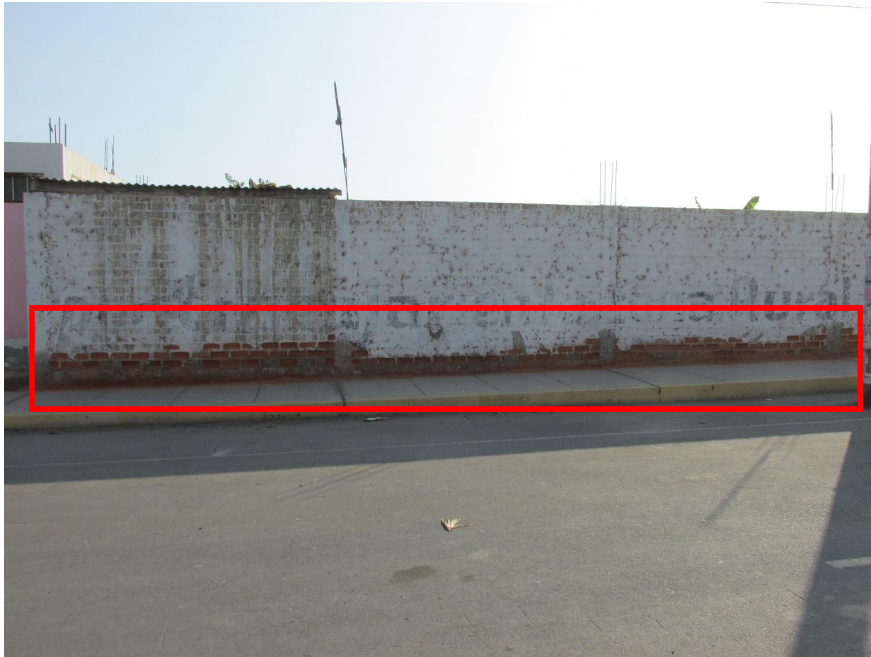
Fotografía 4: Unidad de muestra 04 afectado por erosión, con un porcentaje de 10.38% y un nivel de severidad SEVERO.
