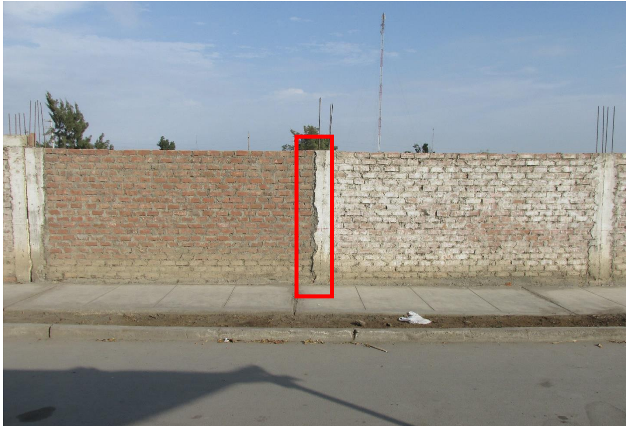
Fotografía 6: Unidad de muestra 09 afectado por el desprendimiento, con un porcentaje de 15.46% y un nivel de severidad MODERADO.
