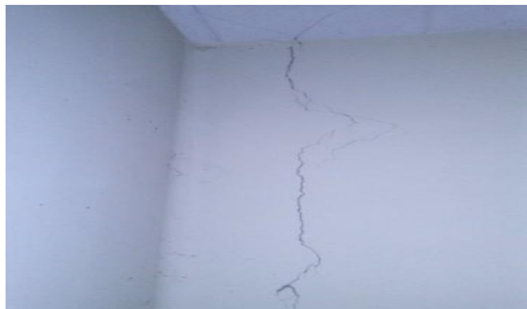
Figura 14. Grieta en Muro
