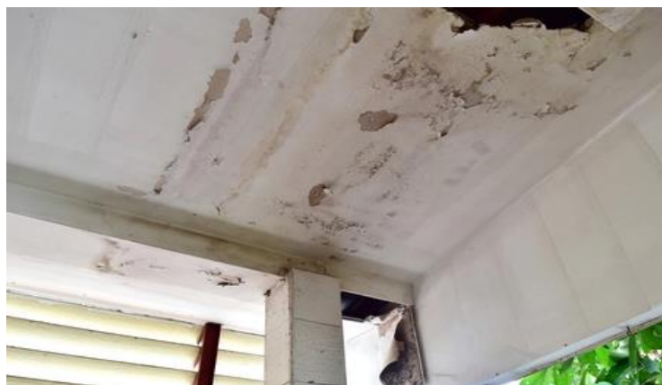
Figura 11. Corrosión en losa aligerada
