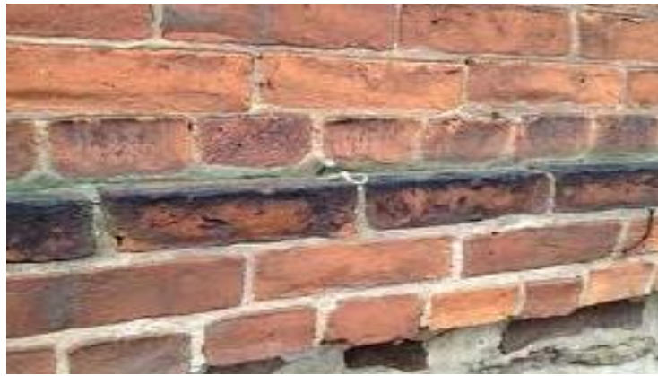
Figura 13. Erosión química en muro de albañilería
