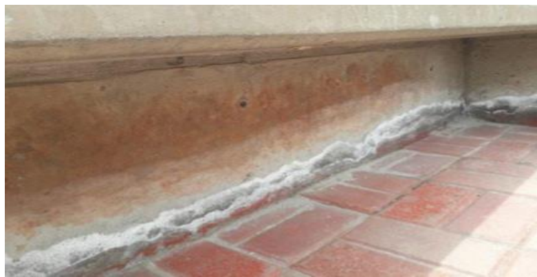
Figura 15. Eflorescencia en Muro
