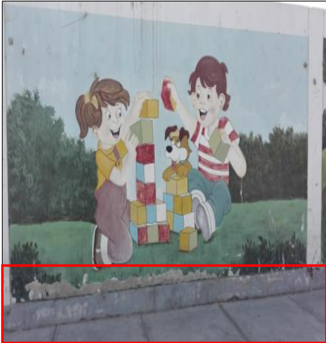
Foto N°04.- Se aprecia en la fotografía de la unidad muestral N°12 que en la parte del muro y el sobrecimiento hay humedad con pequeñas manchas cristalinas.
