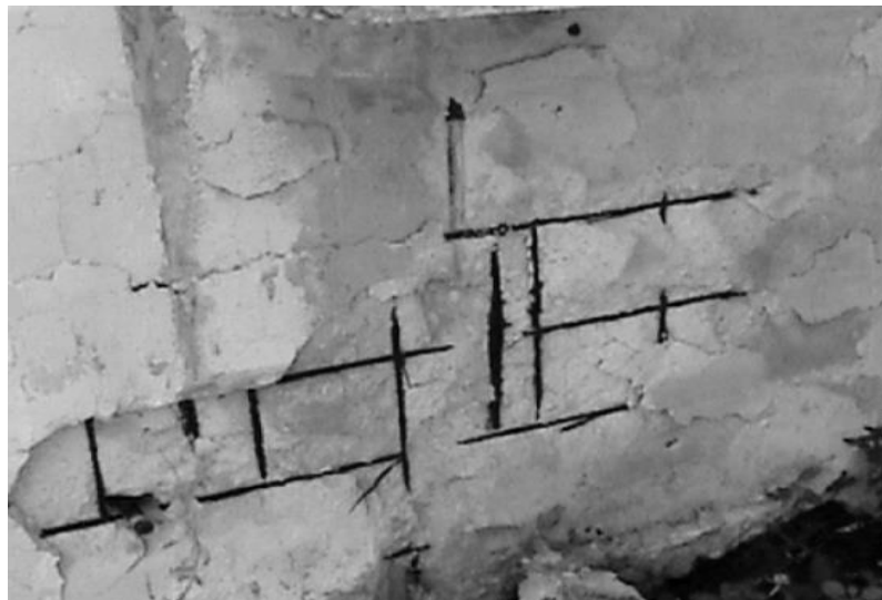
Figura 12. Corrosión en Placa de Concreto armado
