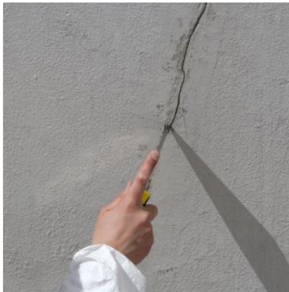
Figura 16. Fisura en mortero
