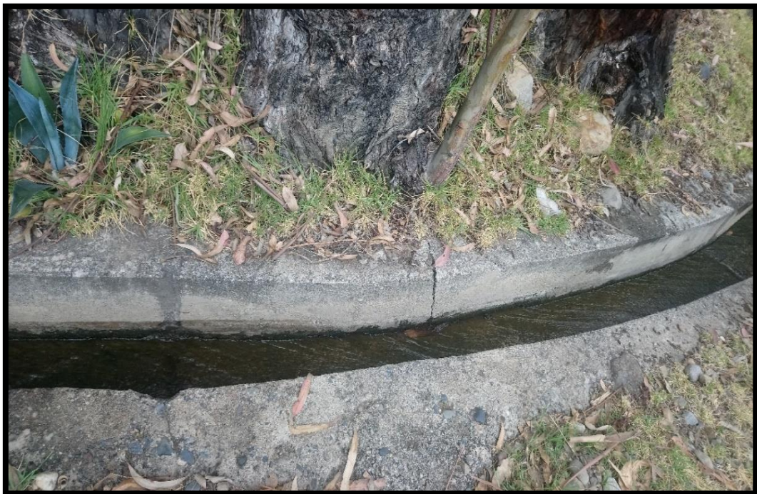
Foto 04. Se observa la presencia de grietas en los muros del canal.
