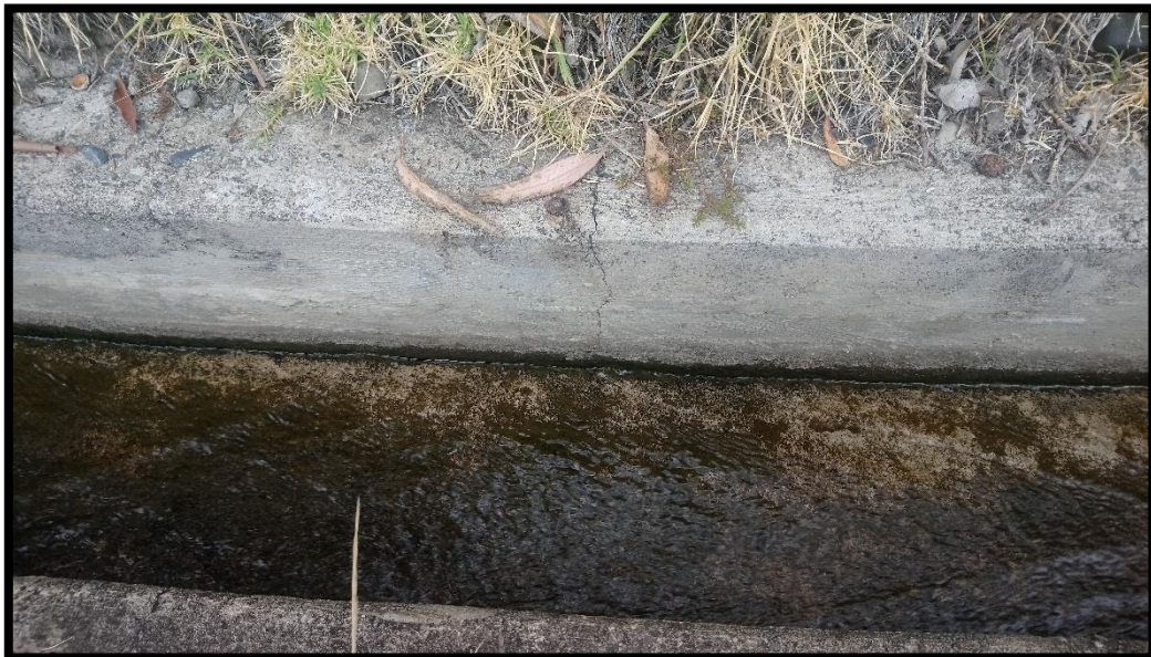
Foto 06. Presencia de fisuras en el muro del canal.
