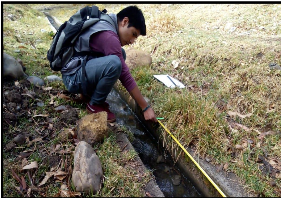
Foto 02. Se observa la presencia de musgos en el muro del canal.
