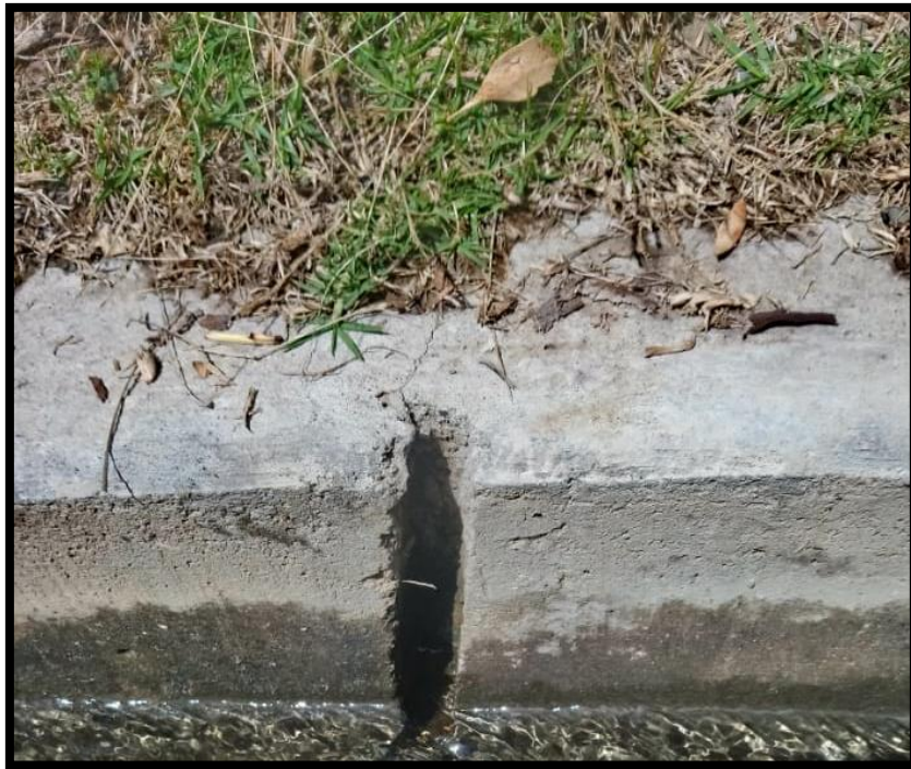
Foto 05: Se observa la carencia del sello de junta en el muro del canal.
