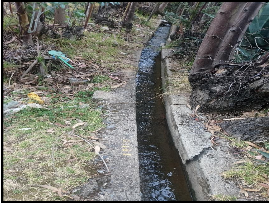
Foto 01: Se observa la presencia de fracturas en el muro del canal.
