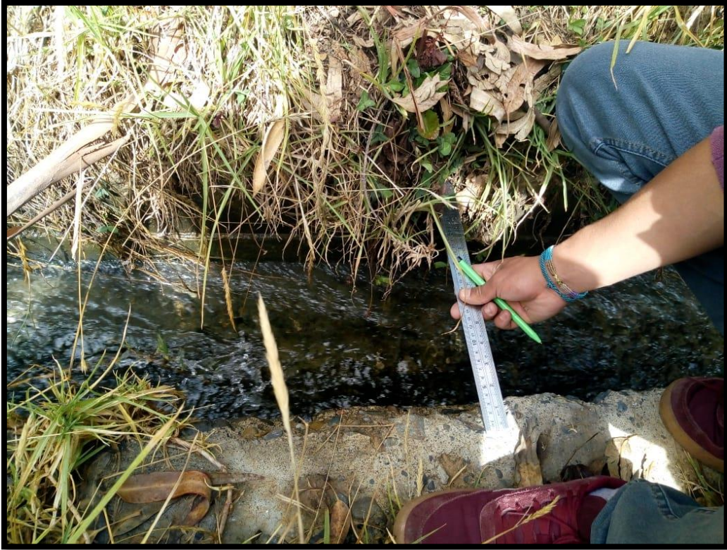
Foto 03: Se observa la presencia de erosión en el muro del canal.
