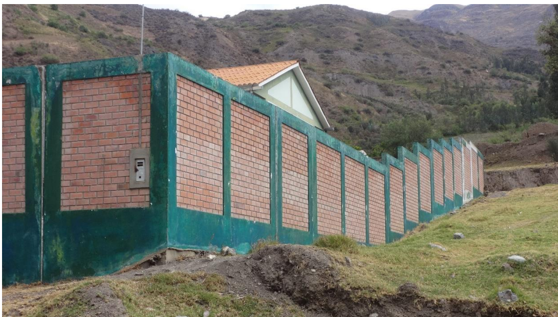
Anexo N° 02. Vista Lateral Derecho de los Elementos Estructurales del Cerco Perimétrico.
