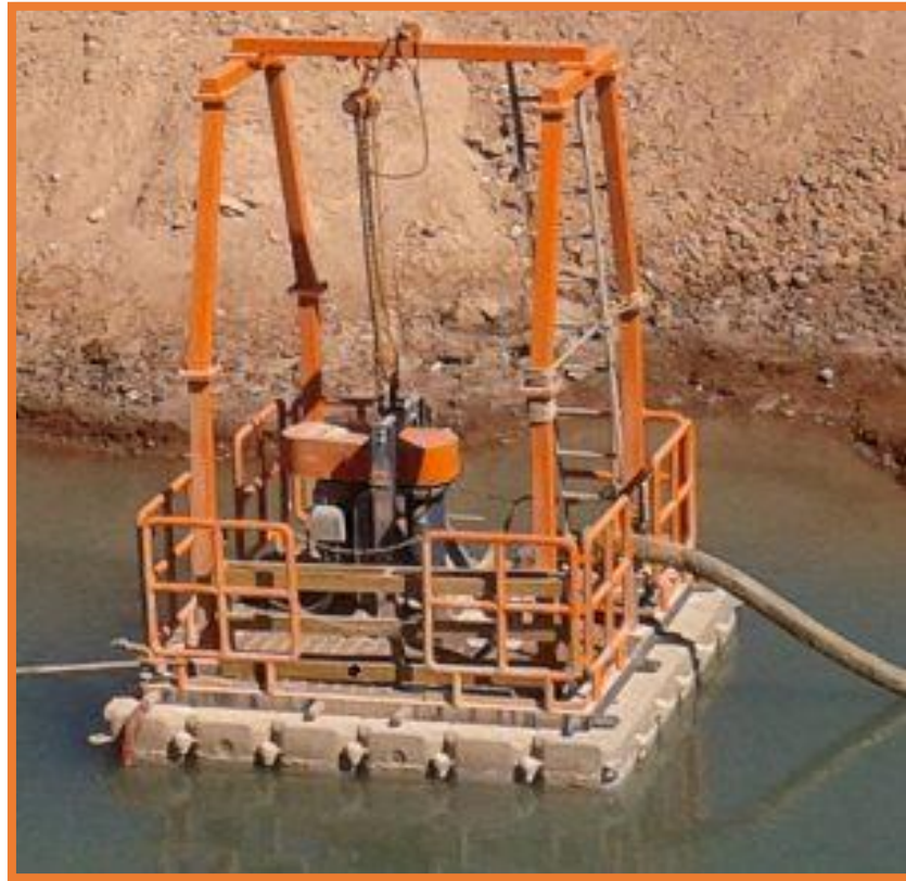
Gráfico 12: Equipo de bombas en balsa flotante
