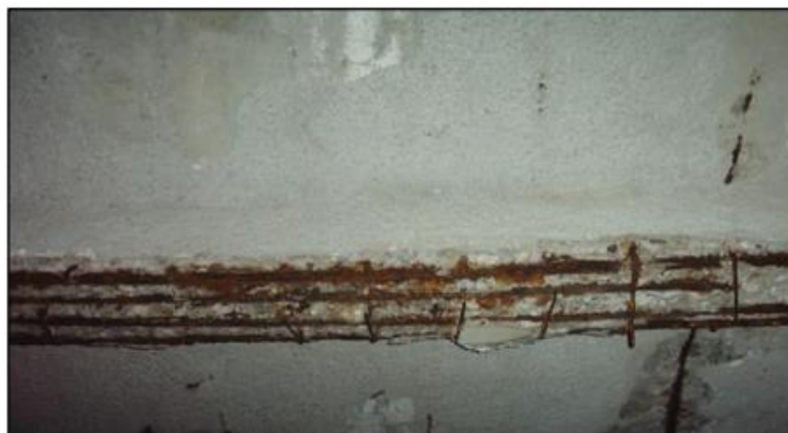
Figura 14. Corrosión en viga peraltada Nota. Fuente: Broto C. (24)
