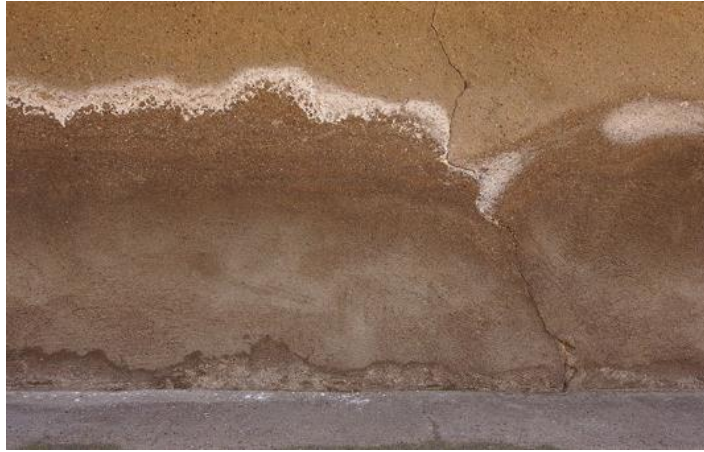
Figura 13. Eflorescencia en mortero Nota. Fuente: Carreño y Serrano (31)
