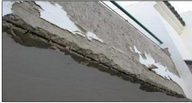
Figura 9. Patología en viga Nota. Fuente: Carreño (21)
