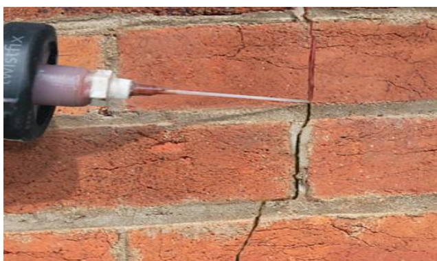
Figura 12. Grieta Nota. Fuente: Broto (24)
