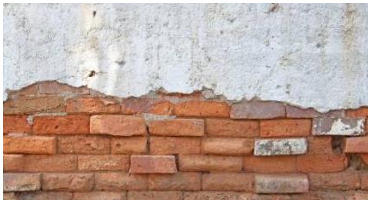
Figura 10. Erosión en muro confinado Nota. Fuente: Broto (24)
