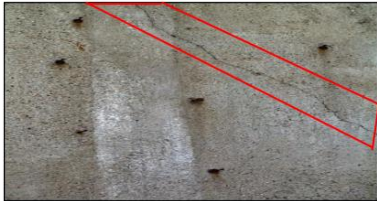
Figura 11. Fisura en concreto
