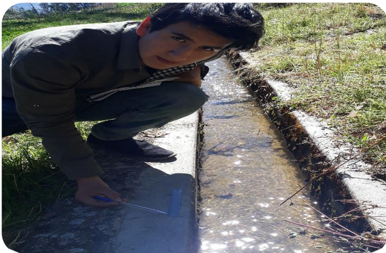
Fotografía 03: toma de datos de las patologías.
