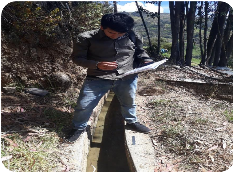
Fotografía 05: Realizando las mediciones de las patologías.
