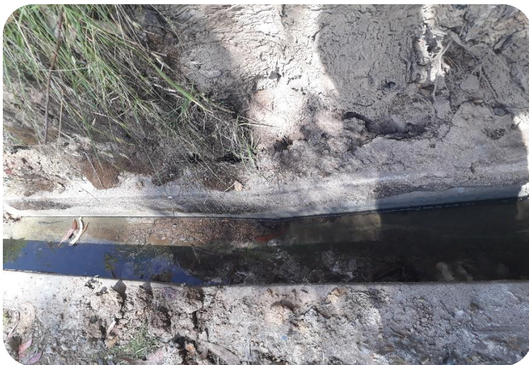
Fotografía 06: identificando de la patología del canal, sedimentación.
