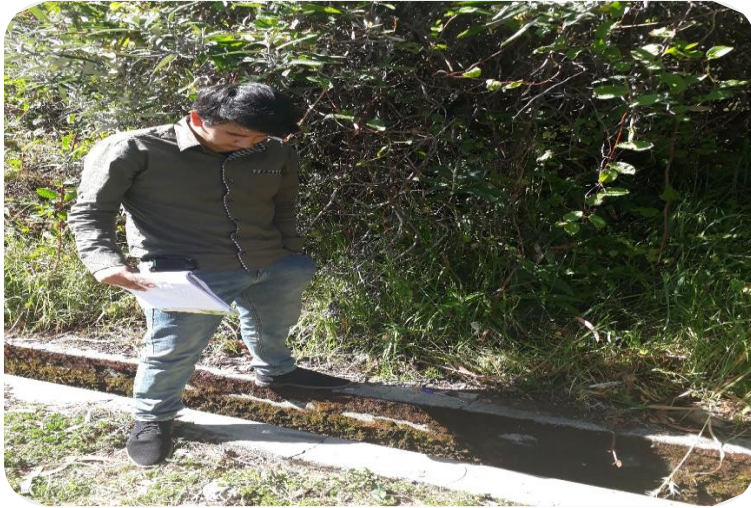
Fotografía 07: presencia de musgo en los márgenes derecho e izquierdo del canal.
