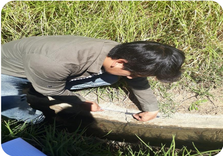
Fotografía 08: realizando la medición de la patología grieta.
