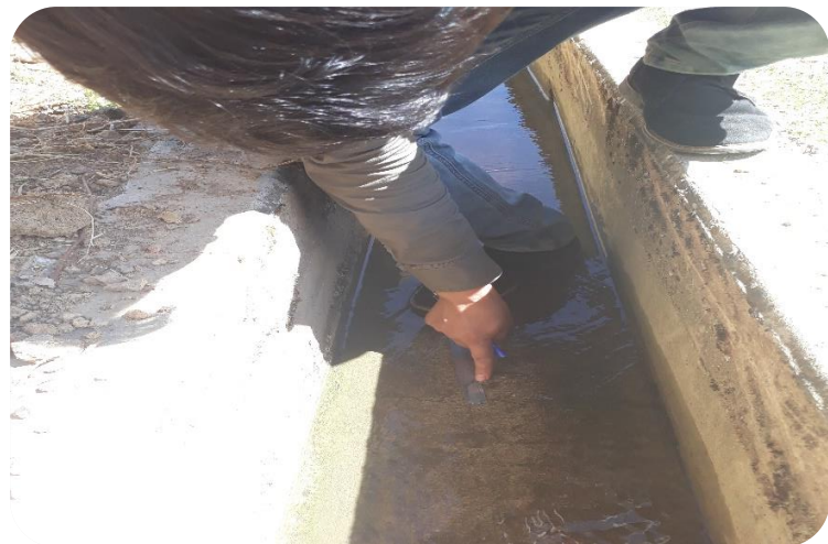
Fotografía 09: identificación de la patología fisura en el fondo del canal.
